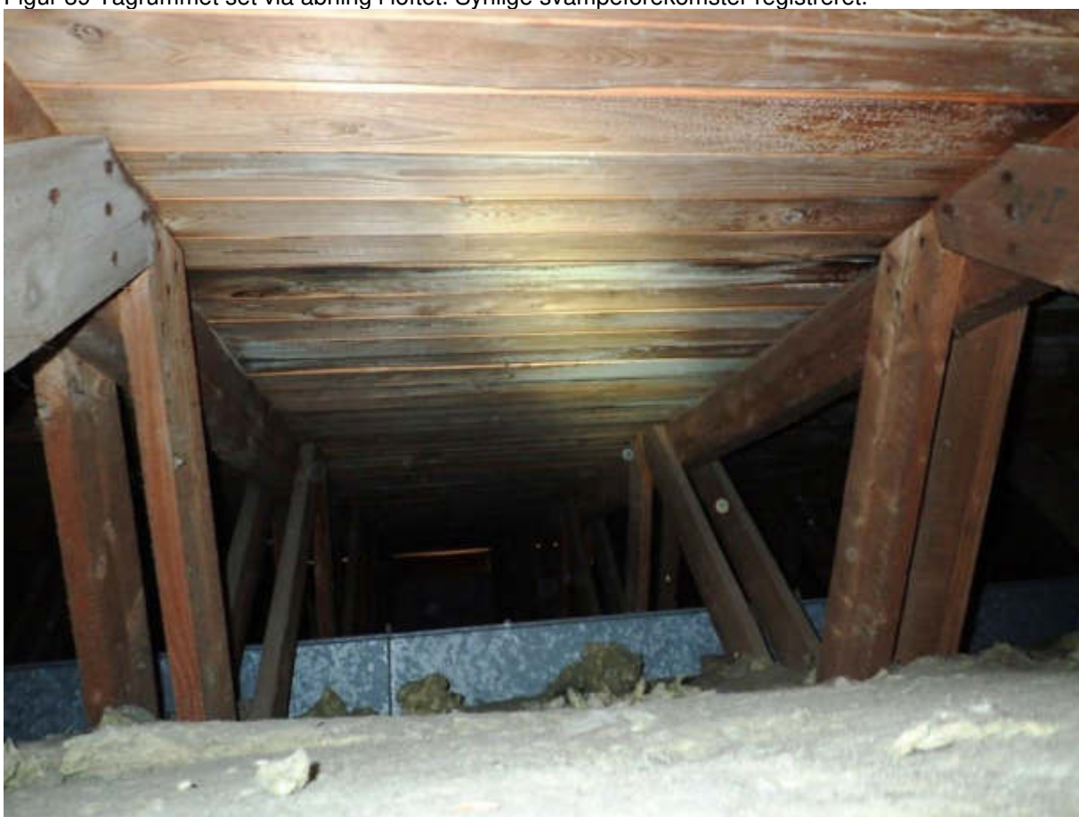
Figur 40 Tagrummet. Massive synlige forekomster af skimmelsvampevækst registreret på tagbrædder.
