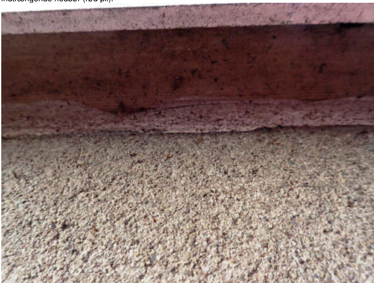
Figur 4 Mellemlbygning med kontorer. Facade mod vest. Der blev ikke registreret luftspalte /ventilation bag facadeplader.
