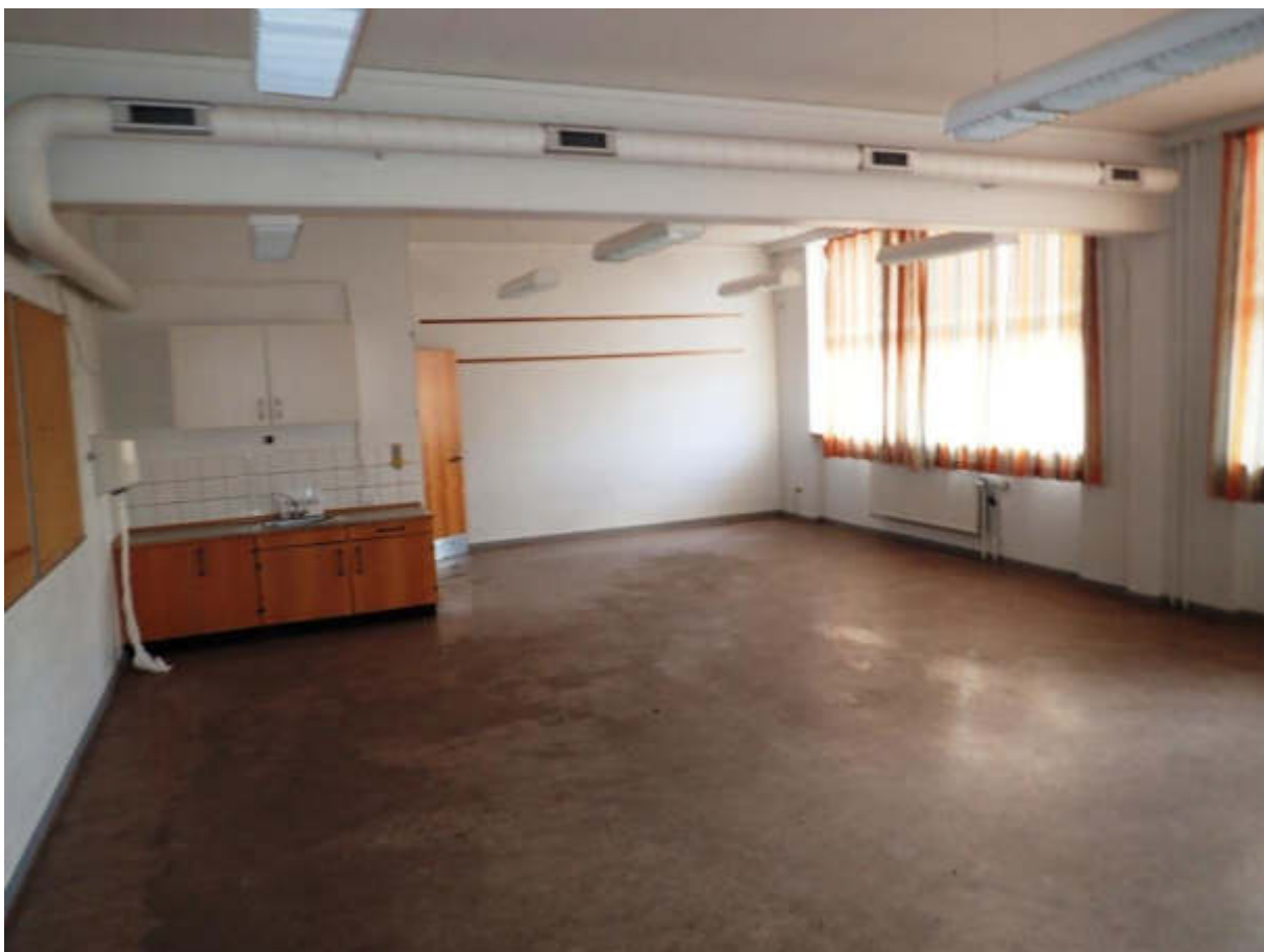
Figur 124 Stueetagen. Slidte gulvbelægninger, tæt på udtjent.
