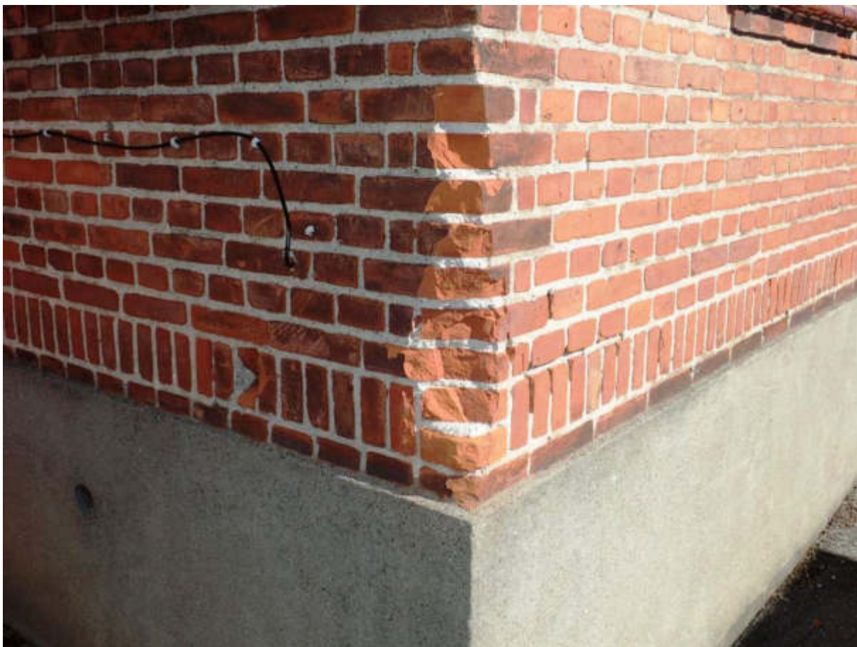
Figur 15 Bygningshjørne mod sydvest. Skade på murværk.
