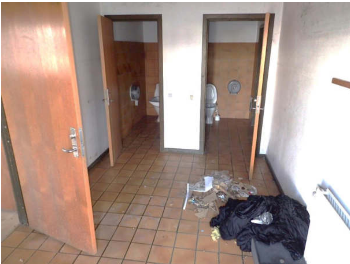
Figur 18 Vindfang mod vest. Opfugtede konstruktioner samt massive synlige forekomster af skimmelsvampevækst.
