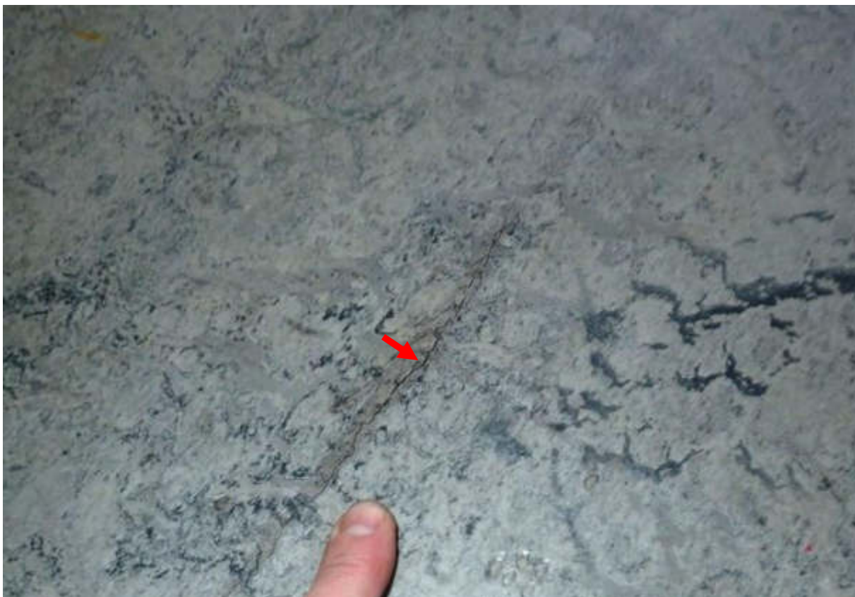
Figur 45 1. sal, klasseværelse. Revne i gulvbelægning (rød pil).
