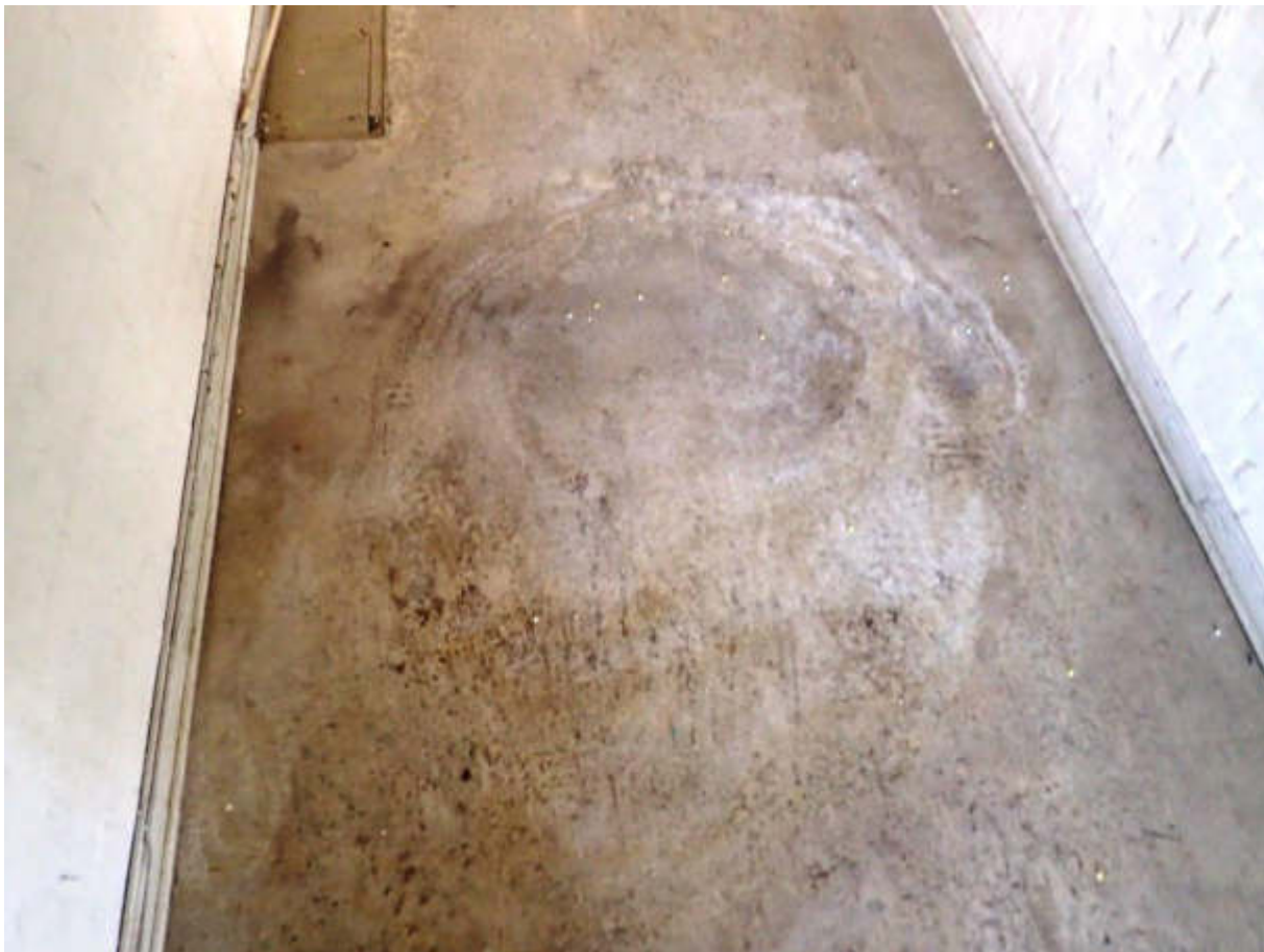
Figur 23 Gangen. Fugtigt og skjoldet gulv indikerer utæt tag.
