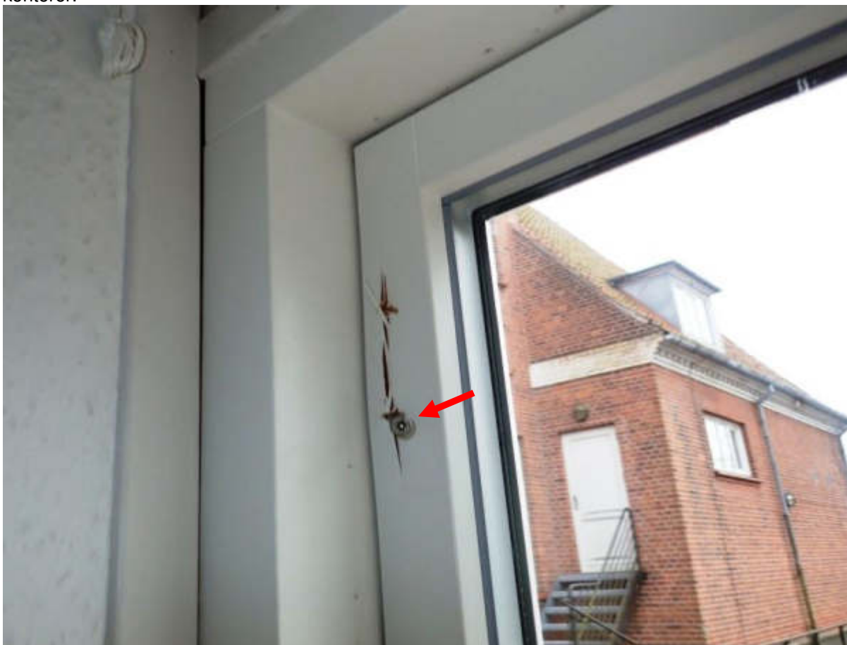
Figur 22 Mellembygning med kontorer. Vindue blokeret med skrue (rød pil).
