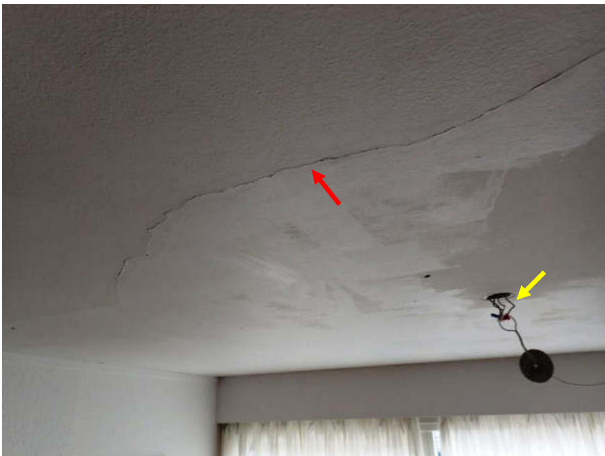
Figur 26 Mellemlbygning med kontorer. Revnet loft (rød pil). Løsthængende elinstallation med berøringsfare (gul pil).
