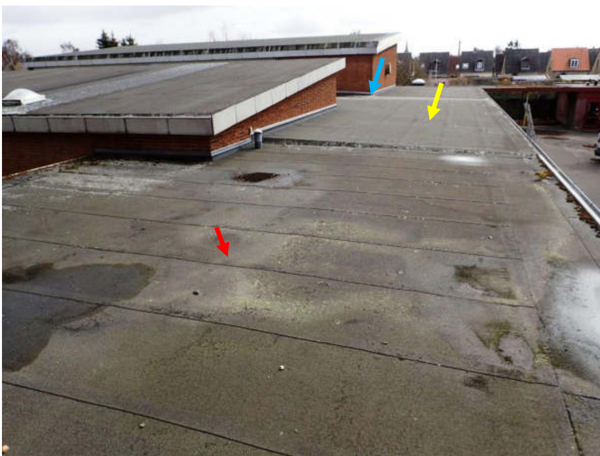
Figur 2 Tagfladen set fra nord. Tagpap af ældre dato (rød pil) samt tagpap af nyere dato (gul pil). Indvendigt blev registreret indikation på indtrængende nedbør i området ved blå pil.
