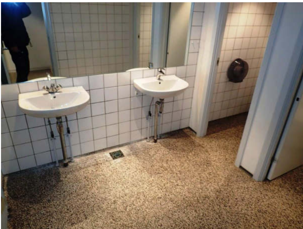
Figur 30 Toiletter. Ingen brugsvand registreret.
