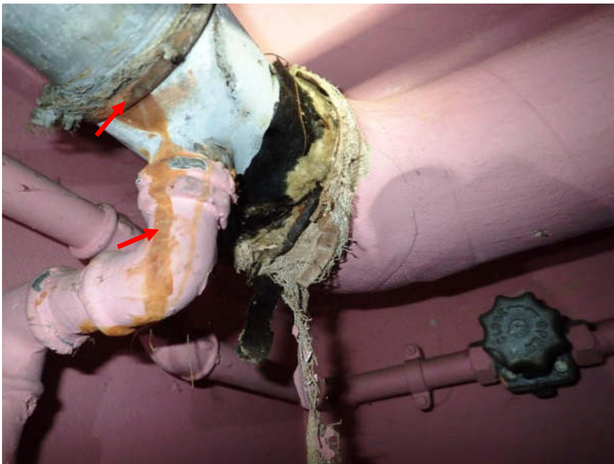
Figur 43 Kælderen. Rørisolering med skade. Bemærk indikation på utæthed (røde pile).
