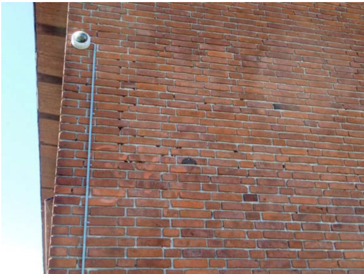
Figur 15 Facade mod øst. Partielt manglende mørtelfuger samt indikationer på angreb af murbier.
