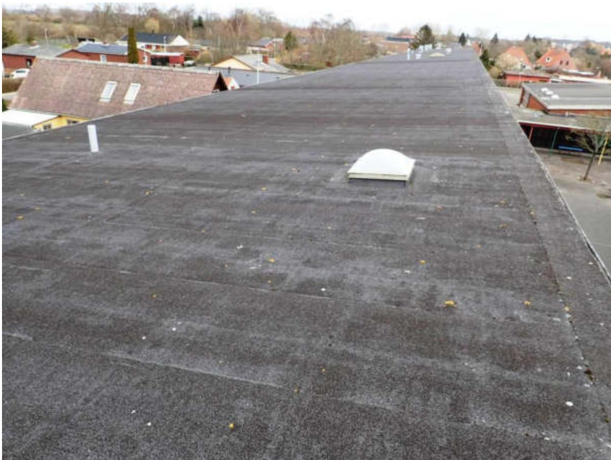
Figur 65 Taget. Tagdækning med tagpap af ældre dato og begrænset restlevetid.
