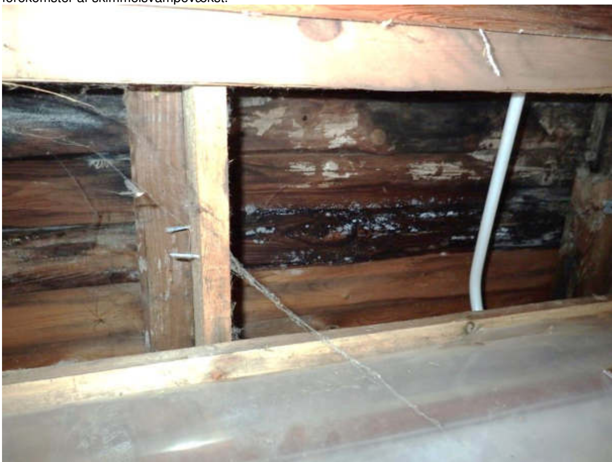
Figur 20 Skadet loft- og tagkonstruktion med opfugtede konstruktioner samt massive synlige forekomster af svampevækst.
