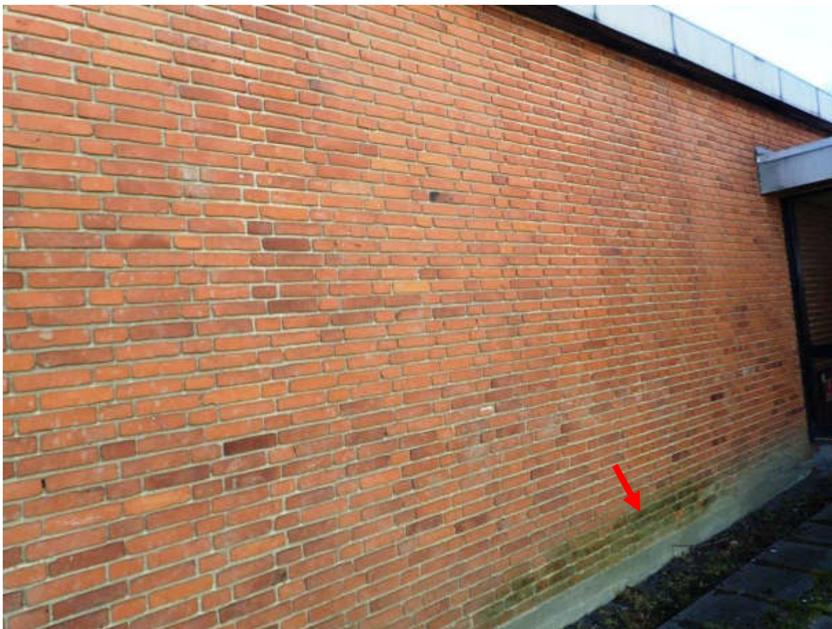
Figur 15 Facade mod nord. Fugtskjolder og alger på murværk indikerer at tagrende hyppigt løber over (rød pil).
