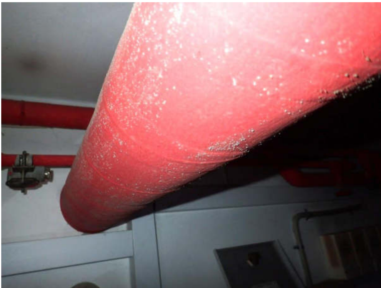
Figur 37 Kontor i kælderen. Synlige forekomster af, hvad der vurderes at være skimmelsvampevækst på tekniske installationer.
