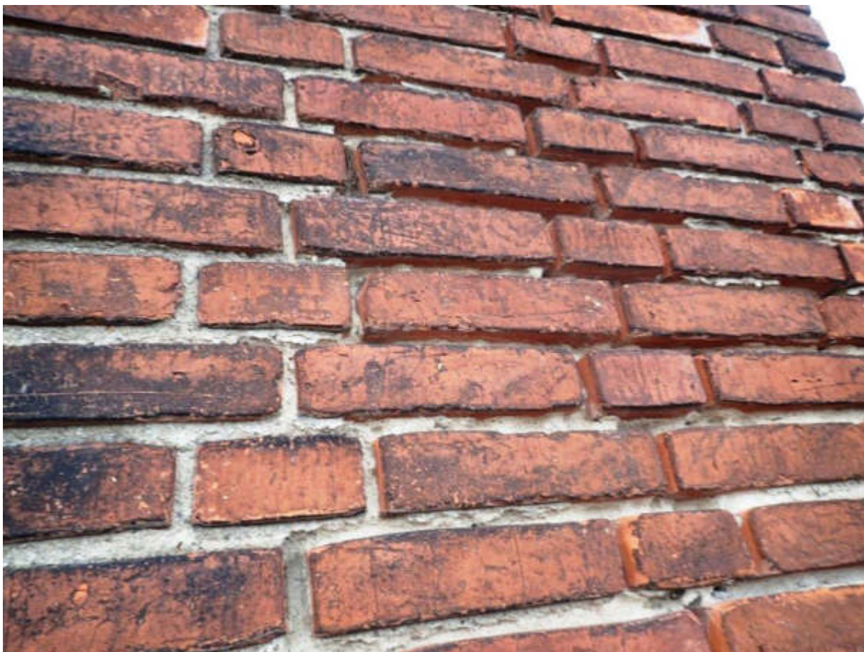
Figur 73 Skorsten med porøse og manglende mørtelfuger.
