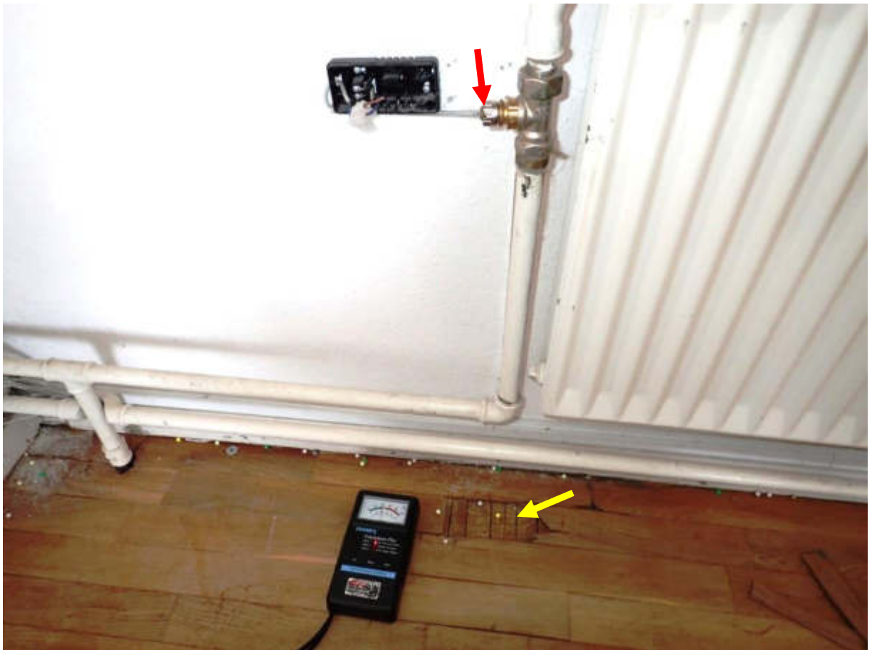
Figur 19 Mellembygning med kontorer. I trægulve blev registreret enkelte skader (rød pil) samt let forhøjede fugtniveauer. Bemærk demonteret termostatstyring (rød pil).
