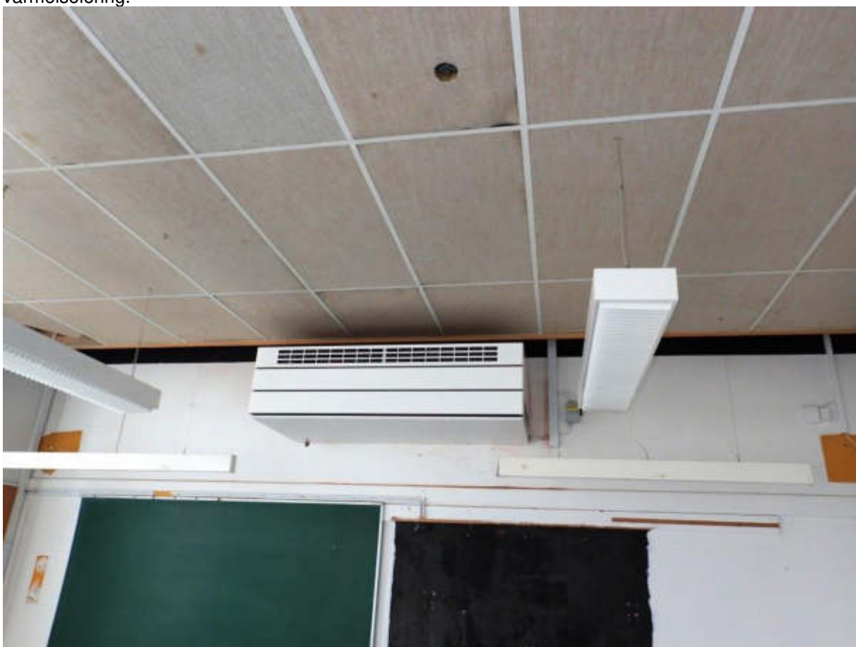
Figur 44 1.sal. Klasseværelse mod sydvest. Ventilationsaggregat registreret. Bemærk loftplader af ældre dato med hul.
