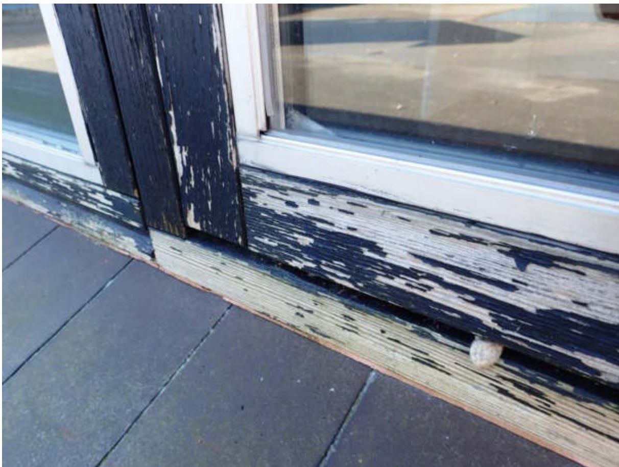
Figur 11 Facade mod nord /skolegården. Vinduer med ringe vedligehold og begyndende skader.
