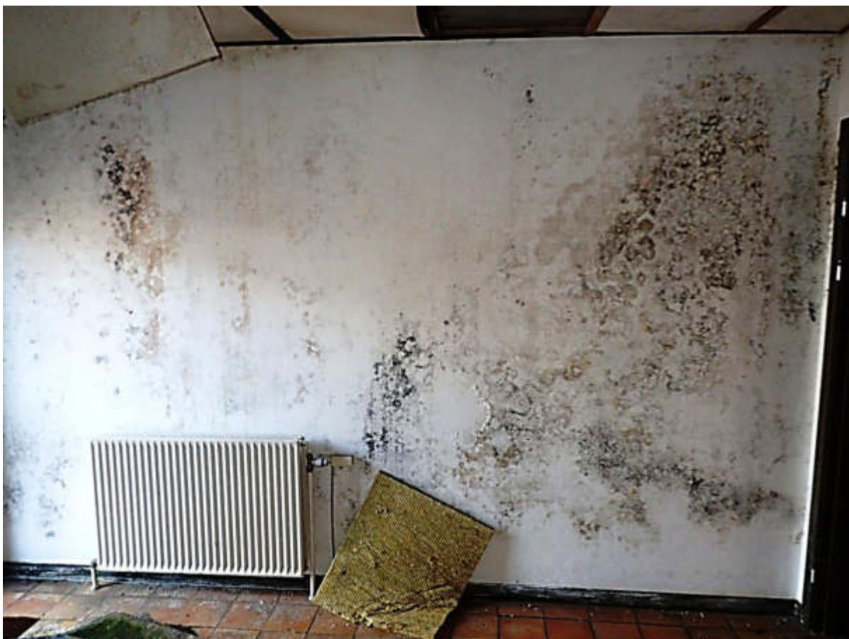
Figur 36 Vindfang mod øst. Opfugtede konstruktioner med massive synlige forekomster af skimmelsvampevækst.
