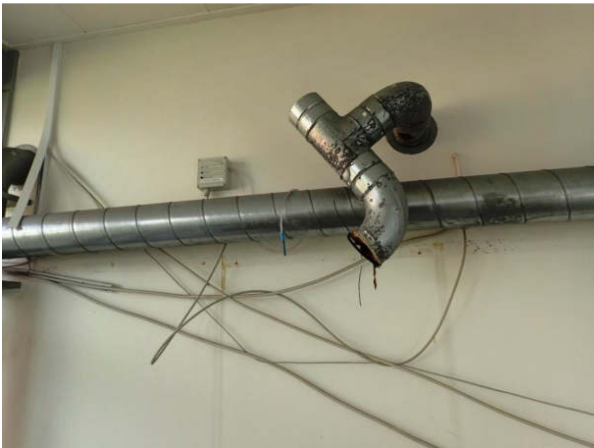
Figur 35 Undervisningslokale mod øst. Løse ledninger og tvivlsomme installationer.
