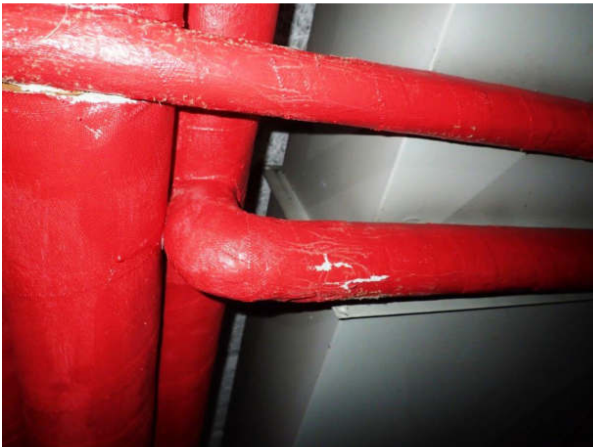
Figur 41 Kælderen. Rør med trykket /skadet rørisolering.
