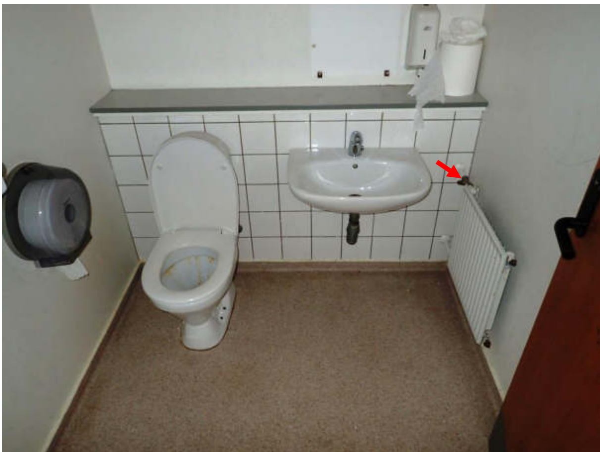
Figur 118 Toilet. Termostatstyring på radiator demonteret (rød pil).
