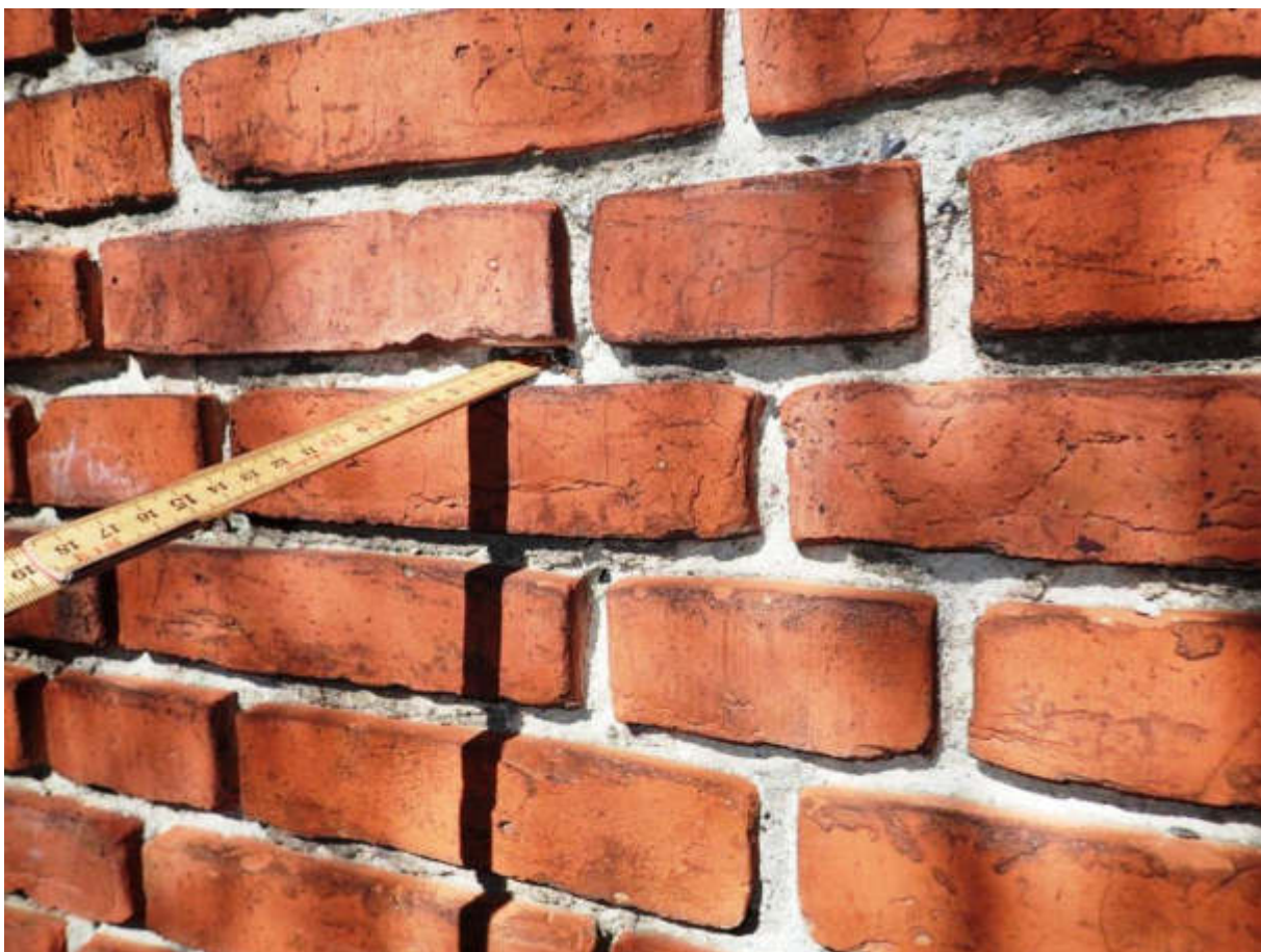
Figur 14 Murværk udført med tilbagelagte mørtelfuger. Flere steder blev partielt registreret manglende mørtelfuger, mindre skader samt indikationer på angreb af murbier.
