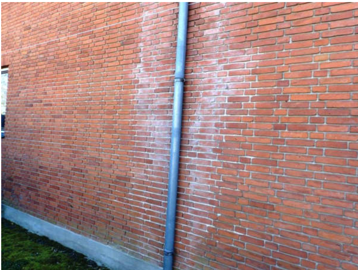
Figur 81 Facade mod nord. Skjolder på murværk ved nedløbsrør indikerer at nedløb og tagrender ikke er funktionsdygtige.
