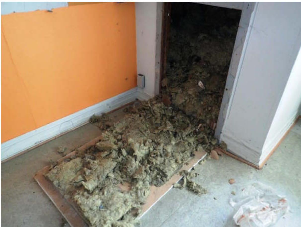
Figur 43 1.sal. Klasseværelse mod nordvest. Åbent mellem lokale og skunkrum. Skadet varmeisolering.
