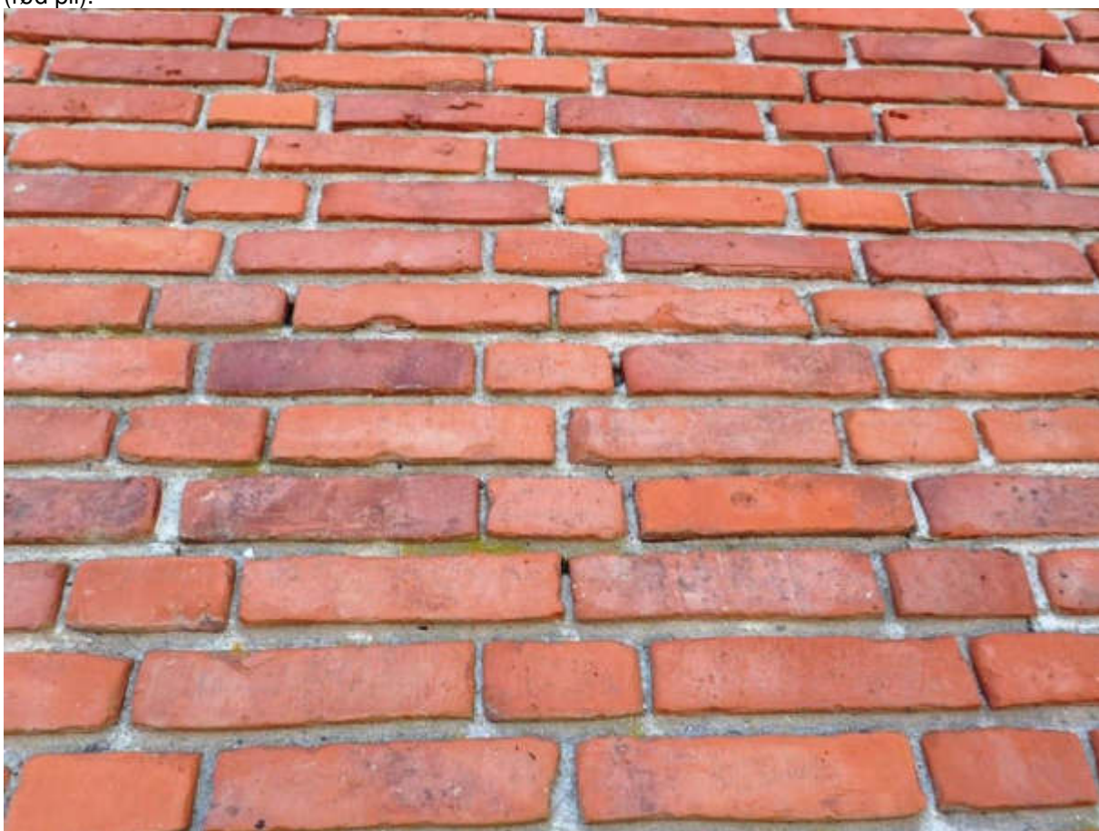
Figur 16 Ydervæg mod øst. Murværk med manglende mørtelfuger flere steder.
