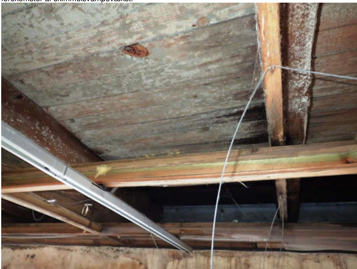
Figur 32 Kantinen. Skadet loft- og tagkonstruktion med opfugtede konstruktioner samt massive synlige forekomster af skimmelsvampevækst.
