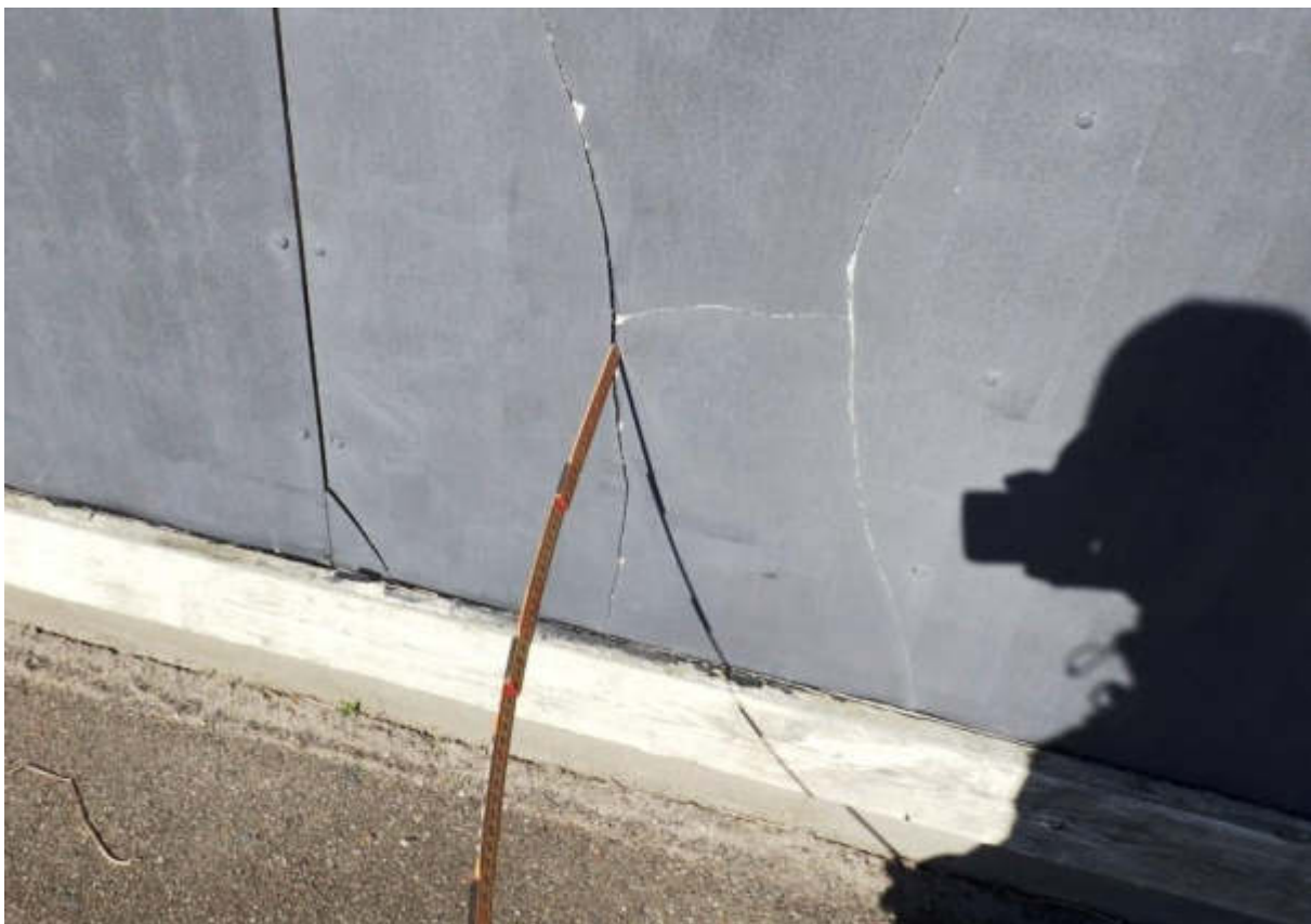
Figur 77 Facade mod syd. Flere steder blev registreret fibercementplader med brud /skader.
