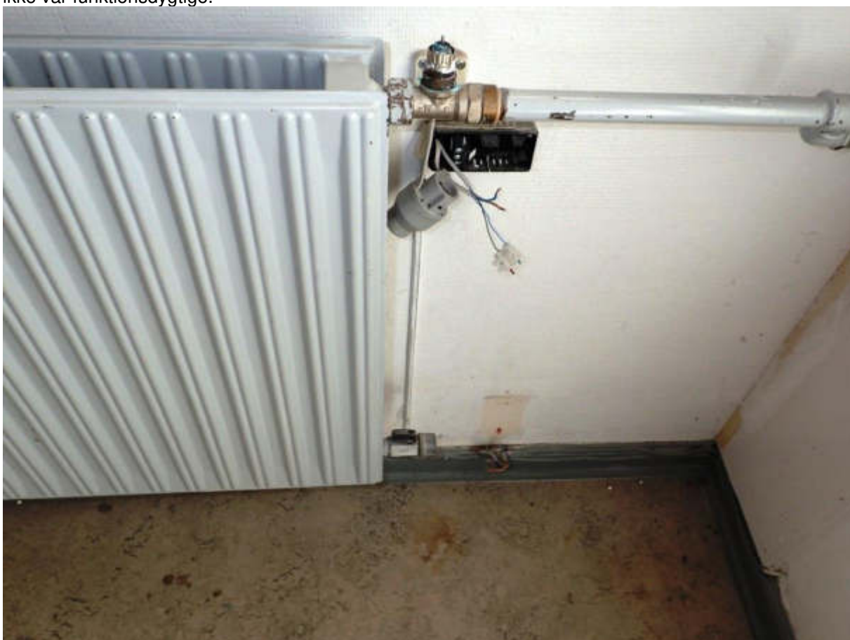
Figur 102 Klasseværelse 12. Termostatstyring på radiator demonteret.
