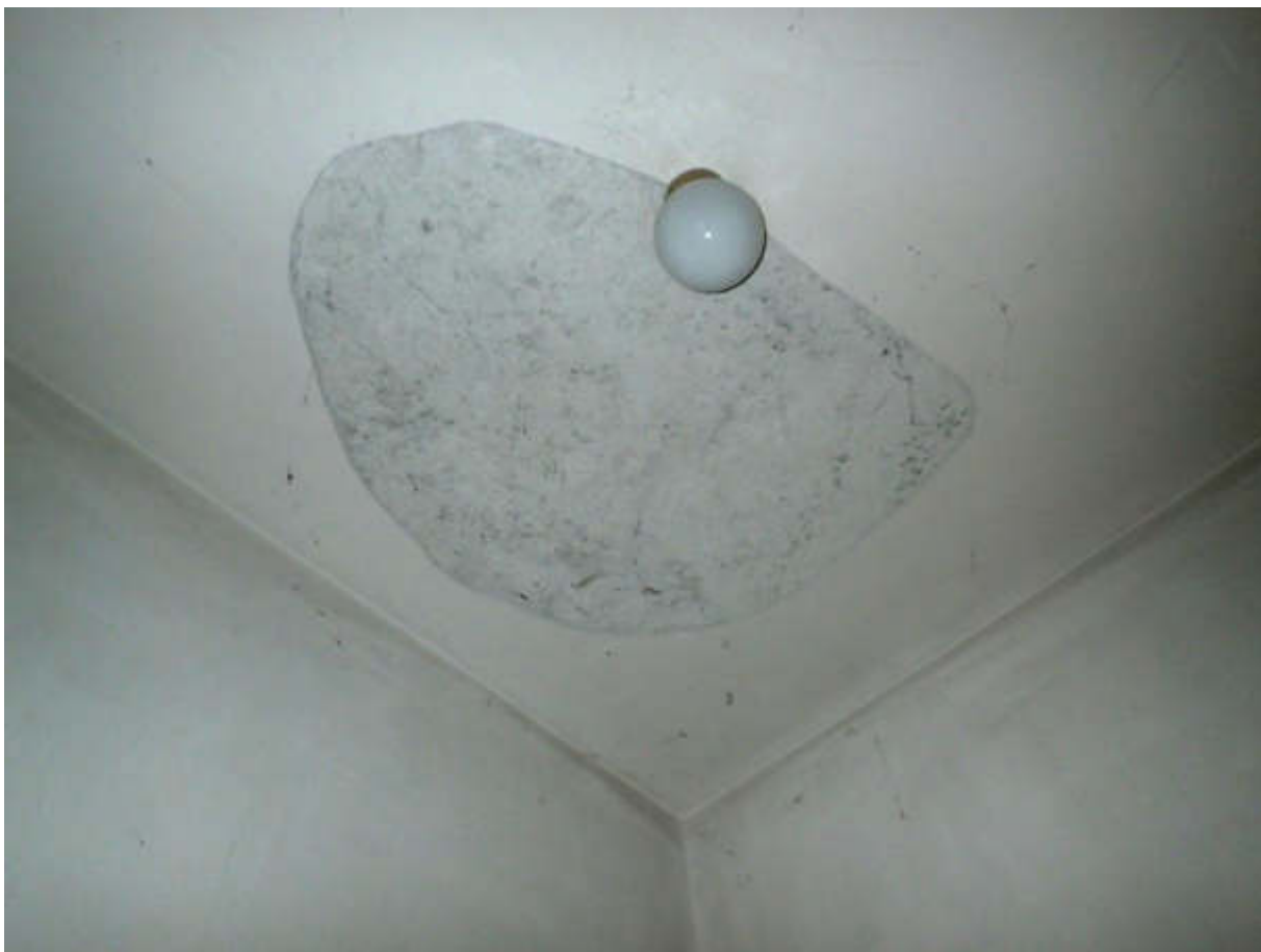
Figur 31 Rengørings- /depotrum. Loftpuds faldet ned.
