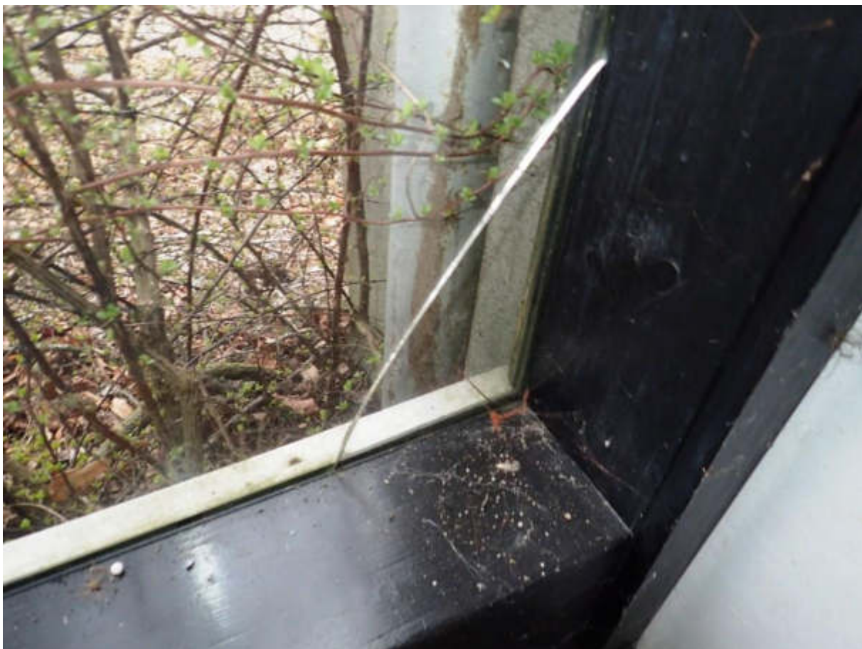
Figur 15 Mellemlbygning med kontorer. Knækket rude i vinduesparti. Vindue med et lags rude.
