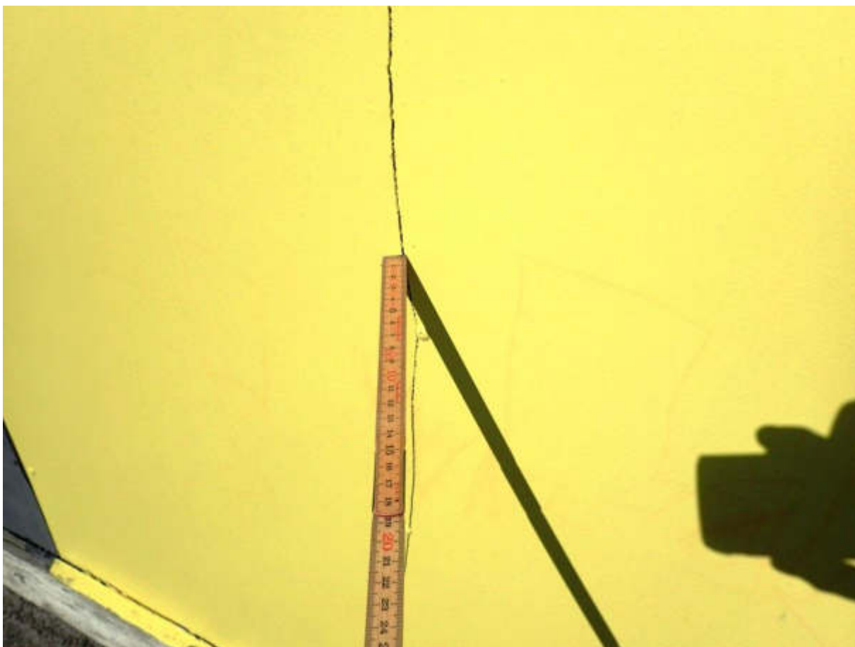
Figur 78 Facade mod syd. Flere steder blev registreret fibercementplader med brud /skader.
