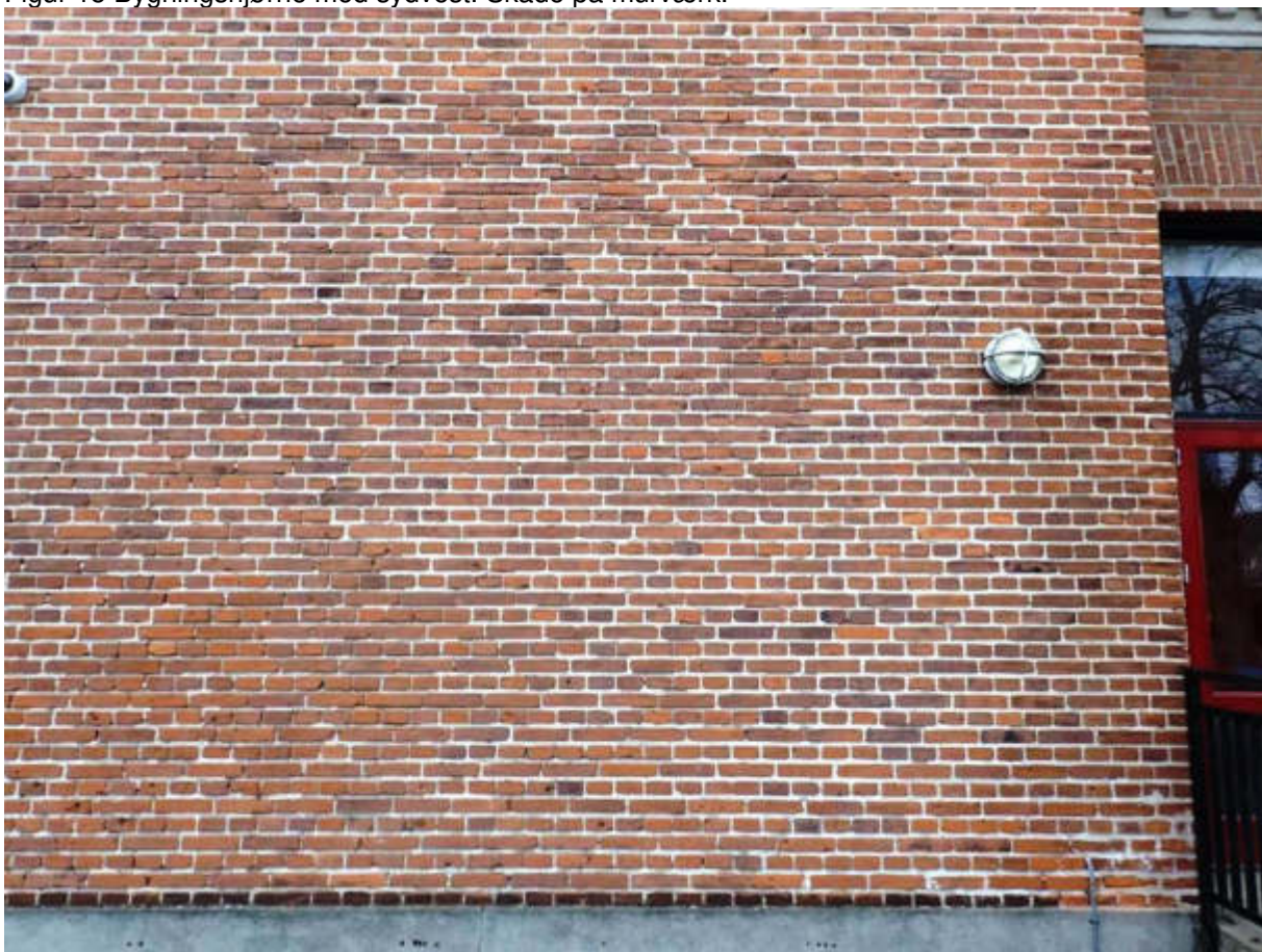
Figur 16 Facade mod øst. Manglende mørtelfuger registreret adskillige steder i murværk, antagelig pga. tidligere boldspil.
