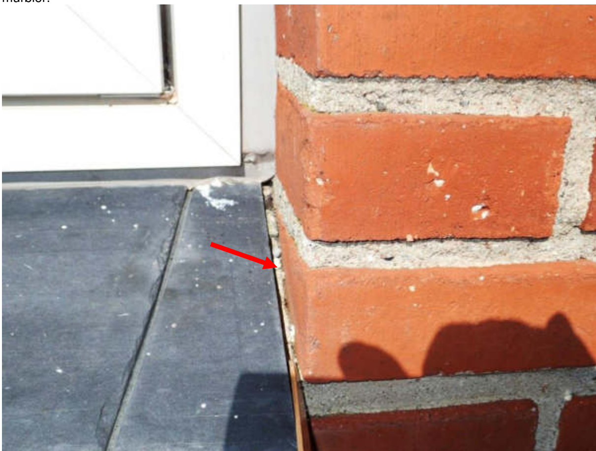
Figur 76 Facade mod syd. Flere steder manglede fuger mellem sålbænk og murværk (rød pil).
