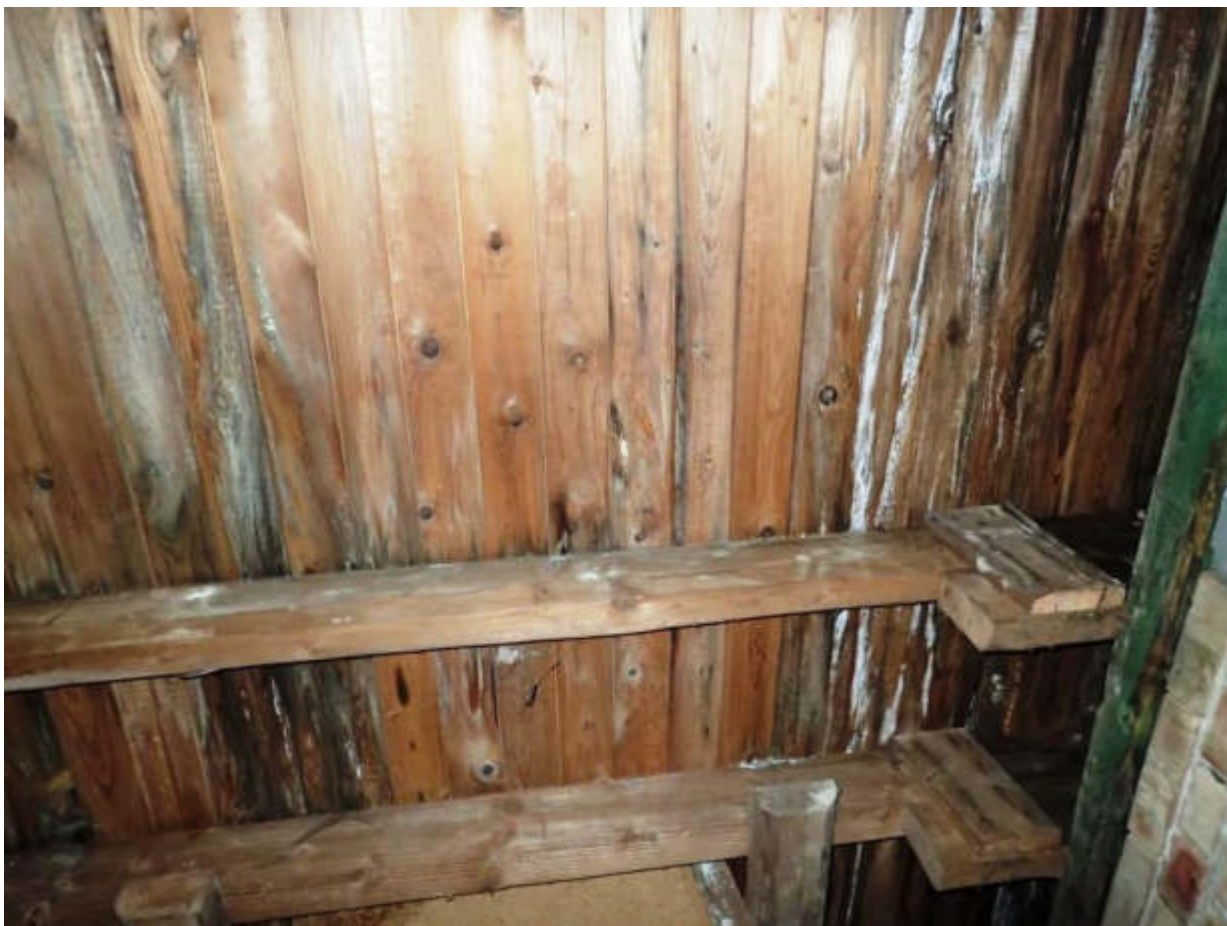
Figur 39 Tagrummet set via åbning i loftet. Synlige svampeforekomster registreret.
