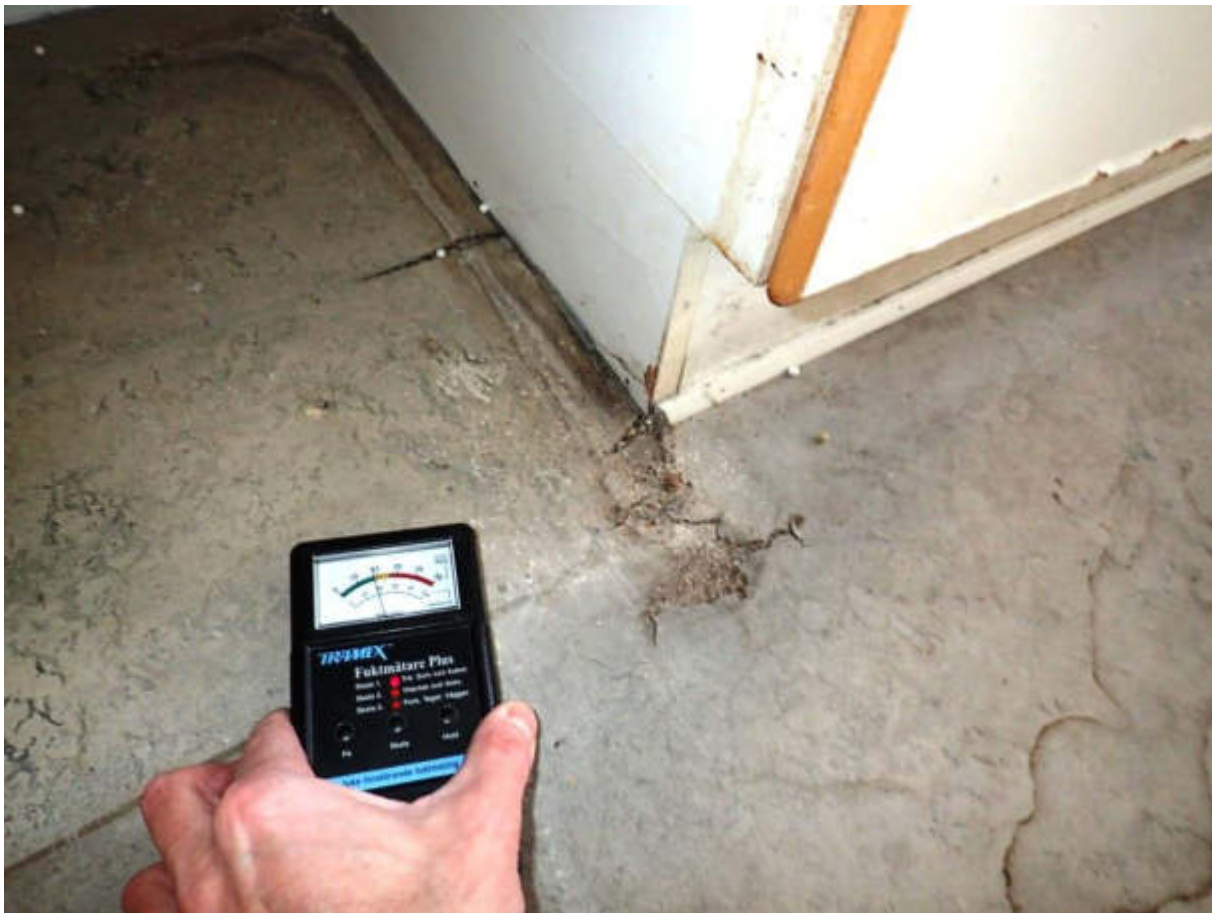
Figur 147 Køkkenet ved lærerværelset. Gulvbelægning med skade dog ingen forhøjet fugtniveau registreret.
