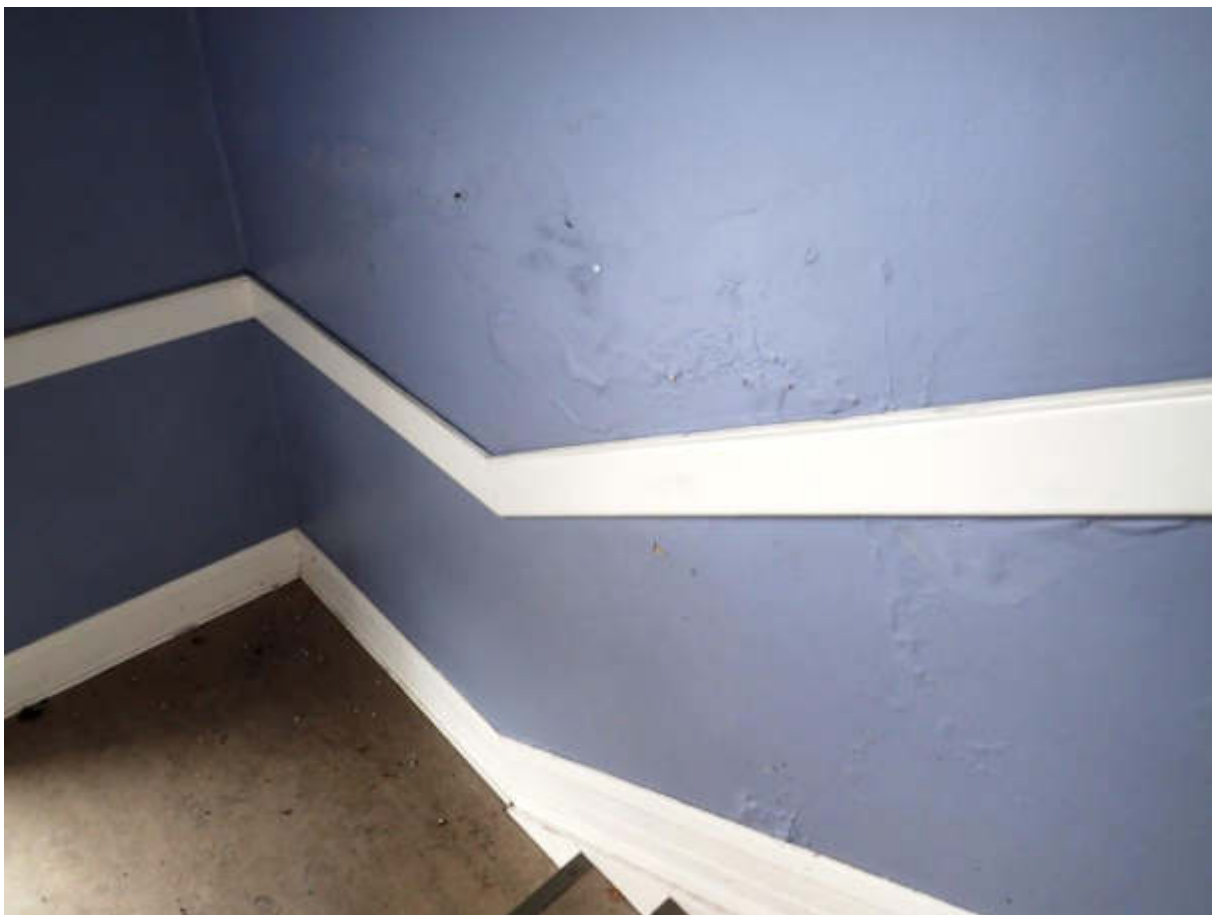
Figur 51 Trapperummet mod øst. Opfugtet murværk med løst puds.
