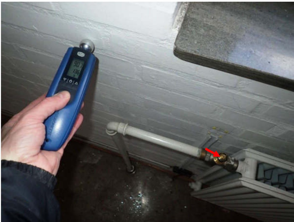
Figur 129 Gangen på 1.sal. Der blev registreret forhøjede fugtniveauer i ydervæggen mod nord (ca. 90 ud af 100 digts -vådt). Bemærk radiator uden termostatventil (rød pil).
