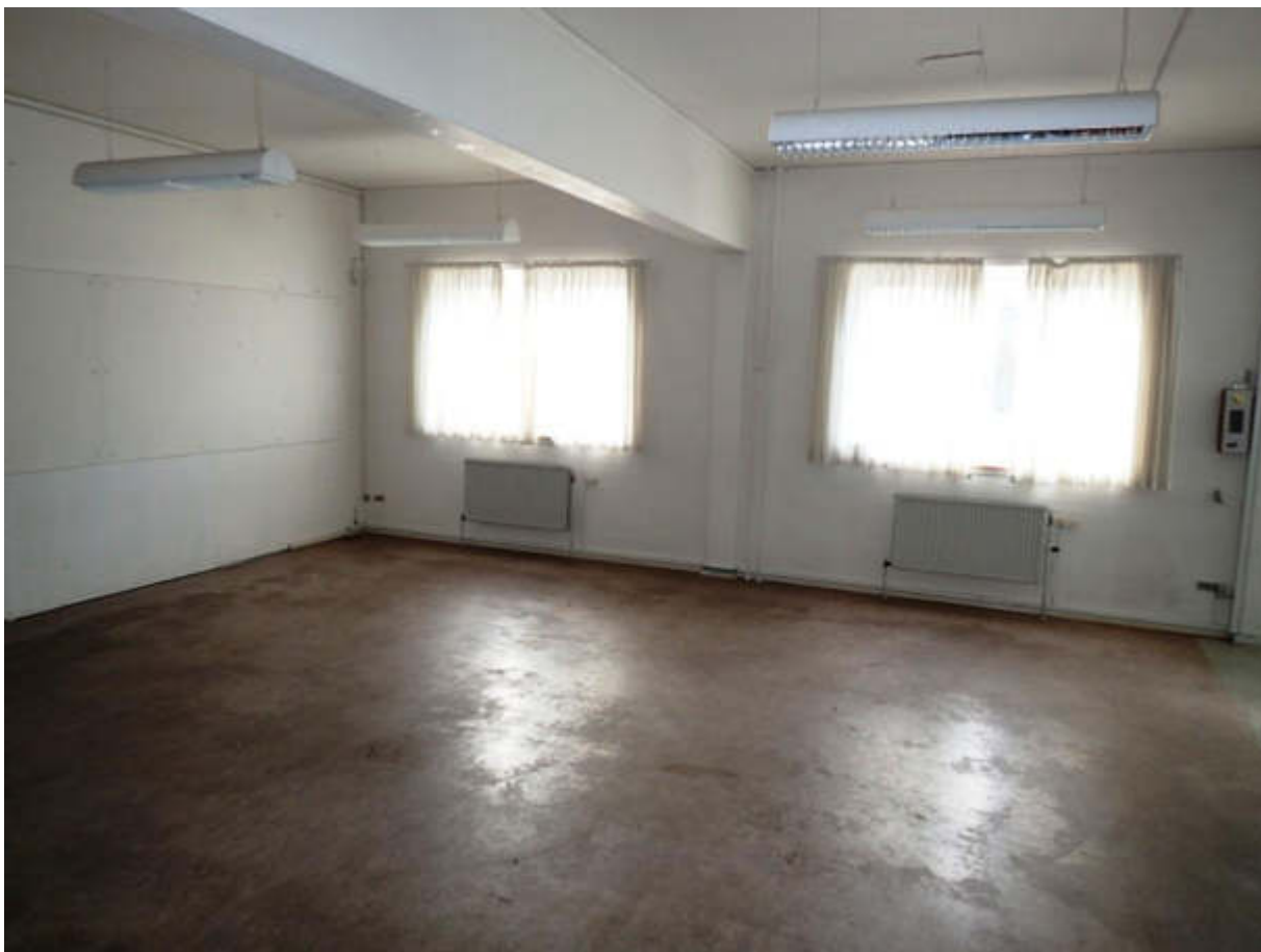
Figur 121 Stueetagen. Slidte gulvbelægninger, tæt på udtjent.
