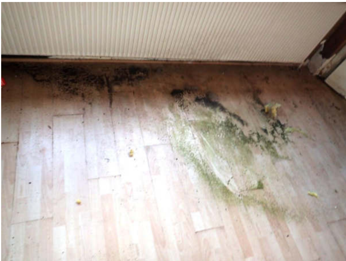
Figur 27 Kantinen. Opfugtet gulv med skjolder og alger.
