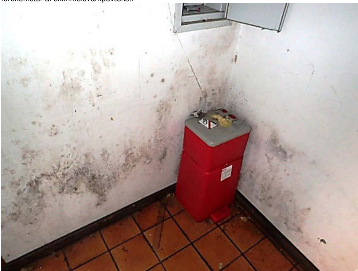
Figur 24 Opfugtede konstruktioner med massive synlige forekomster af skimmelsvampevækst.
