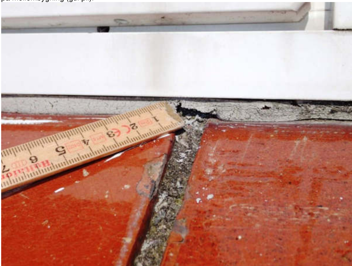
Figur 18 Facade mod syd. Fuge mellem vindue og sålbænk af ældre dato med hul.
