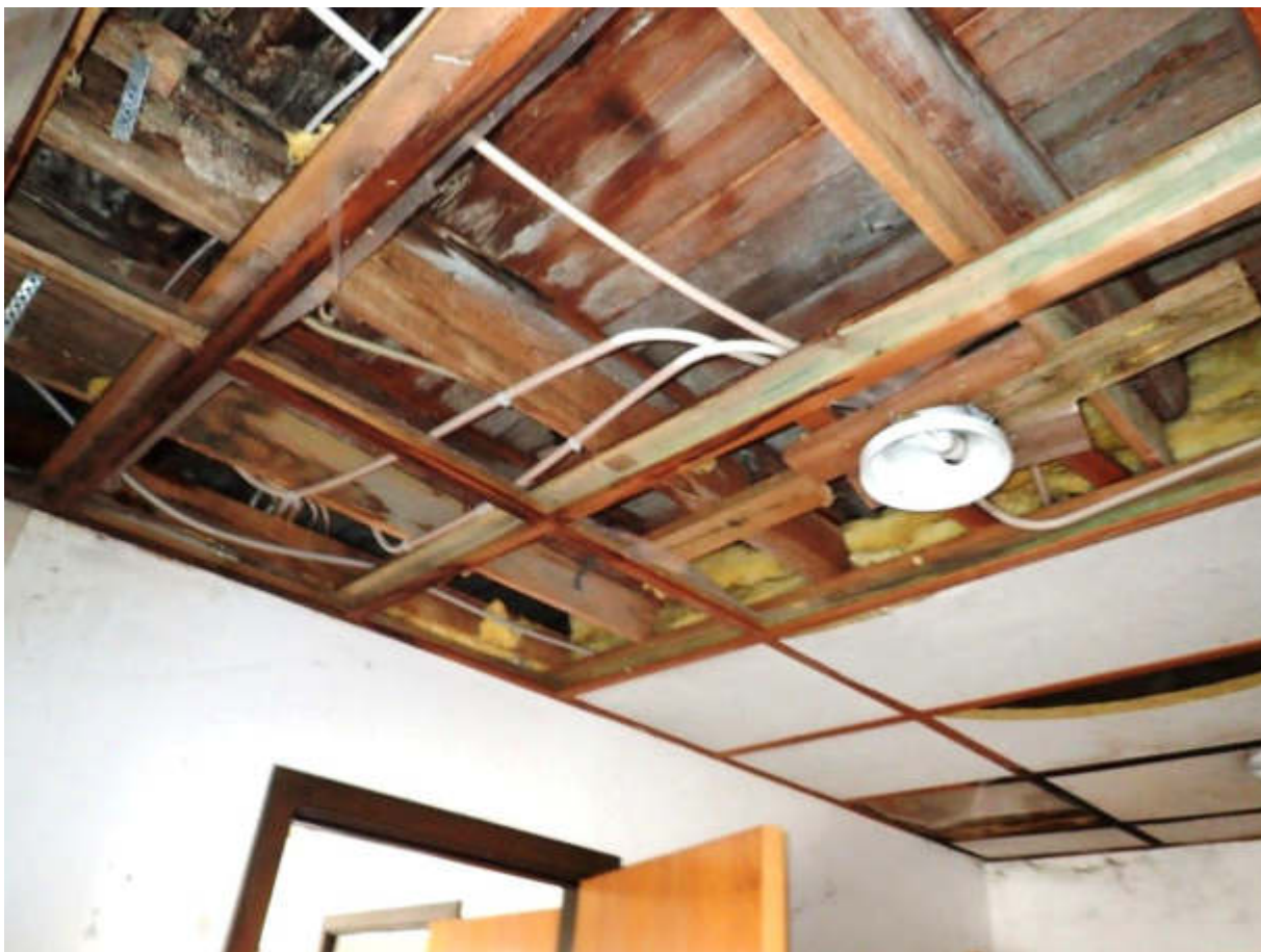
Figur 19 Skadet loft- og tagkonstruktion med opfugtede konstruktioner samt massive synlige forekomster af skimmelsvampevækst.
