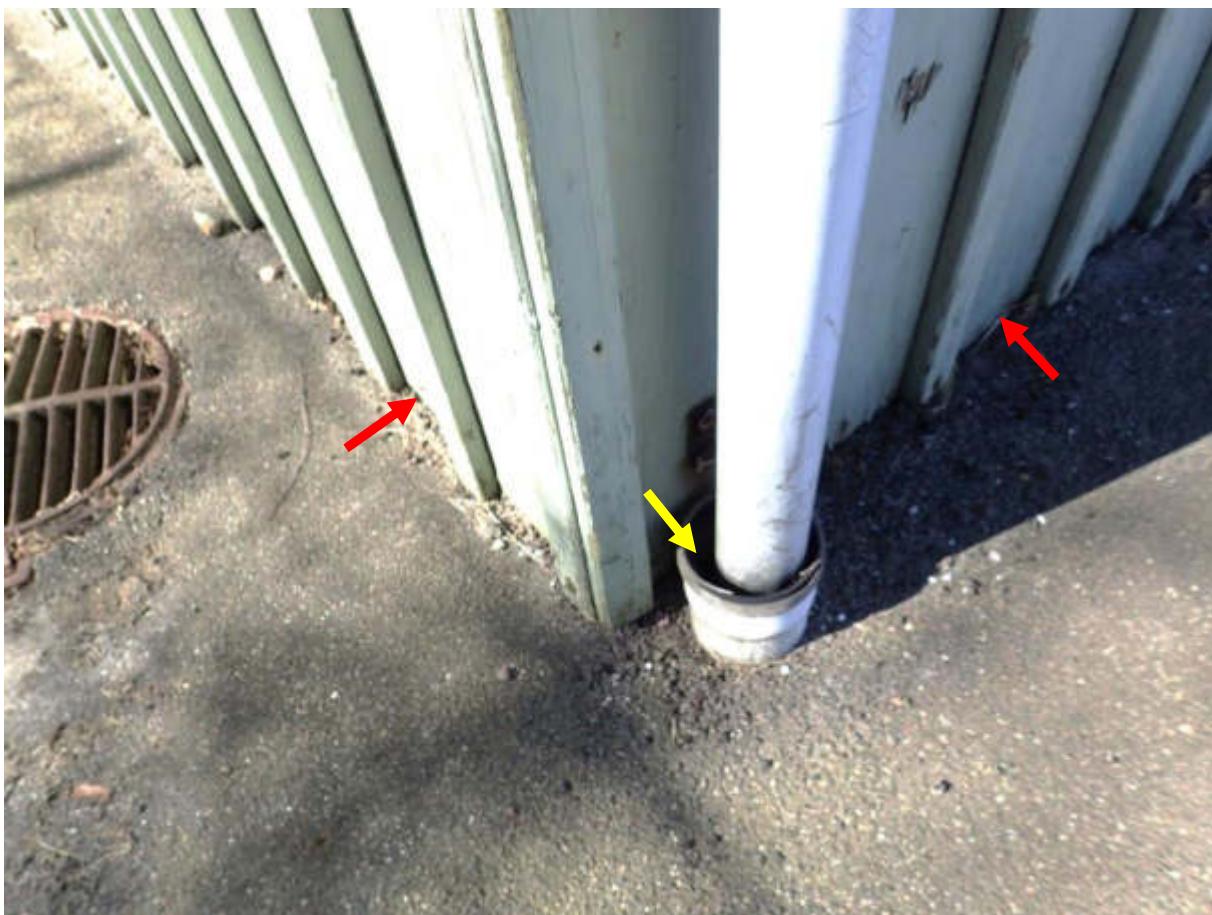
Figur 18 Udhusbygning mod øst. Bemærk træværk står uhensigtsmæssigt tæt mod terræn (røde pile). Bemærk endvidere uhensigtsmæssig åbning mellem nedløbsrør og afløbsrør (gul pil).
