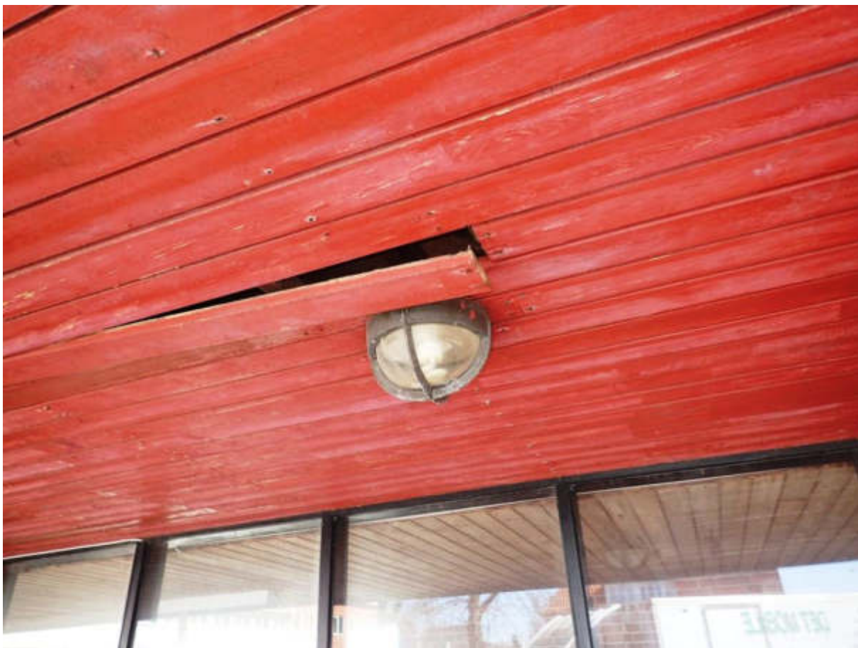
Figur 7 Udhæng mod vest /skolegården. Skader registreret enkelte steder.
