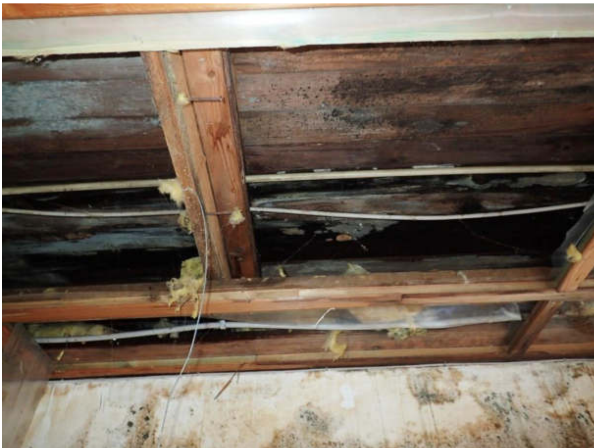
Figur 31 Kantinen. Skadet loft- og tagkonstruktion med opfugtede konstruktioner samt massive synlige forekomster af skimmelsvampevækst.
