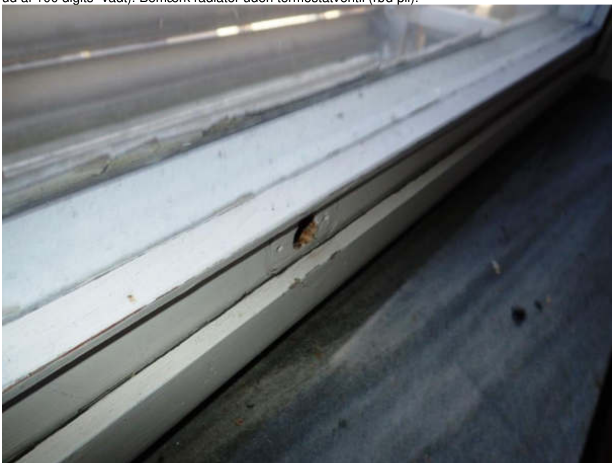
Figur 130 Gangen på 1.sal. Greb mangler på vindue. Vindue af ældre dato med koblede rammer.
