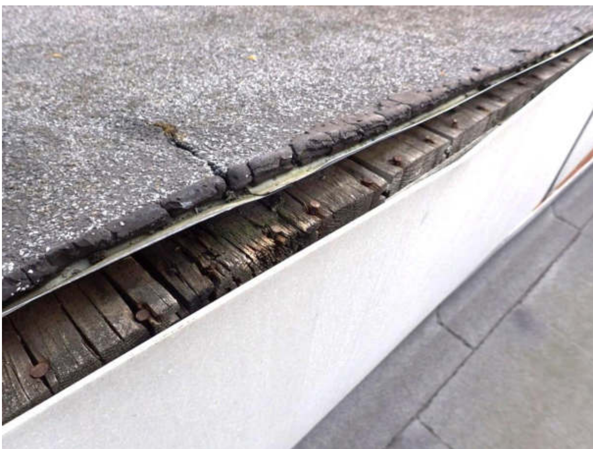
Figur 6 Tagfladen. Flosset og udtjent tagpap. Her ved sternkant. Bemærk tagbrædder påvirket af hyppig fugt og med nedbrud.
