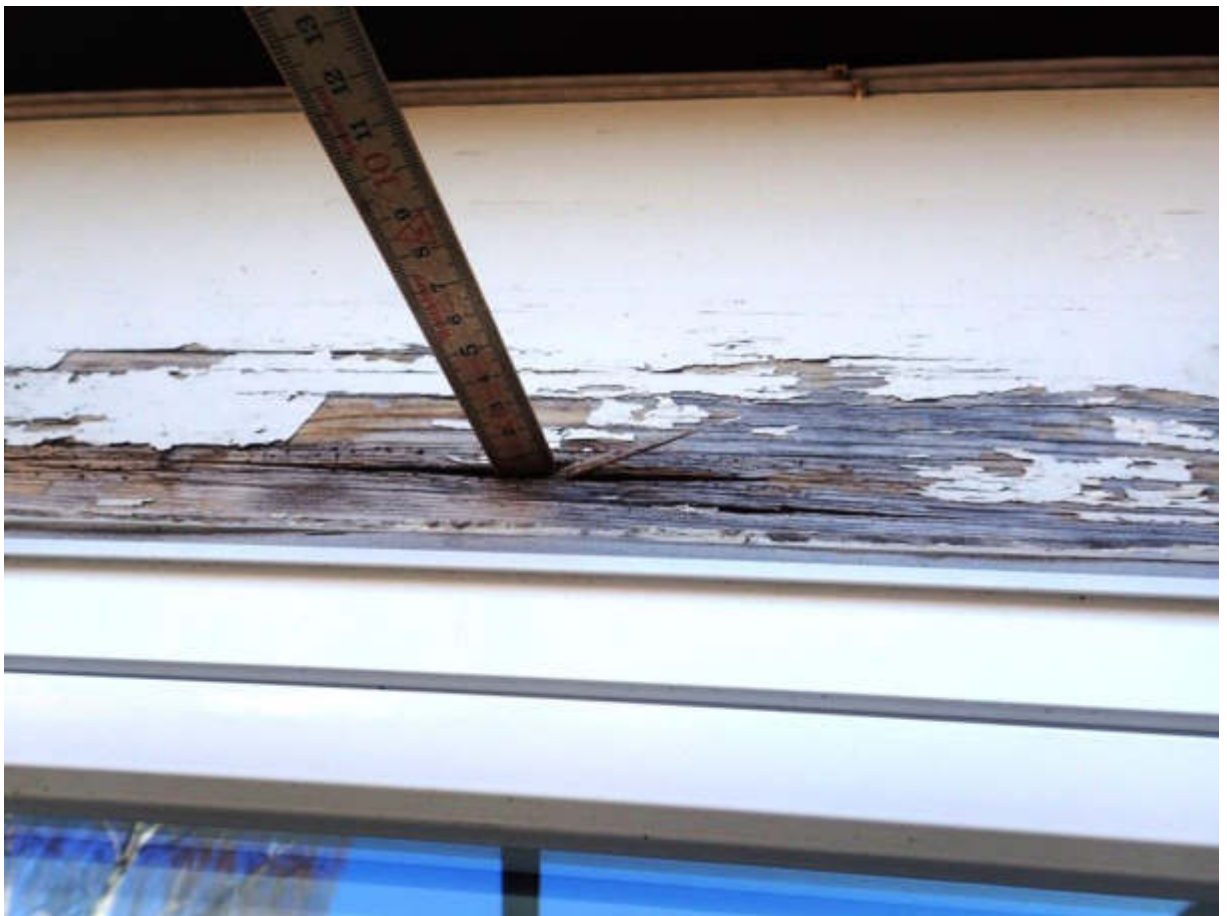
Figur 2 Mellembygning med kontorer. Begyndende nedbrud i træværk over vinduer.
