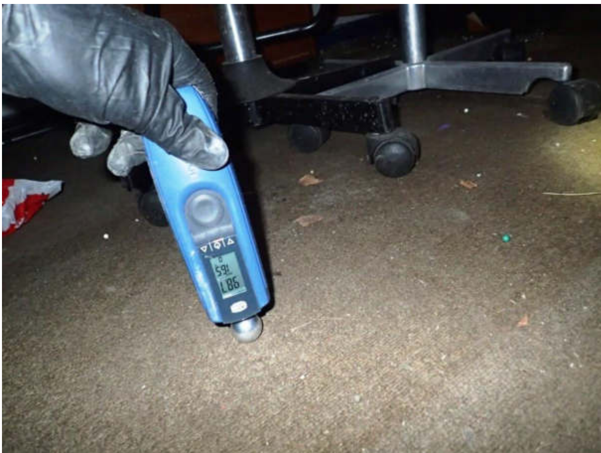
Figur 36 Kontor i kælderen. Høje fugtniveauer registreret i gulvet (ca. 98 ud af 100 digits -vådt).
