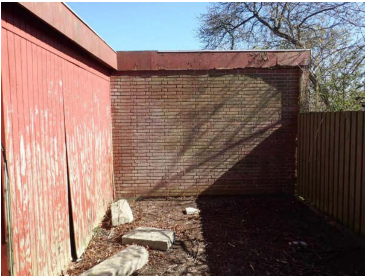
Figur 17 Bygningshjørne mod sydvest. Opfugtet murværk med alger samt skader og forfald i træværk.
