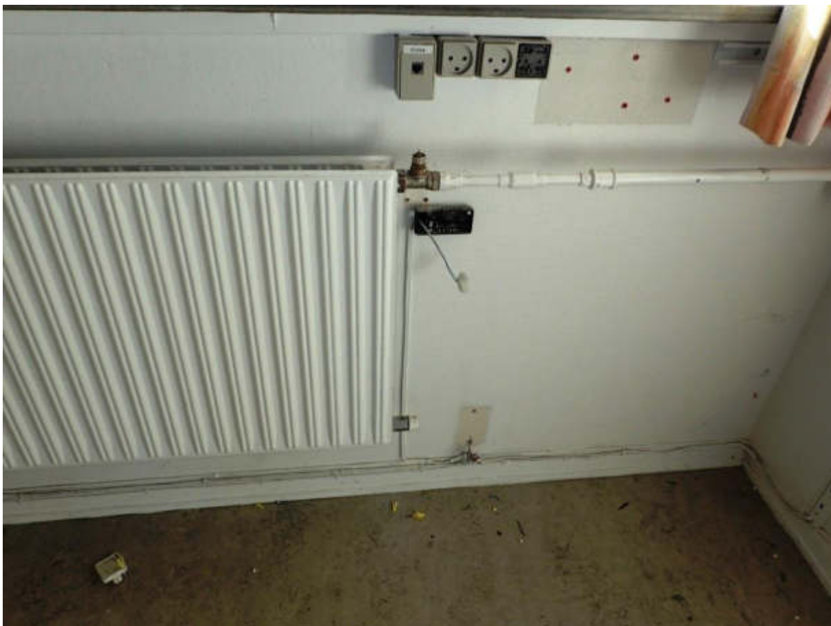
Figur 107 Klasseværelse 14. Termostatstyring på radiator demonteret.
