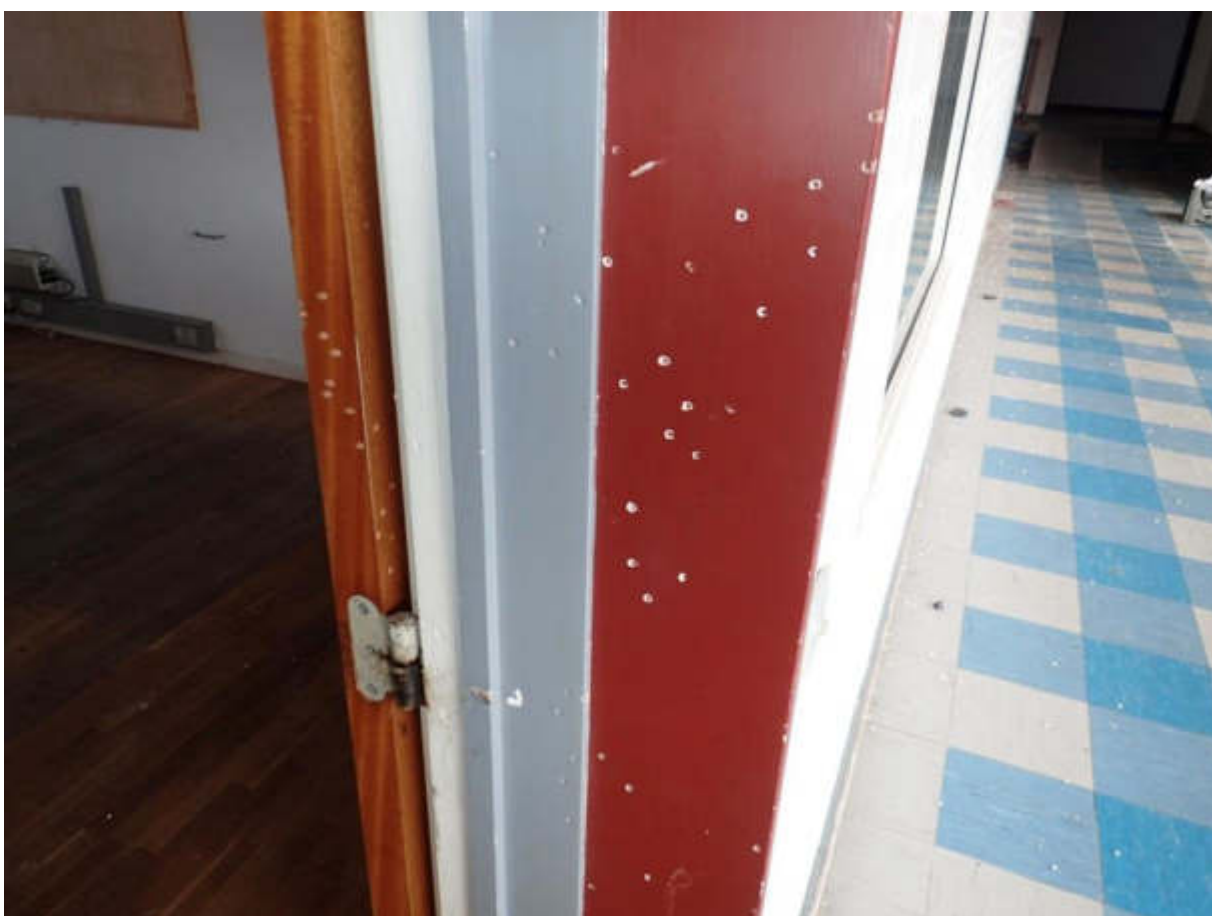
Figur 16 Mellemlbygning med kontorer. Der blev adskillige steder registreret mærker /skader på indvendige overflader, her på dør og dørkarm.
