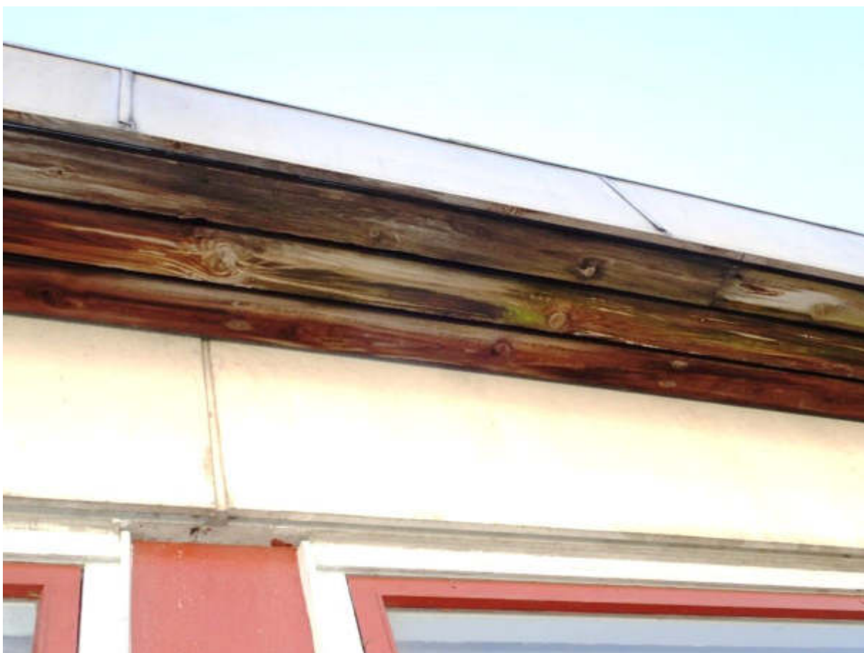
Figur 14 Facade mod nord. Fugtskjolder på udhængsbrædder.
