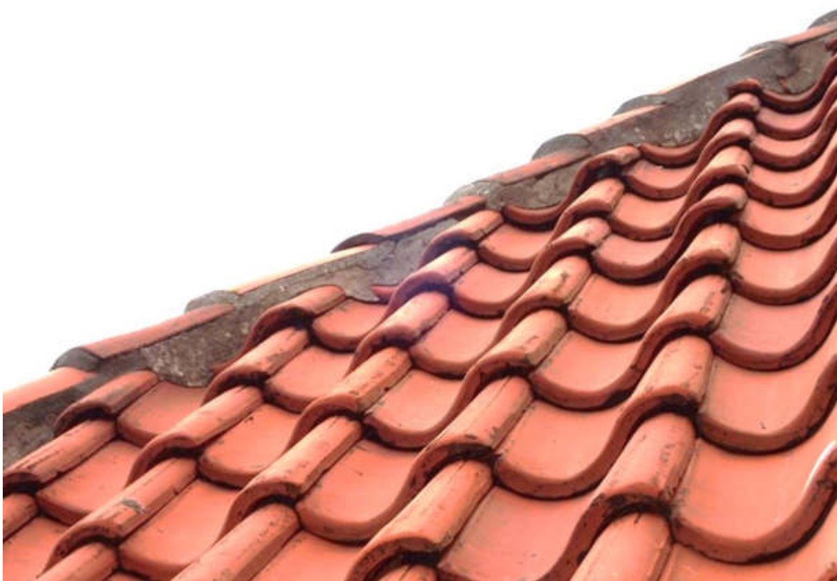
Figur 10 Grat mod syd. Der blev ikke registreret nævneværdige skader e.l. på tagsten. Tagsten med rimelig stand og rimelig restlevetid.
