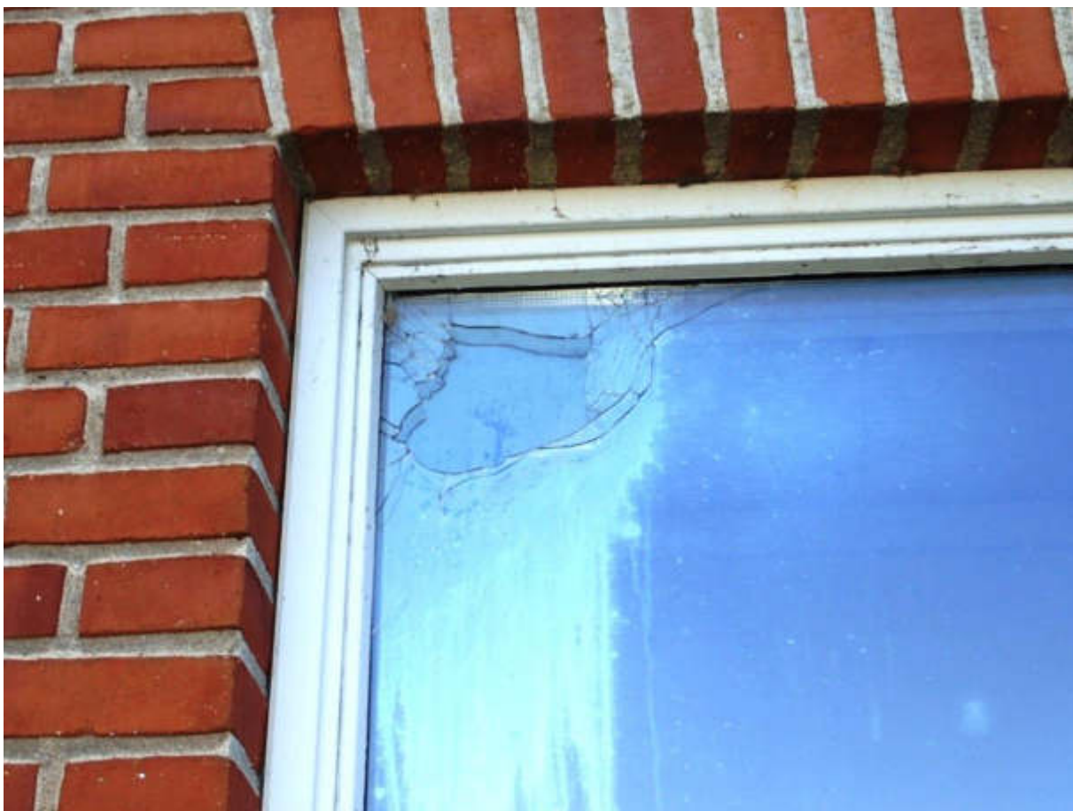
Figur 88 Facade mod nord. Vindue af ældre dato med smadret rude.
