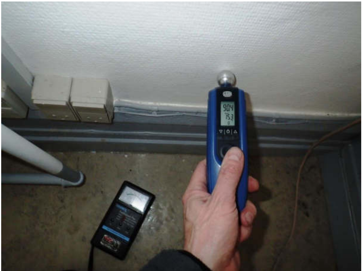
Figur 35 Forhøjede fugtniveauer registreret flere steder i bygningen randzoner (ca. 90 ud af 100 digits vådt).
