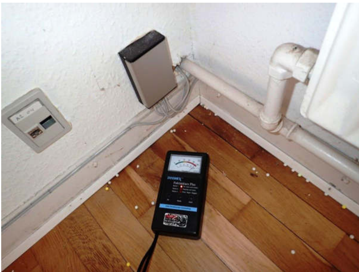
Figur 18 Mellembygning med kontorer. I trægulve blev registreret forhøjede fugtniveauer, især i randzonen.
