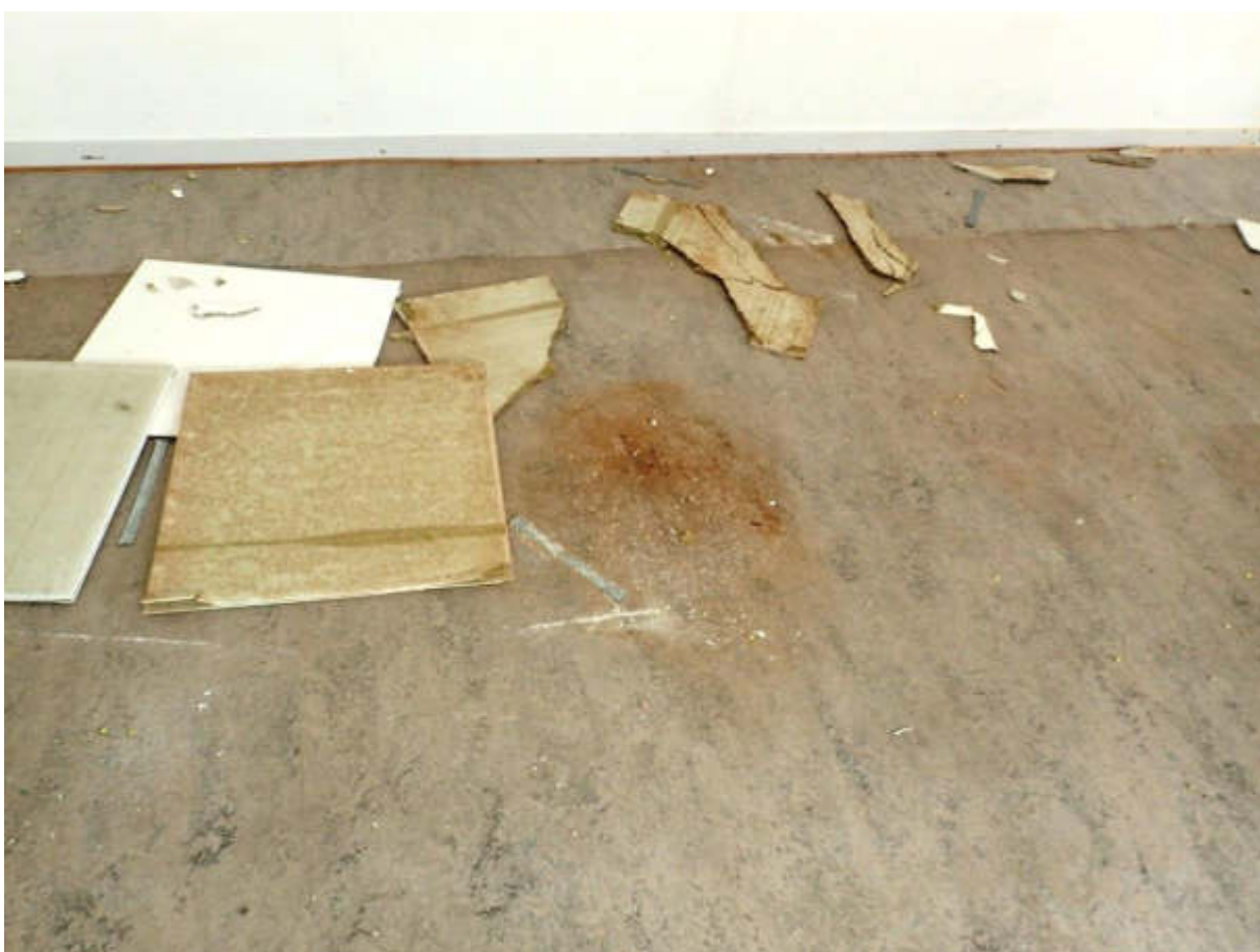
Figur 28 Undervisningslokalet mod syd. Fugtskjolder på gulvet og kollapsede loft indikerer utæthed i taget.
