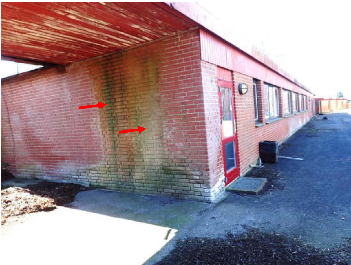
Figur 8 Ydervæg mod øst. Utæthed i tagdækning medfører fugt og skader i murværk (røde pile).
