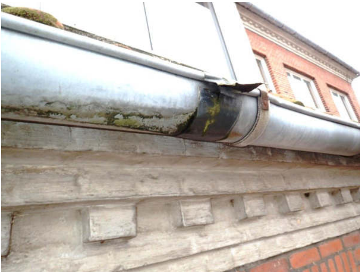
Figur 5 Facade mod nord. Tyndslidte tagrender med hul og interimistisk reparation.
