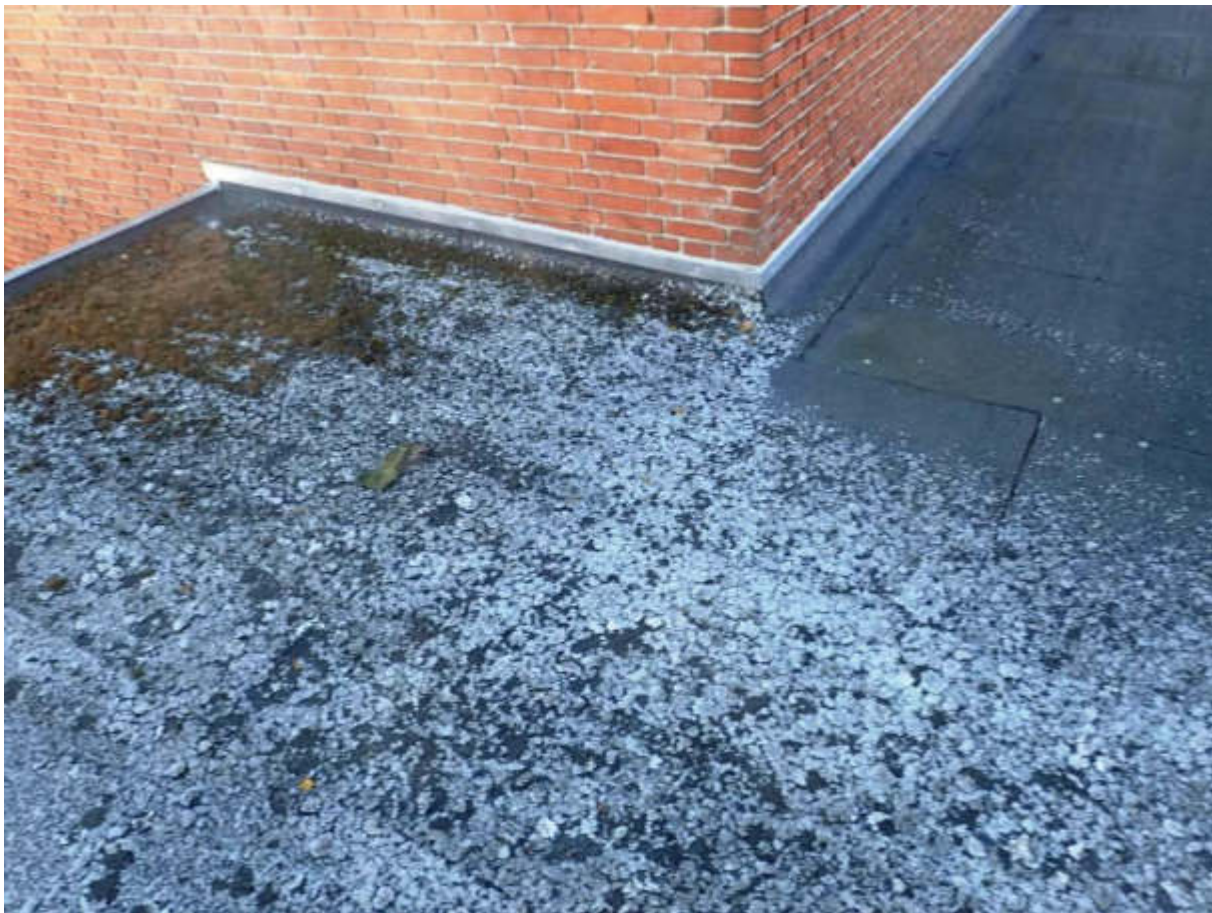
Figur 3 Tagfladen under skade i udhæng på bygning 5. Der blev registreret alger og forvittringer i tagpap i dette område. Indvendigt blev registreret indikation på indtrængende nedbør.
