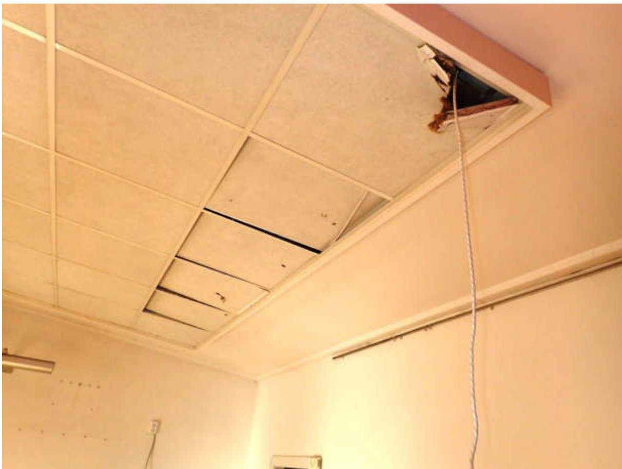
Figur 145 Lærerværelset. Loftplader med skader.
