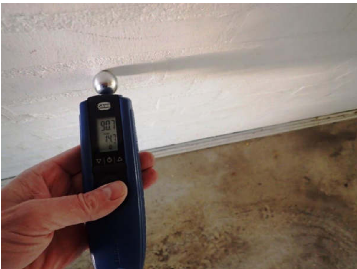
Figur 22 Gangen. Høje fugtniveauer registreret i murværk (ca. 90 ud af 100 digits -vådt).
