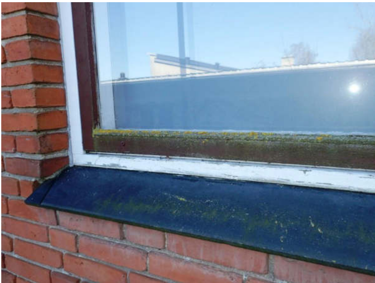
Figur 89 Facade mod nord. Vindue af ældre dato med ringe vedligehold. Vurderingsmæssigt fra 1963.
