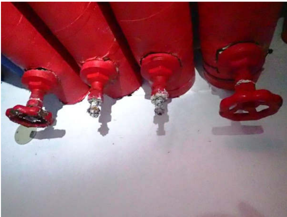
Figur 47 Kælderen. Vvs-installation med ir /korrosion.
