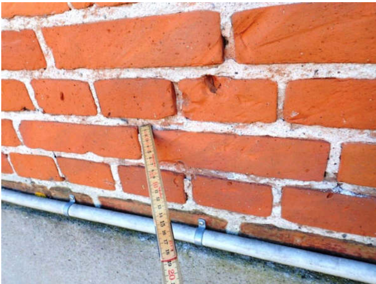
Figur 13 Facade mod nord. Manglende mørtelfuger registreret i murværk.
