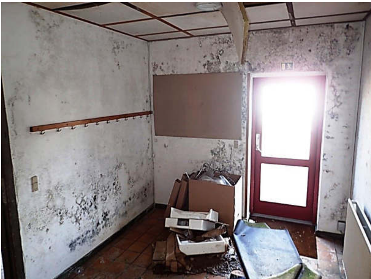
Figur 37 Vindfang mod øst. Opfugtede konstruktioner med massive synlige forekomster af skimmelsvampevækst.
