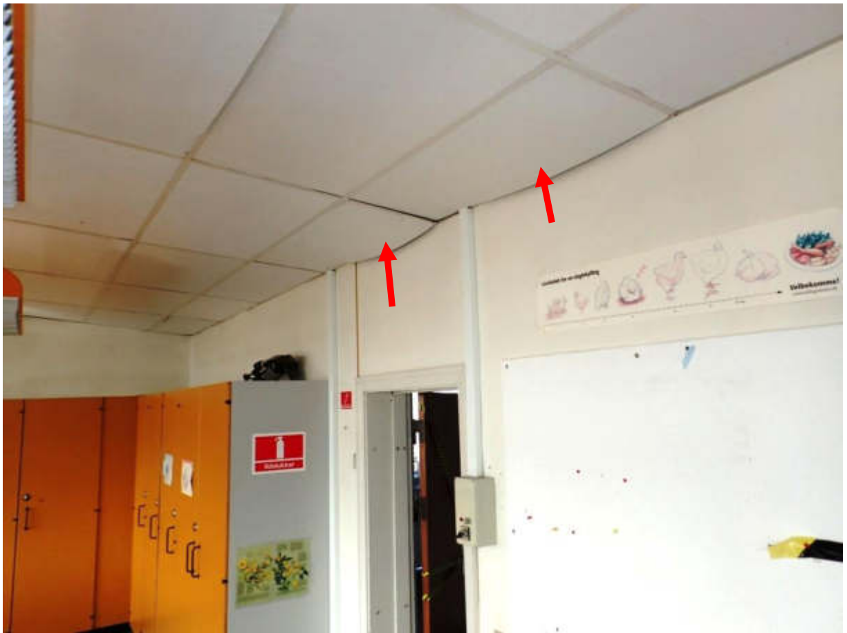
Figur 139 Skolekøkkenet. Løse og skæve loftplader (røde pile).
