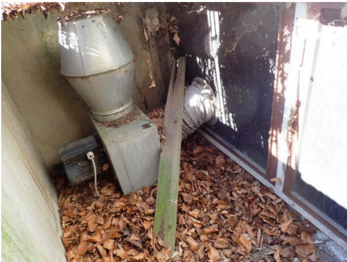
Figur 85 Facade mod syd /skolegården. Ventilator, antageligt udsugning, placeret i lyskasse (ukendt funktionsdygtighed).
