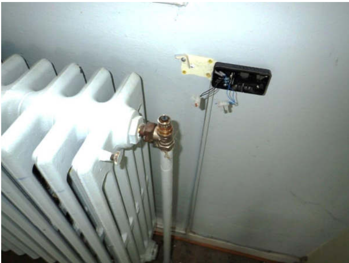
Figur 31 Adskillige steder var termostatstyring på radiatoranlægget demonteret.
