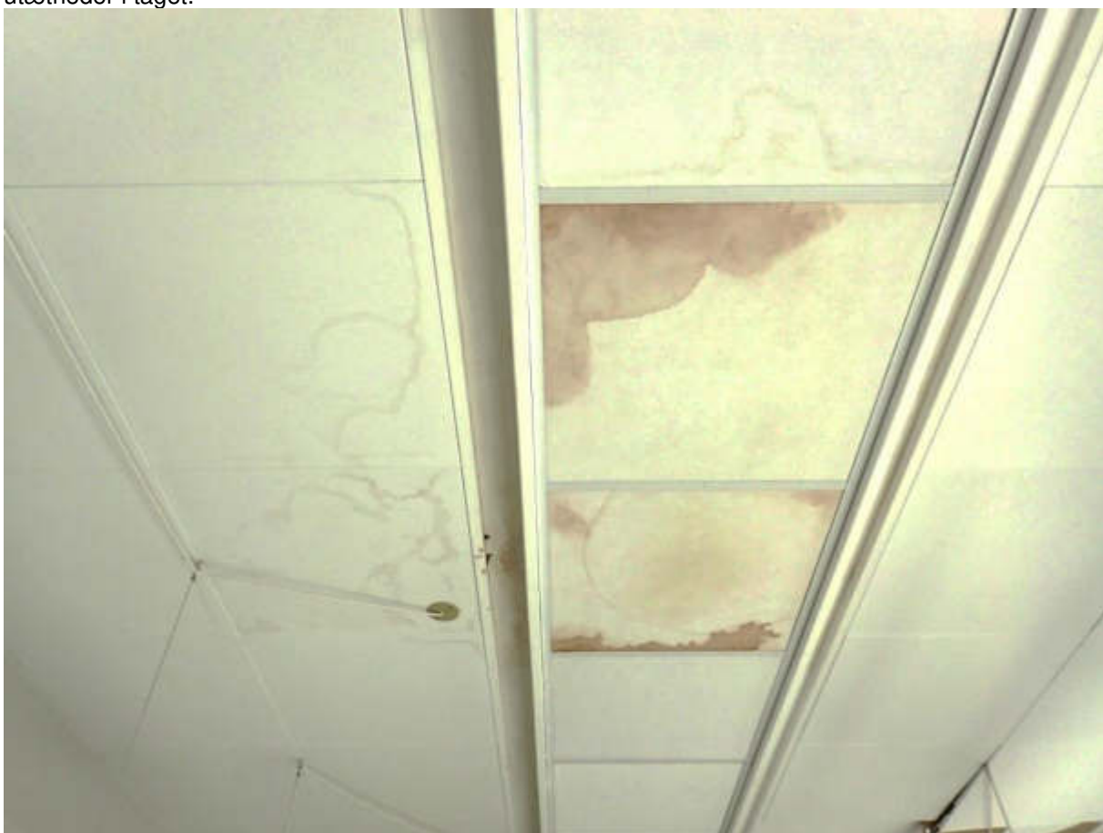
Figur 26 Undervisningslokale mod syd. Der blev registreret skjolder adskillige steder på loftet.
