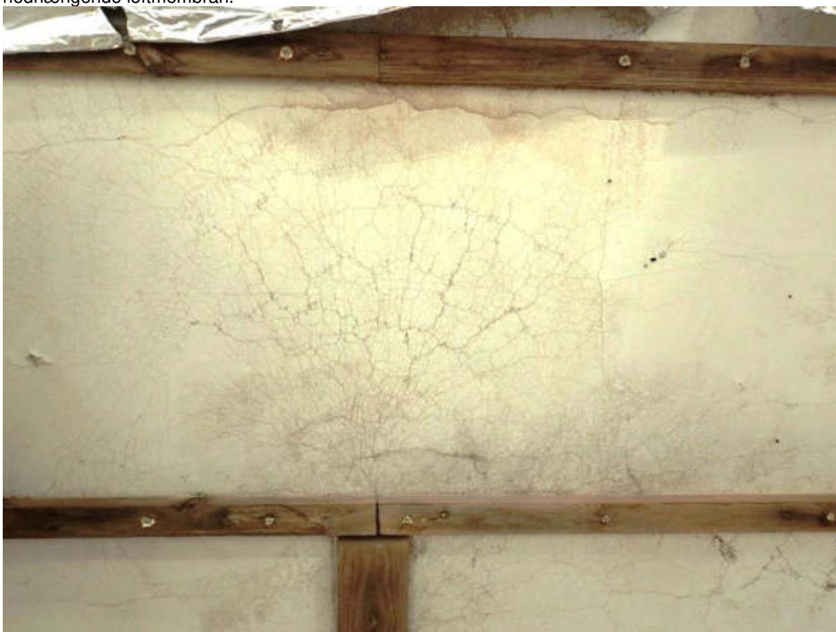
Figur 32 Undervisningslokalet mod øst. Væsentlige fugt og svampeskader registreret, her på overflade over kollapsed loft.
