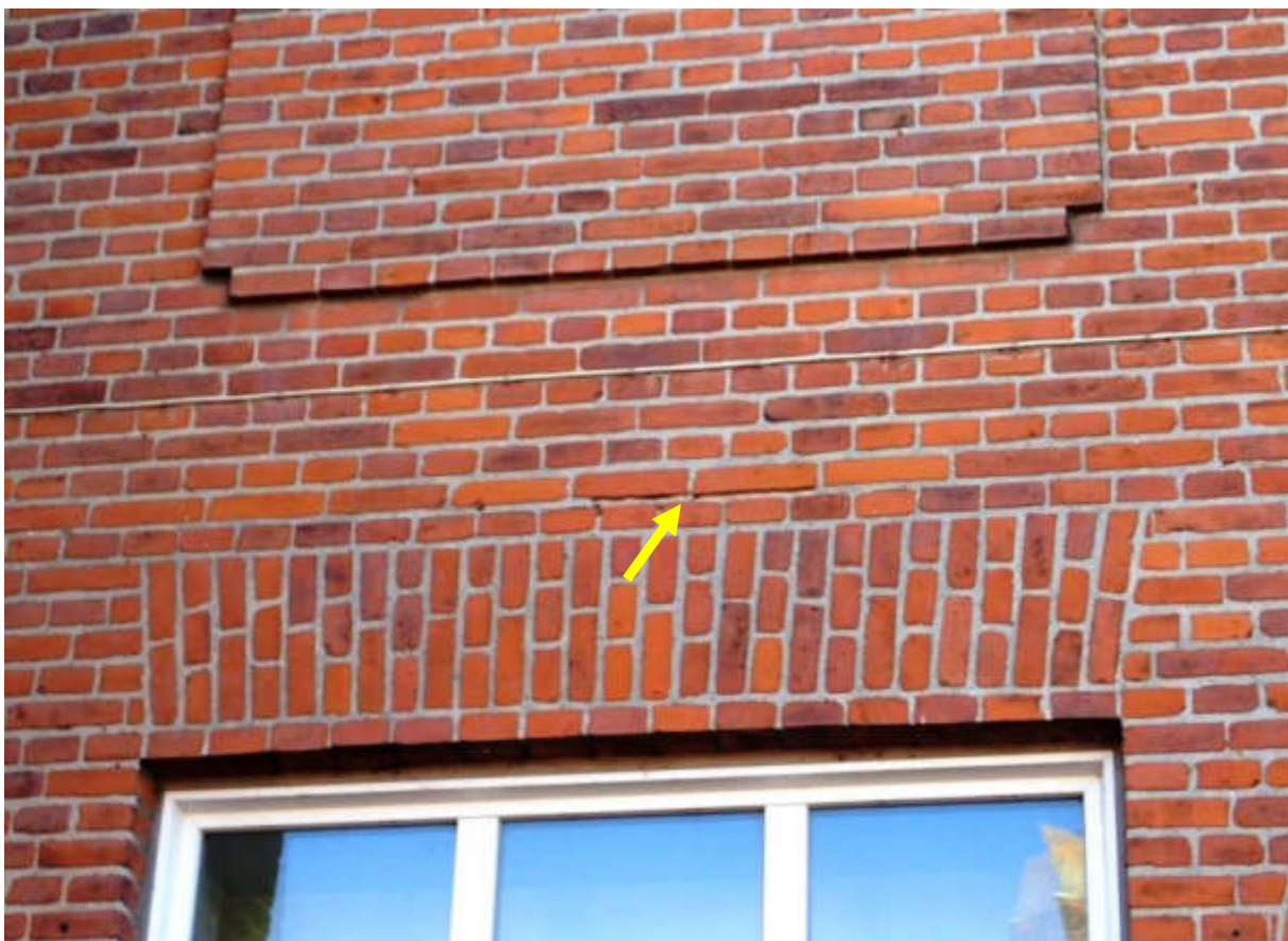
Figur 12 Facade mod nord. Manglende mørtelfuger registreret enkelte steder i murværk (gul pil).
