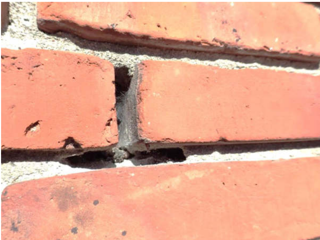
Figur 75 Facade mod syd. Enkelte steder blev registreret manglende mørtelfuger og indikationer på murbier.
