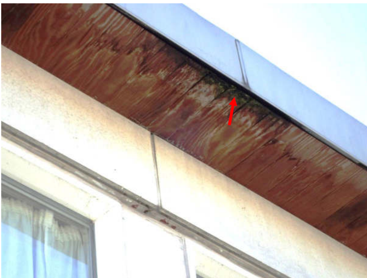
Figur 12 Tagudhæng mod nord. Fugtskjolder indikerer uhensigtsmæssig fugt (rød pil). Muligvis en ældre skade.
