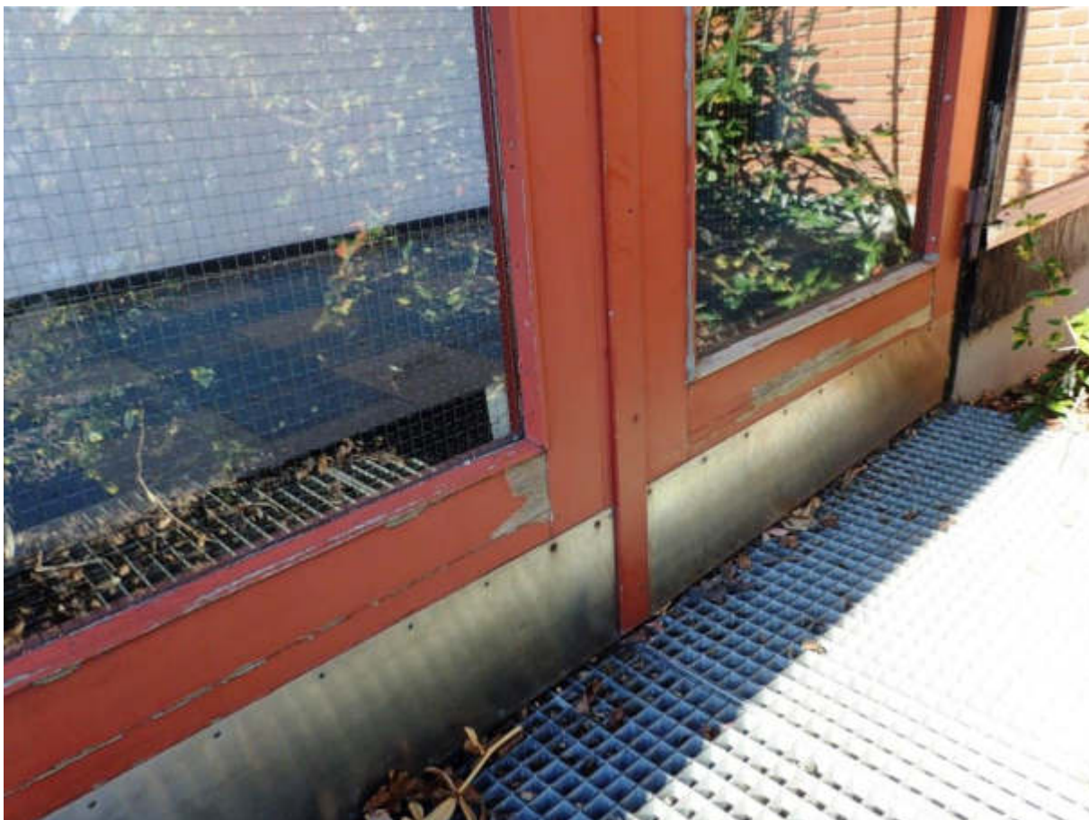
Figur 13 Mellembygning med kontorer. Facade mod øst. Dør og vinduespartier af træ med ringe vedligehold.
