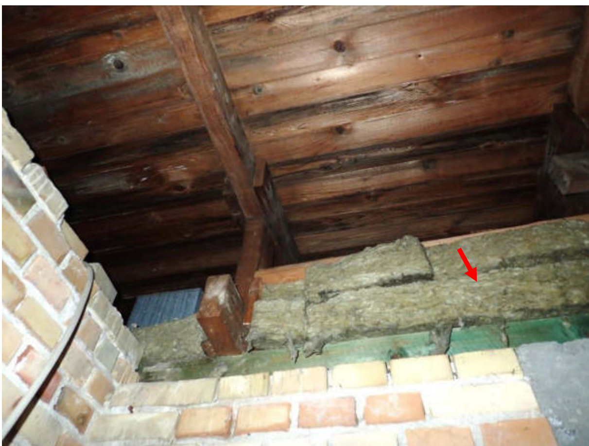
Figur 38 Tagrummet set via åbning i loftet. Ca. 20 cm mineraluld registreret (rød pil).
