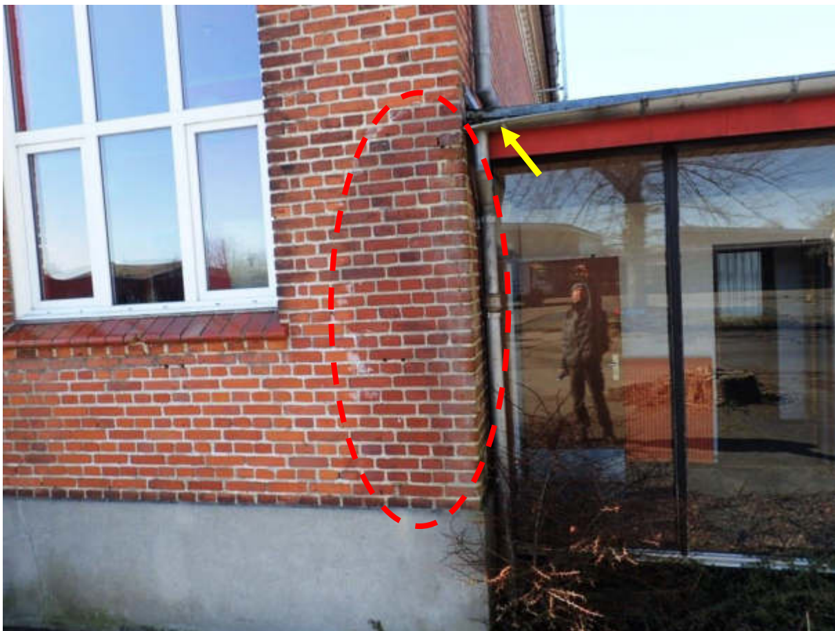
Figur 17 Bygningshjørne mod nordøst. Opfugtet murværk (rød stiptet markering) pga. skadet tagrende på mellembygning (gul pil).
