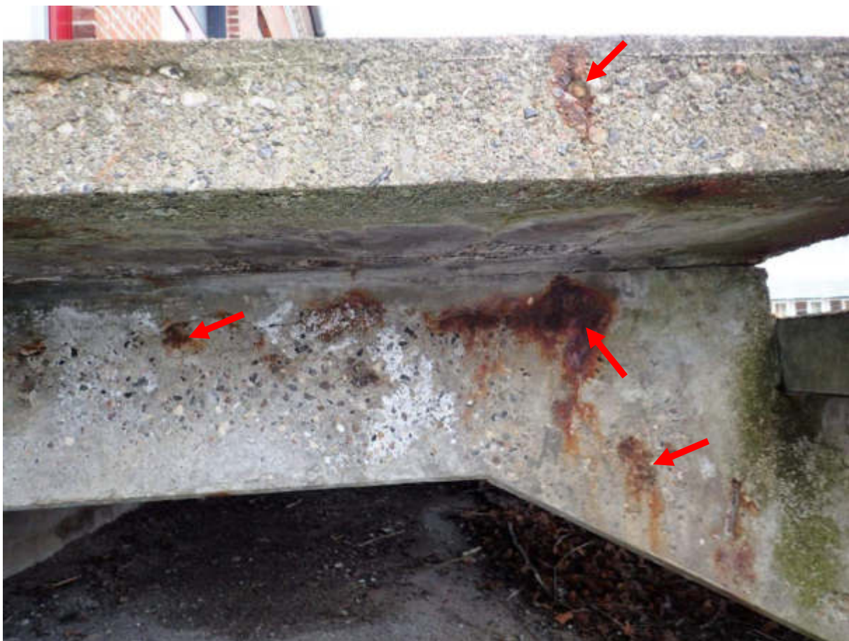
Figur 24 Facade mod øst /skolegården. Udvendig trappe af beton med korroderende jern (røde pile).
