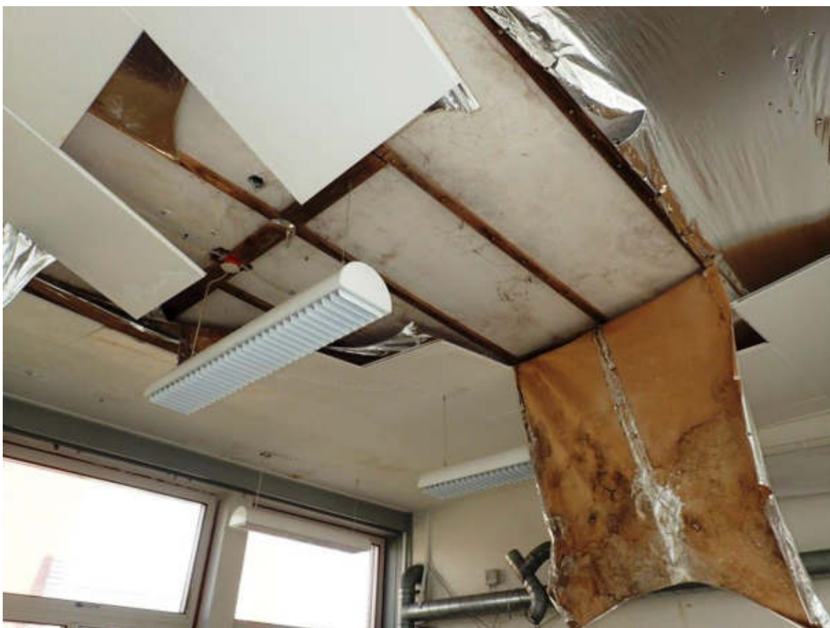
Figur 30 Undervisningslokalet mod øst. Kollapset loft med synlige forekomster af svamp indikerer utæthed i taget.
