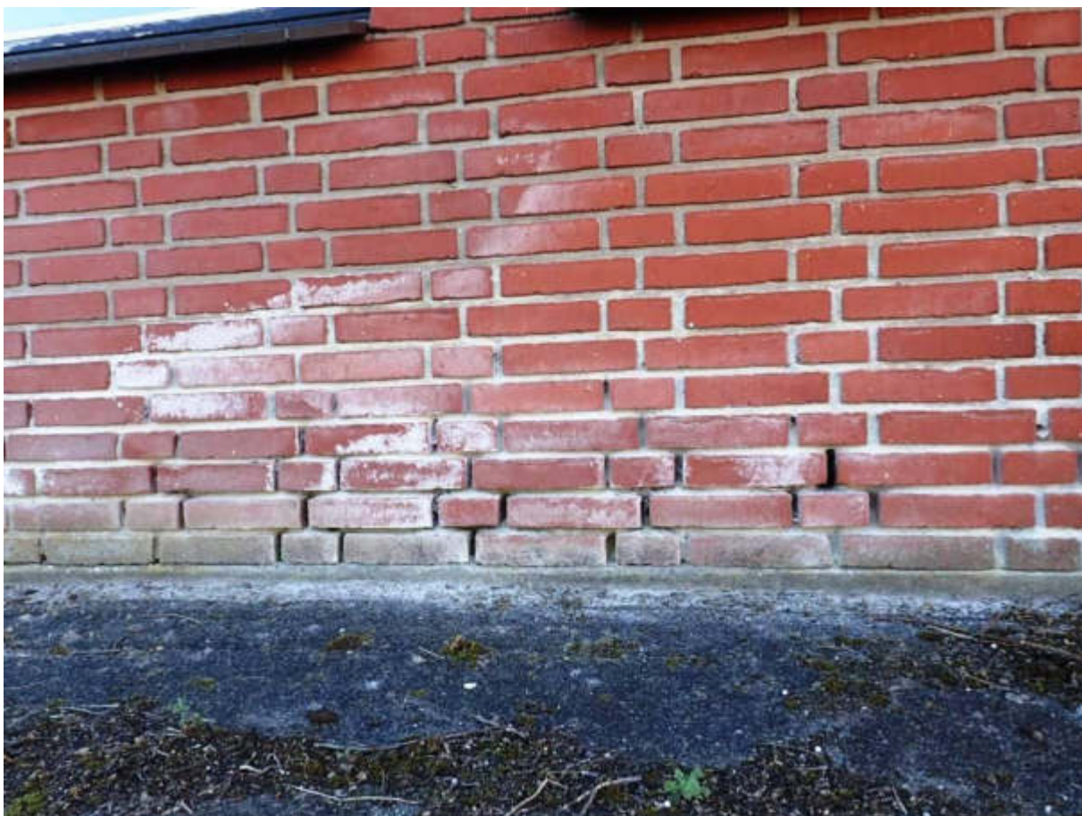
Figur 14 Facade mod nord. Murværk med manglende mørtelfuger og fugtskjolder.
