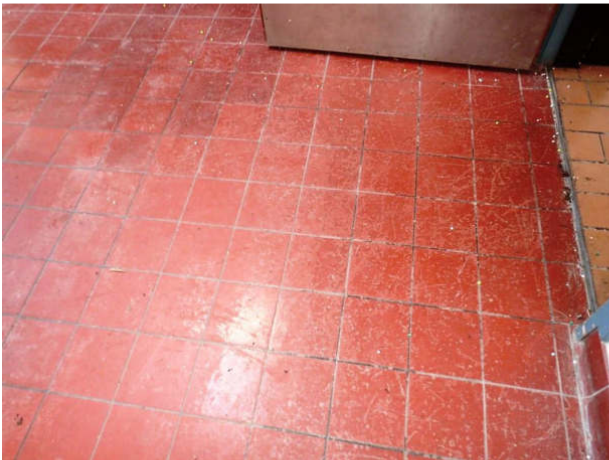
Figur 23 Forrum til omklædningsrum. Slidte gulvklinker.
