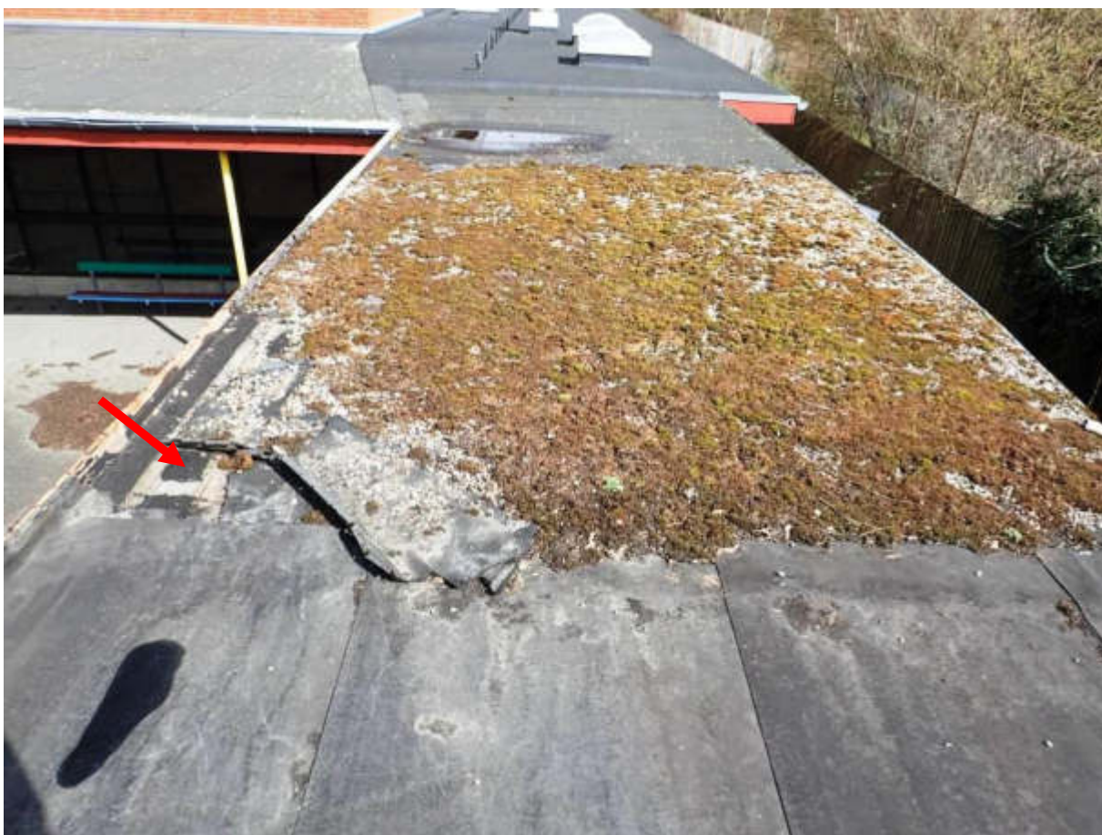
Figur 2 Tagfladen med udtjent tagpap af ældre dato. Hul i taget (rød pil). Risiko for nedbrud.
