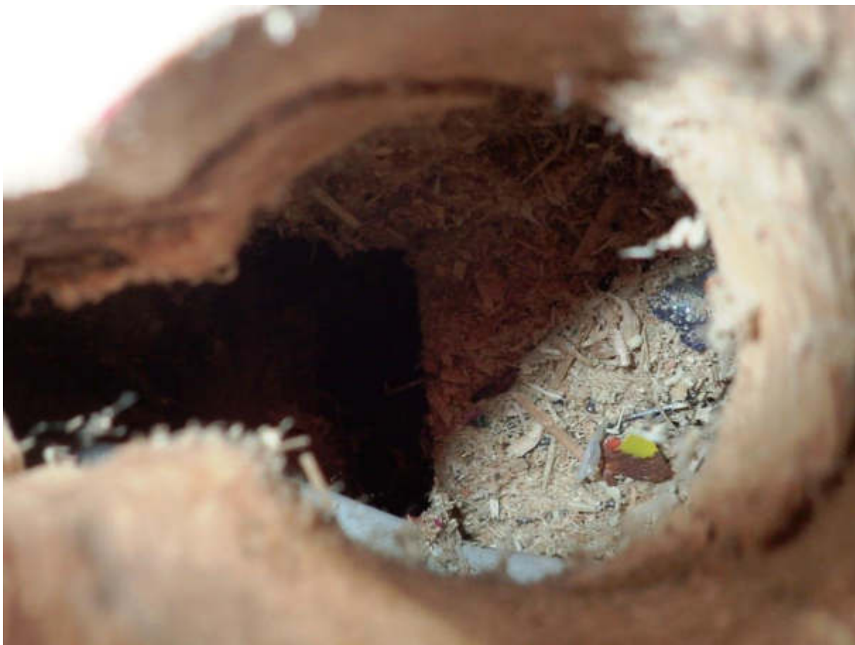
Figur 111 Sløjdlokalet. Slidt trægulv. Ingen varmeisolering registreret i hul i gulvet.
