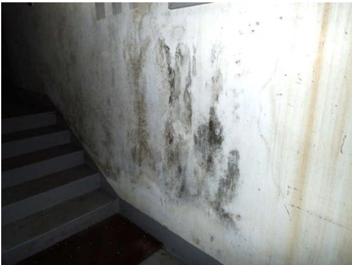
Figur 52 Kælderen. Synlige og massive forekomster af skimmelsvampevækst på vægge.
