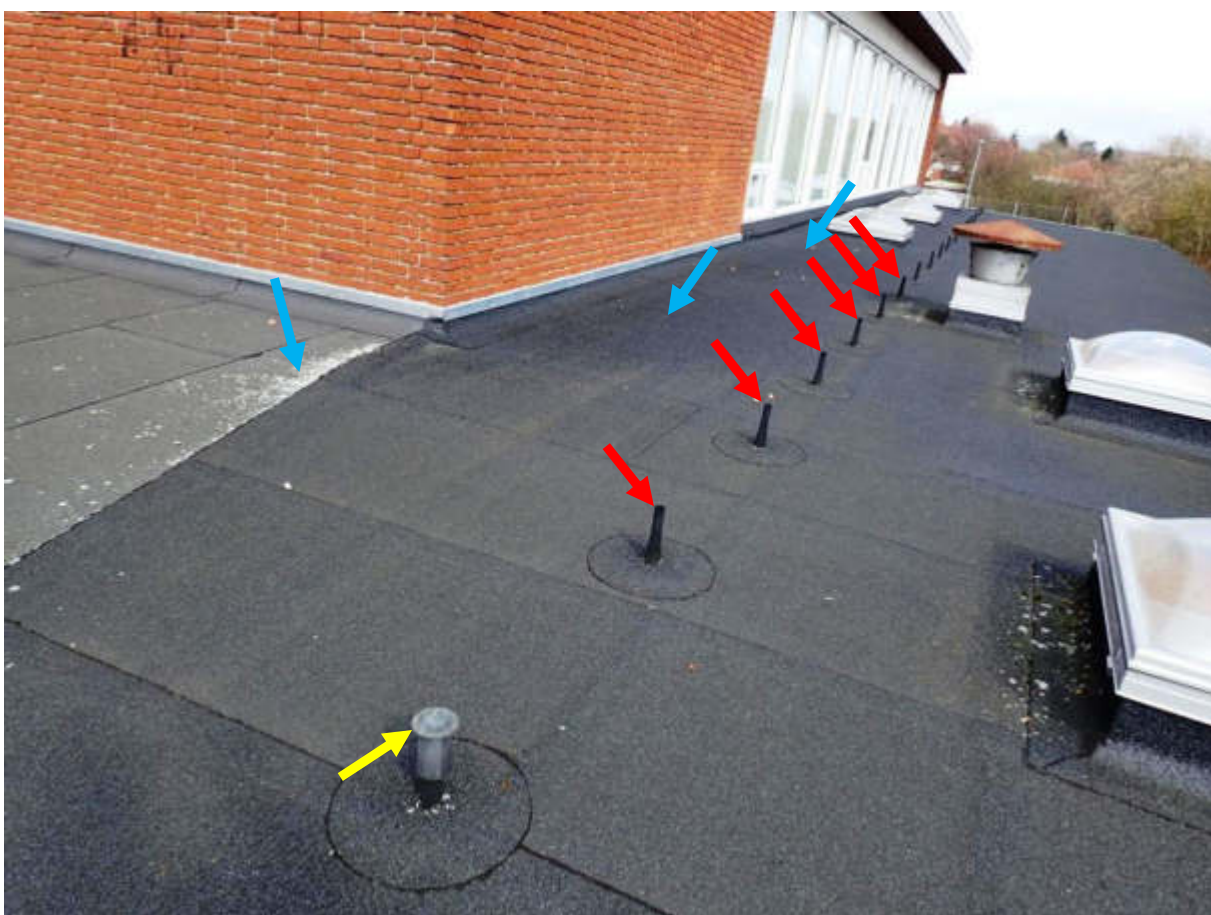
Figur 4 Tagfladen over omklædningsrum mv. Ventilering af tagkonstruktionen udført med tagghætter (gul pil). Tagghætter mangler adskillige (røde pile). Område med ringe /tvivlsom ventilation (blå pile).
