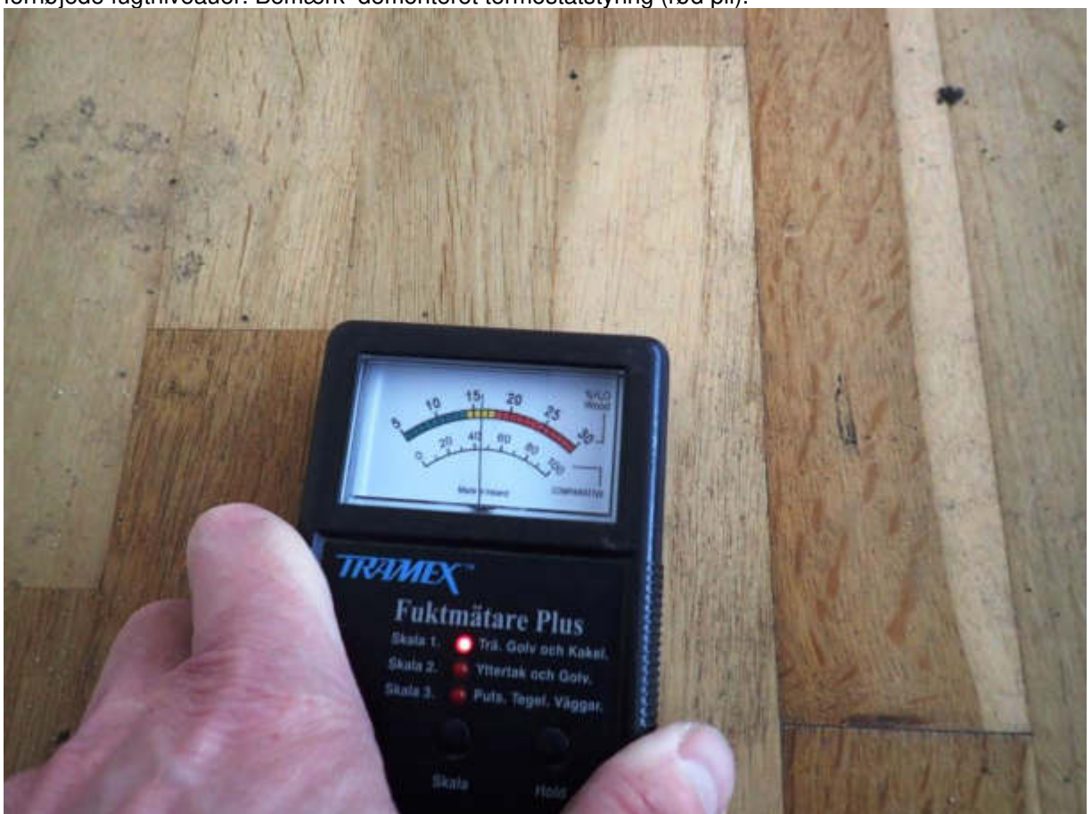
Figur 20 Mellembygning med kontorer. I trægulve blev registreret let forhøjede fugtniveauer.
