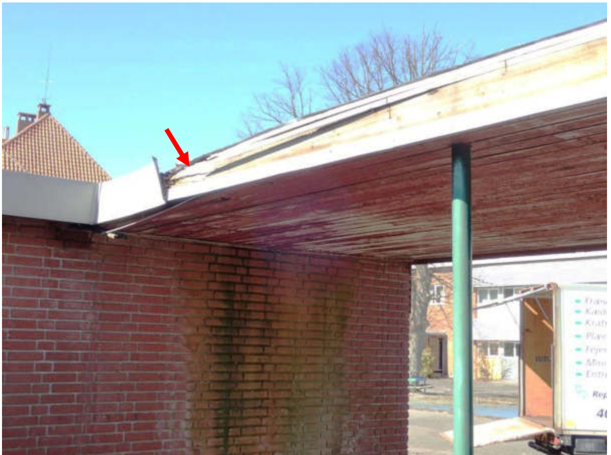
Figur 9 Tagkant mod sydøst. Nedbrudt træværk med forfald (rød pil).
