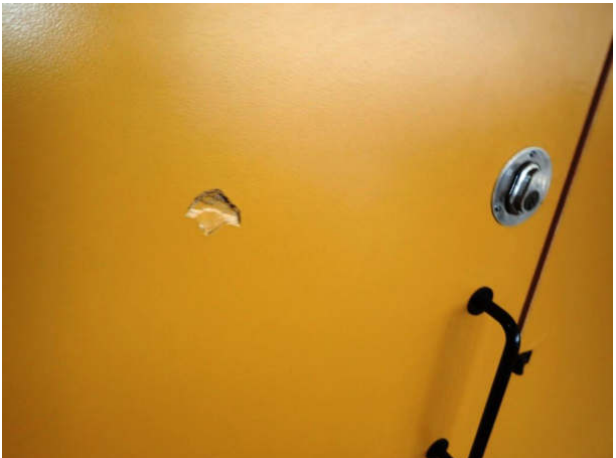
Figur 140 Skolekøkkenet. Skabslåger med skader.
