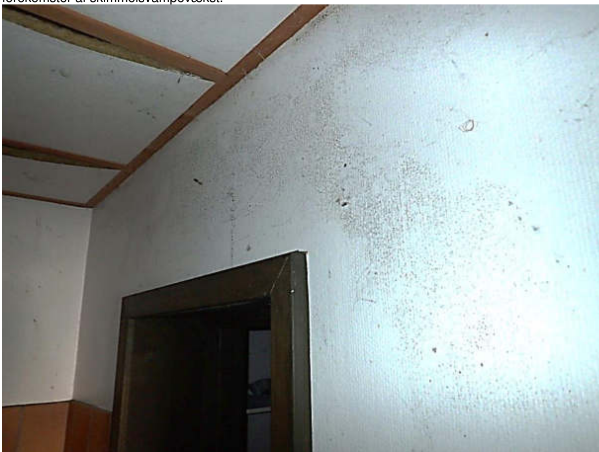
Figur 22 Opfugtede skillevægge med massive synlige forekomster af skimmelsvampevækst.
