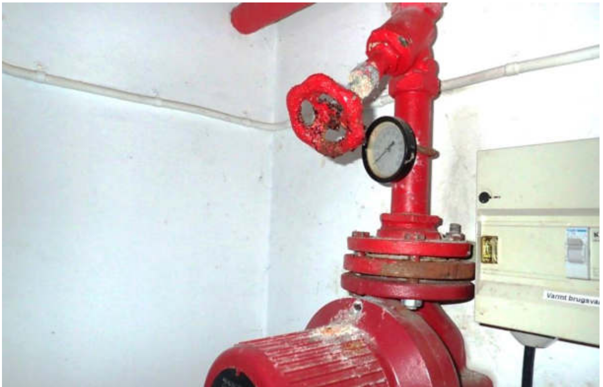
Figur 45 Kælderen. Vvs-installation med ir /korrosion.
