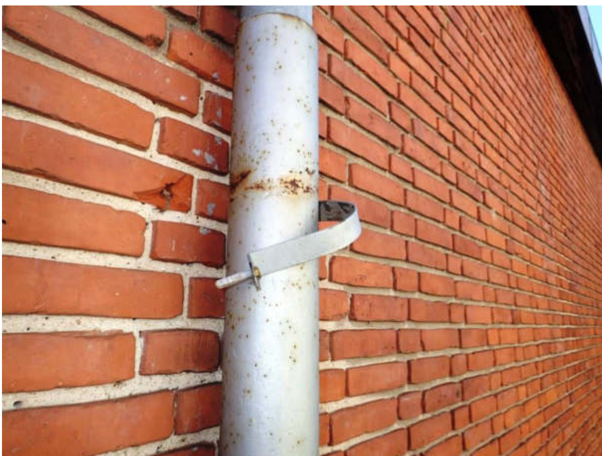
Figur 18 Facade mod nord. Løst nedløbsrør.
