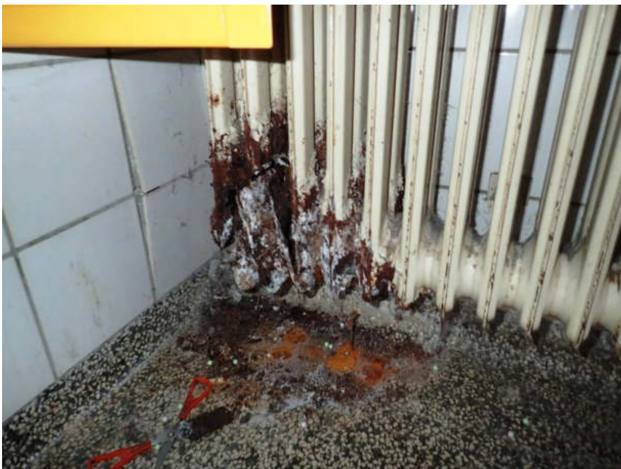
Figur 32 Rengørings- /depotrum. Radiator med korrosion og skade.
