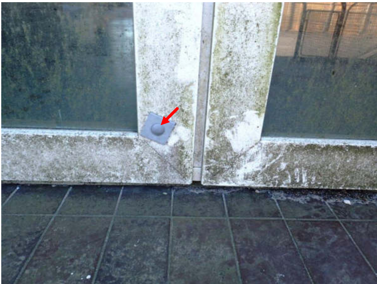
Figur 23 Facade mod nord. Gennemgående stang /bolt i dør (rød pil).
