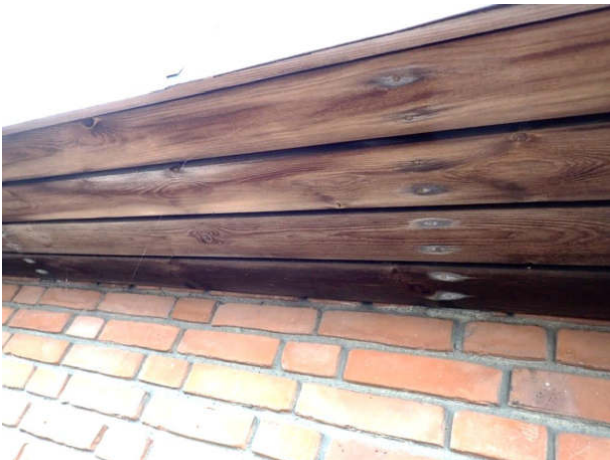
Figur 68 Udhænget. Der blev registreret fugtskjolder på træværk i udhænget.
