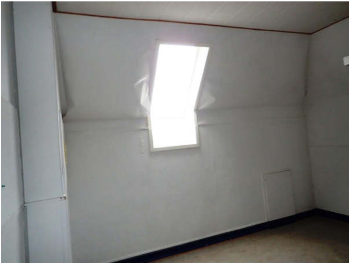
Figur 59 1.sal. Klasseværelse mod øst. Løst vægbeklædning ved ovenlysvinduet indikerer hyppig høje fugtniveauer.
