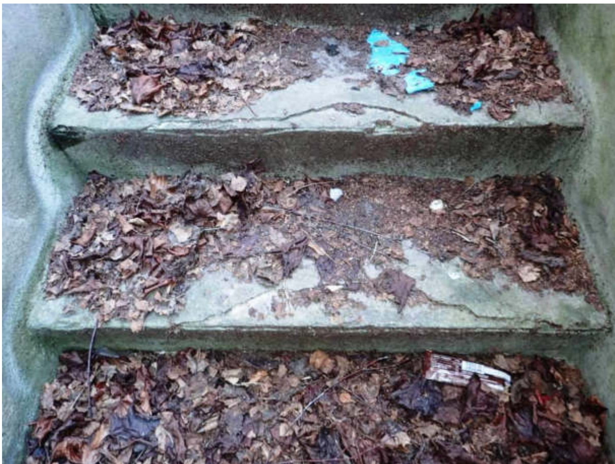
Figur 83 Facade mod nord. Kældertrappe med skadede overflader.
