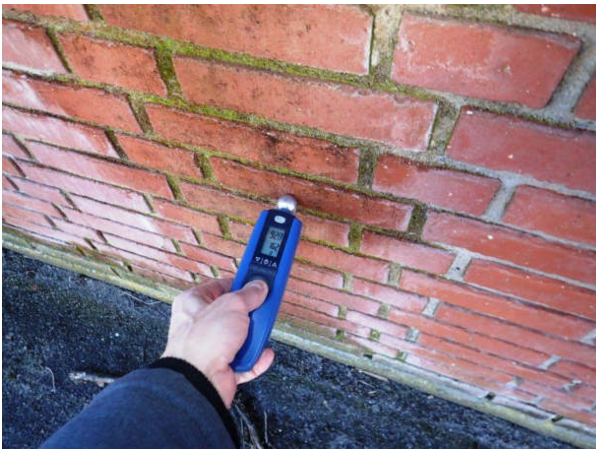
Figur 12 Facade mod nord. Forhøjede fugtniveauer (ca. 92 ud af 100 digits -vådt) og alger registreret på murværk.
