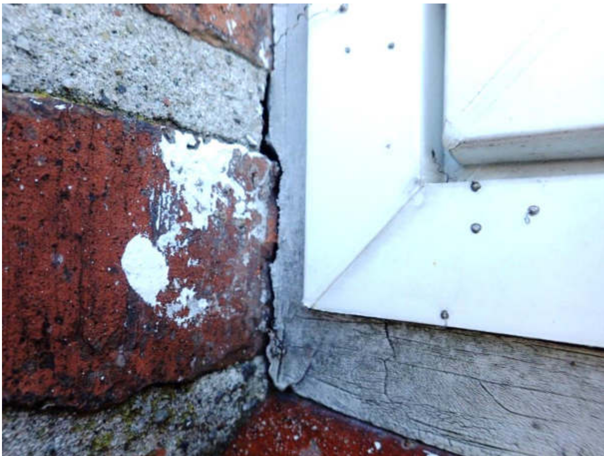
Figur 19 Facade mod vest. Fuge mellem vindue og murværk af ældre dato med manglende vedhæftning.
