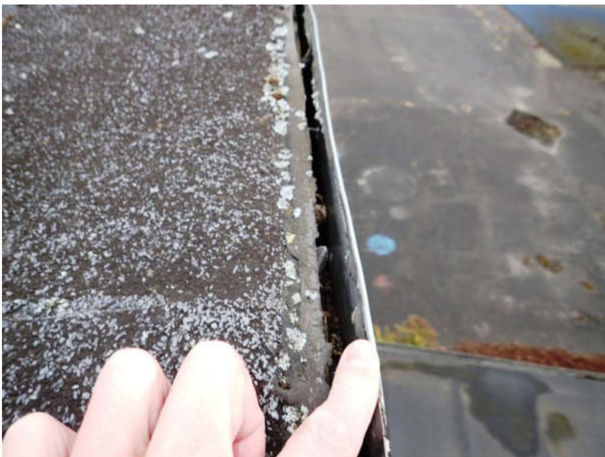
Figur 66 Taget. Revner mellem tagdækning og sternkant.
