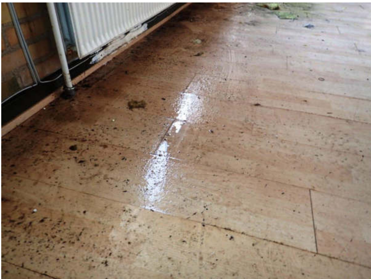
Figur 26 Kantinen. Blankt vand på gulvet.
