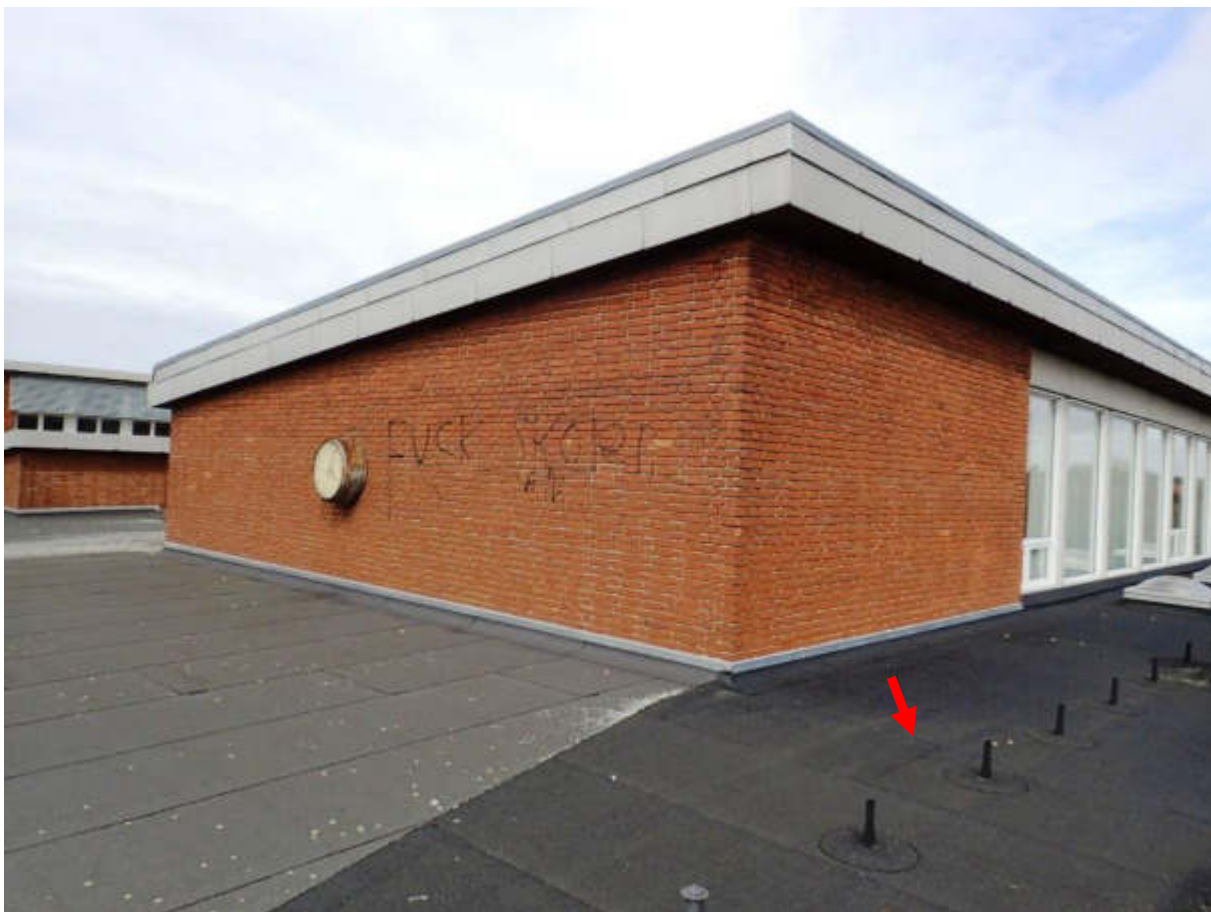
Figur 3 Bygningen og tagfladen set fra sydvest. Tagpap af nyere dato (rød pil).
