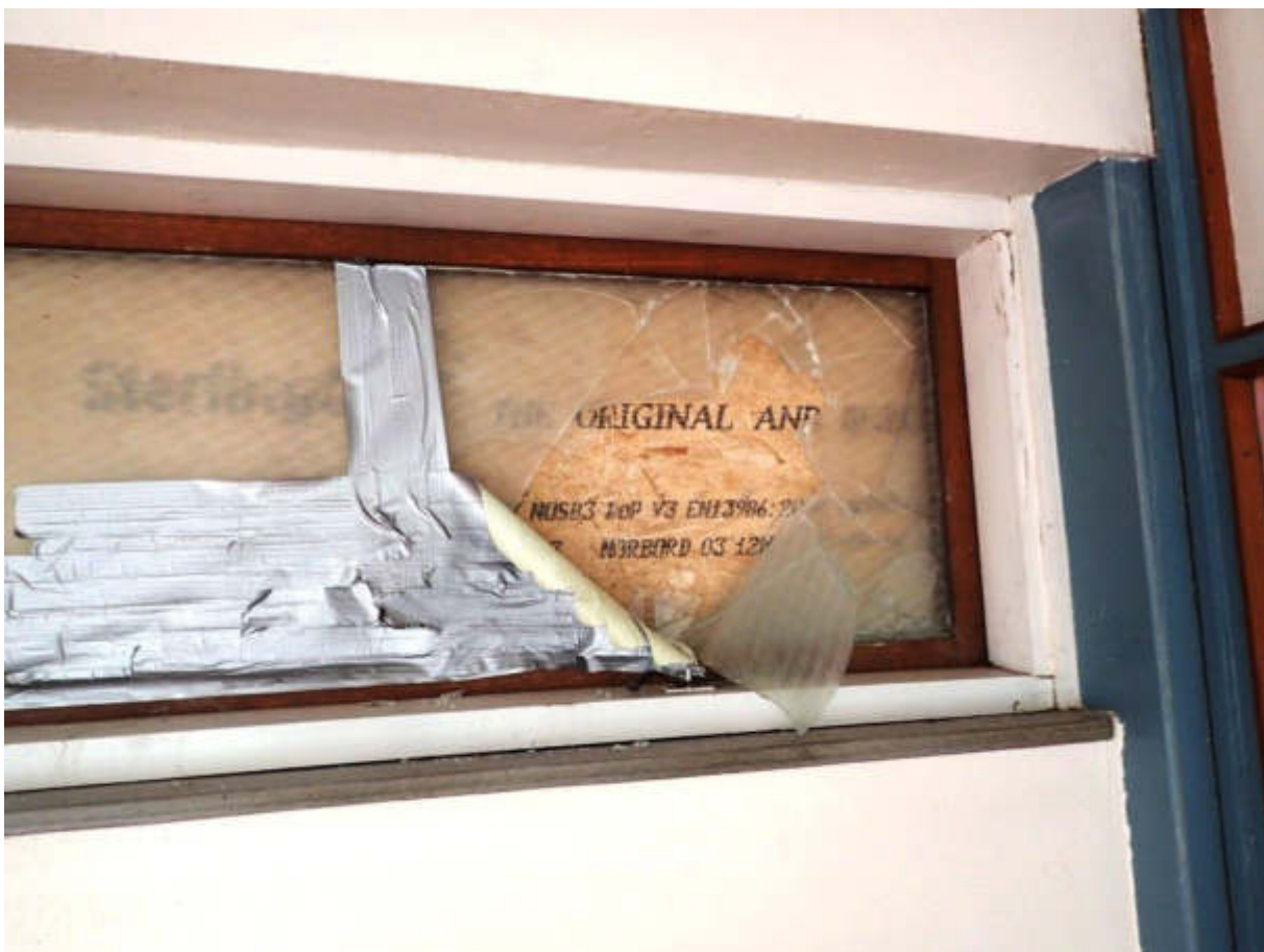
Figur 26 Omklædningsrummet. Vindue med skade og afdækket med tape og plade.
