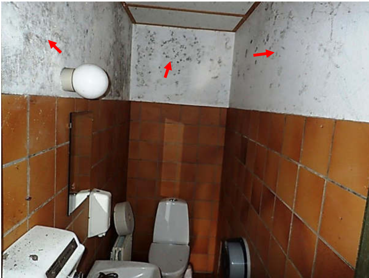
Figur 39 Toilet. Opfugtede konstruktioner med massive synlige forekomster af skimmelsvampevækst. (røde pile). Herunder BBR-oversigtsfoto.
