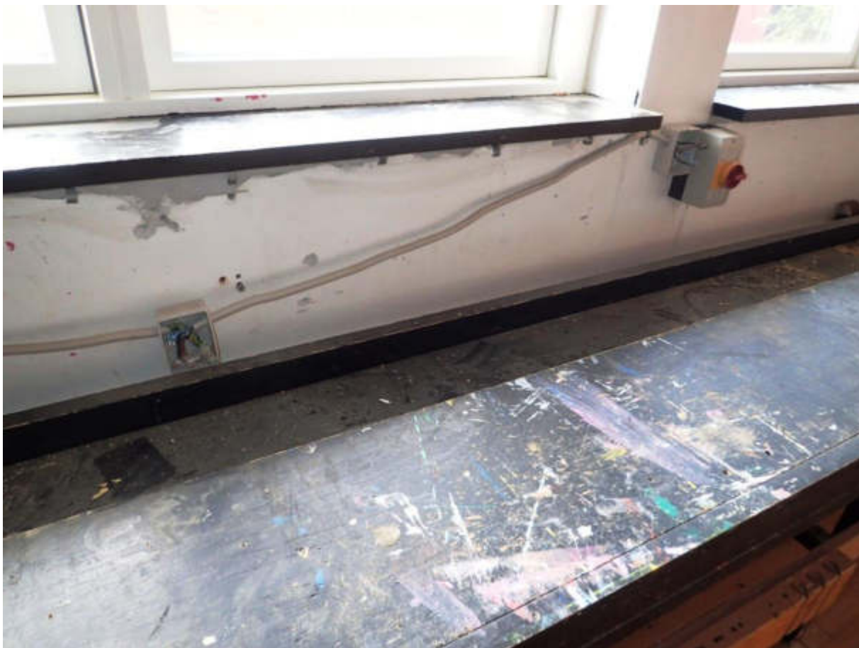
Figur 113 Sløjdlokalet. Løsthængende elinstallation med berøringsfare.
