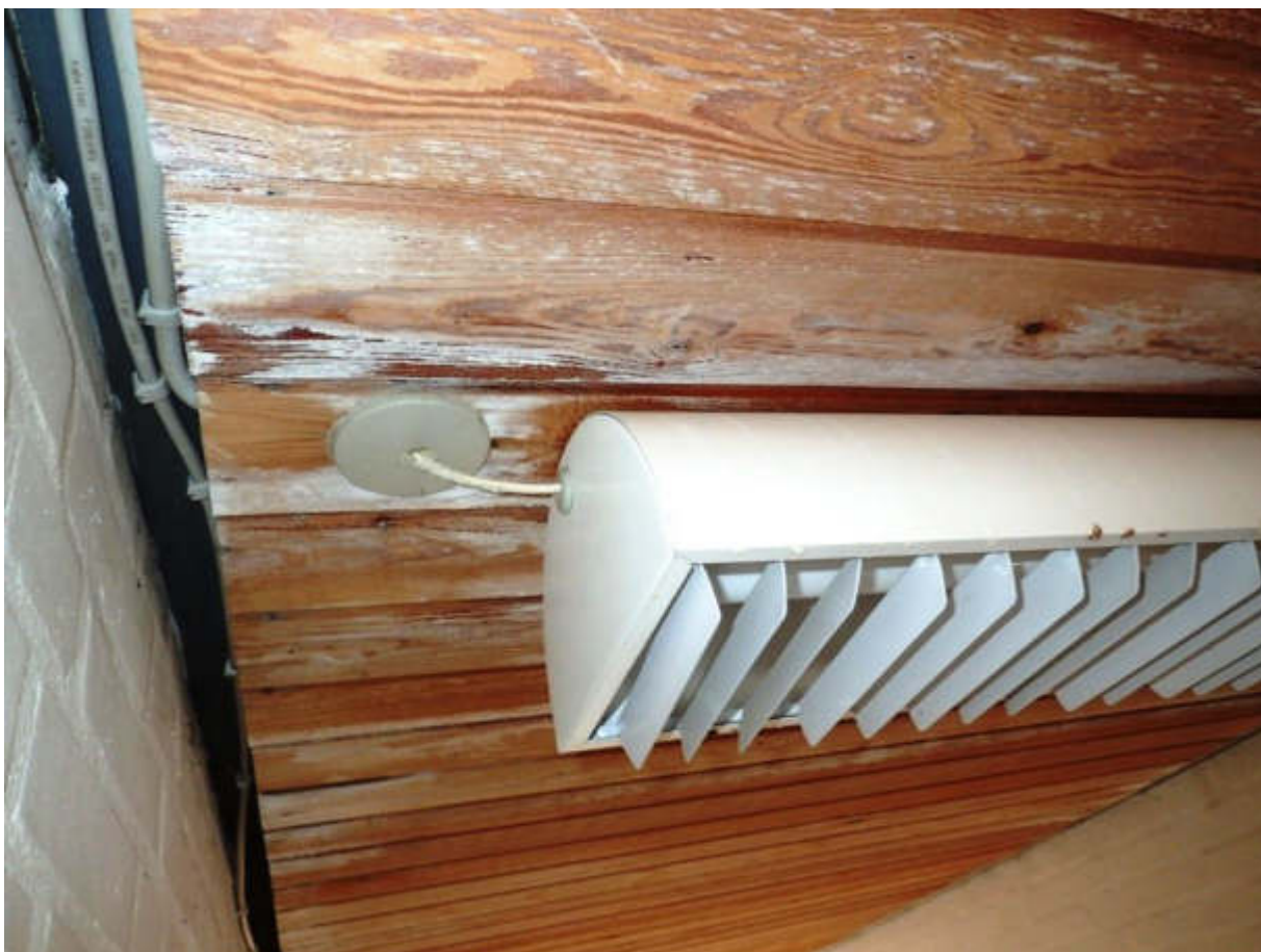
Figur 20 Loft i gangen. Synlige forekomster af skimmelsvampevækst indikerer utæthed i taget.
