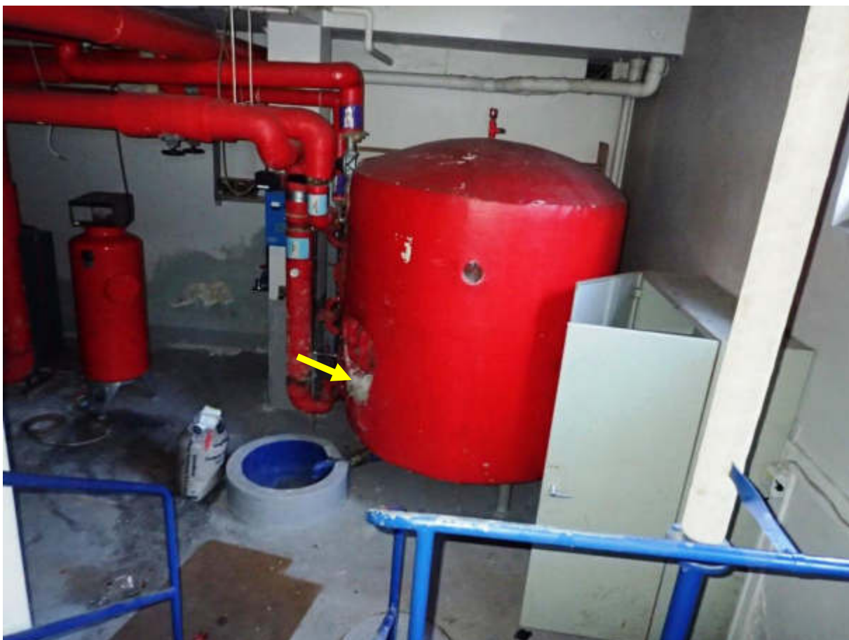
Figur 44 Kælderen. Beholder med skadet isolering. Prøve A blev udtaget ved gul pil. Ingen asbest registreret.
