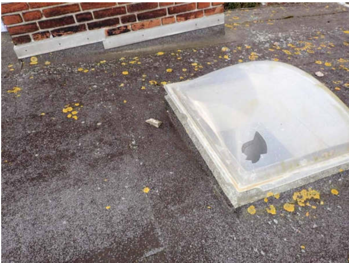
Figur 72 Taget. Ovenlyskuppel med skade.
