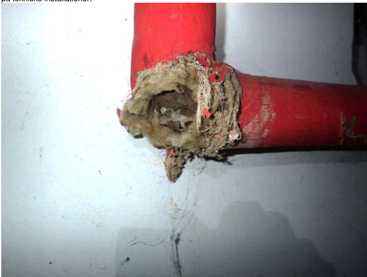
Figur 38 Kontor i kælderen. Skadet rørisolering med indhold af asbest (prøve B).
