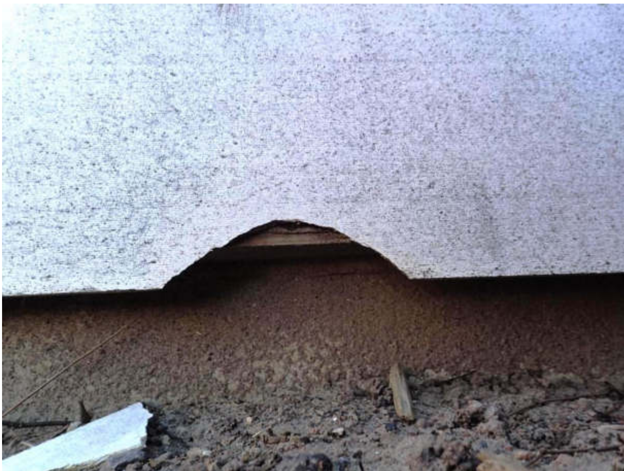
Figur 5 Mellemlbygning med kontorer. Facade mod vest med enkelte skader.
