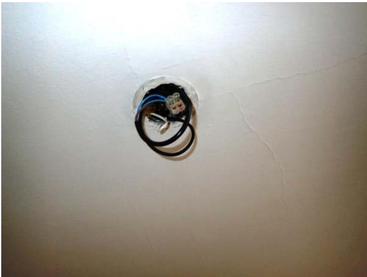
Figur 25 Mellemlbygning med kontorer. Elinstallation uden dæksel.
