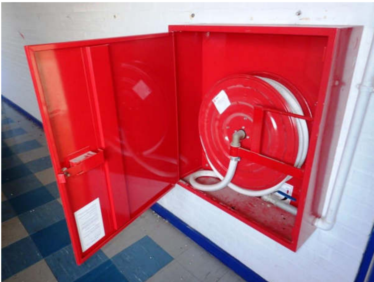
Figur 101 Gangen i stueplan. Slangevinde. Der blev ikke registreret indikationer på at slangevindere ikke var funktionsdygtige.
