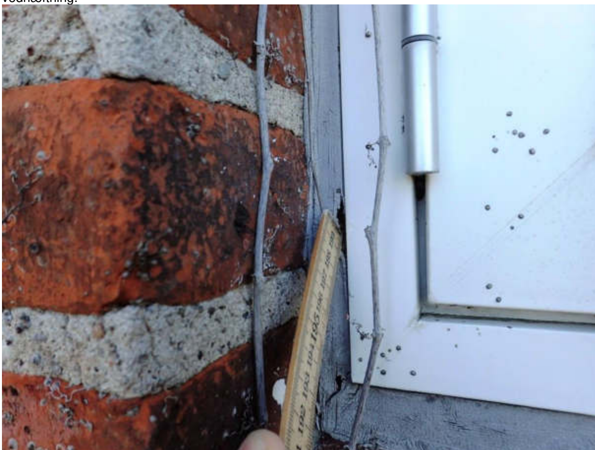
Figur 20 Facade mod vest. Fuge mellem vindue og murværk af ældre dato med manglende vedhæftning.
