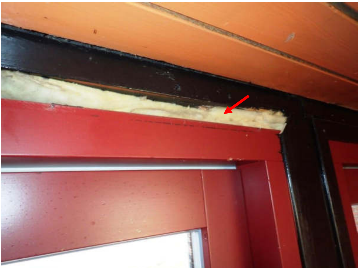
Figur 18 Yderdør mod skolegården med blotlagt mineraluld (rød pil).
