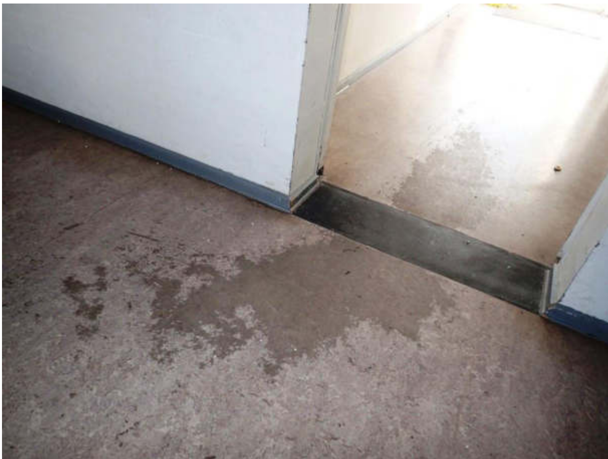
Figur 119 Stueetagen. Slidte gulvbelægninger.
