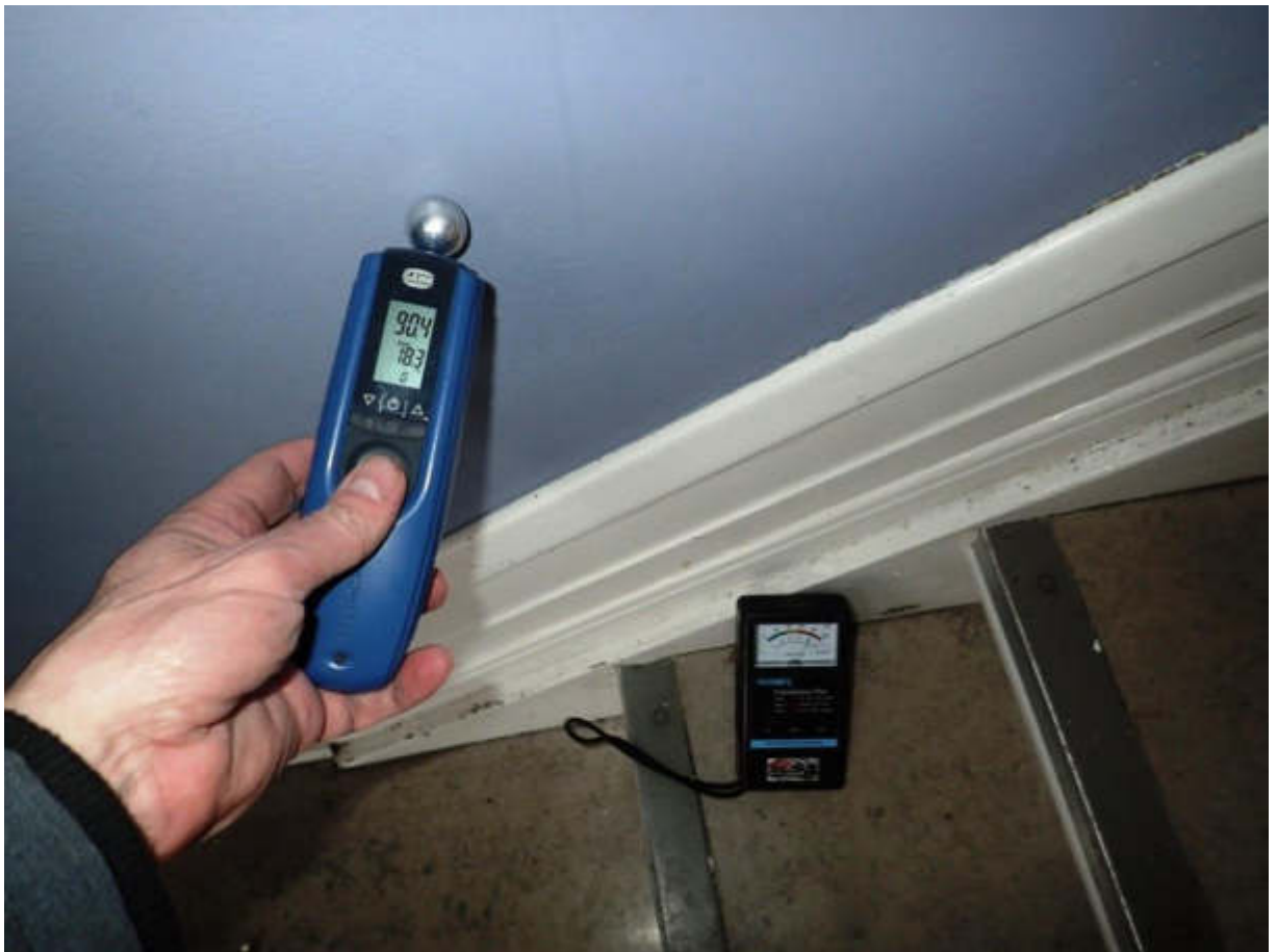
Figur 53 Trapperummet mod øst. Forhøjede fugtniveauer registreret i vægoverflade samt i træværk (ca. 90 ud af 100 digits -vådt).
