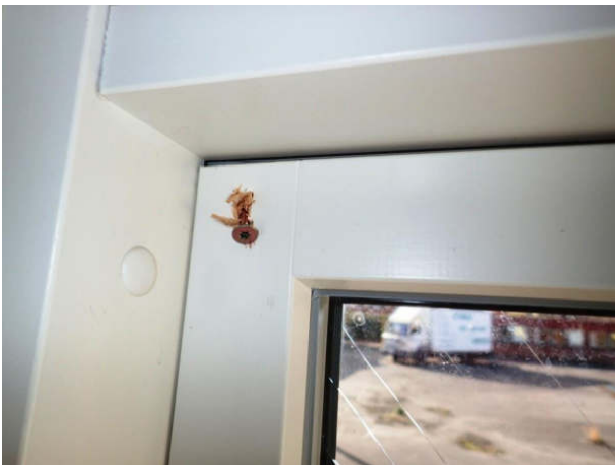
Figur 108 Klasseværelse 14. Vindue med smadret rude og ramme fastgjort med skrue.
