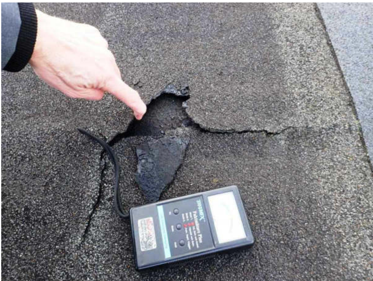
Figur 8 Tagfladen. Tagpap med skade.
