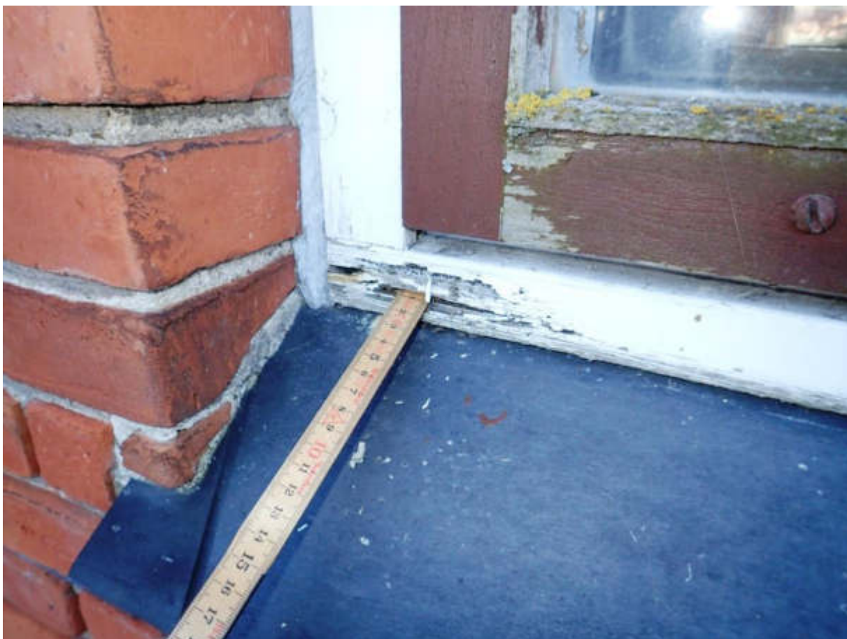
Figur 90 Facade mod nord. Vindue af ældre dato med nedbrudt træværk og begyndende forfald.
