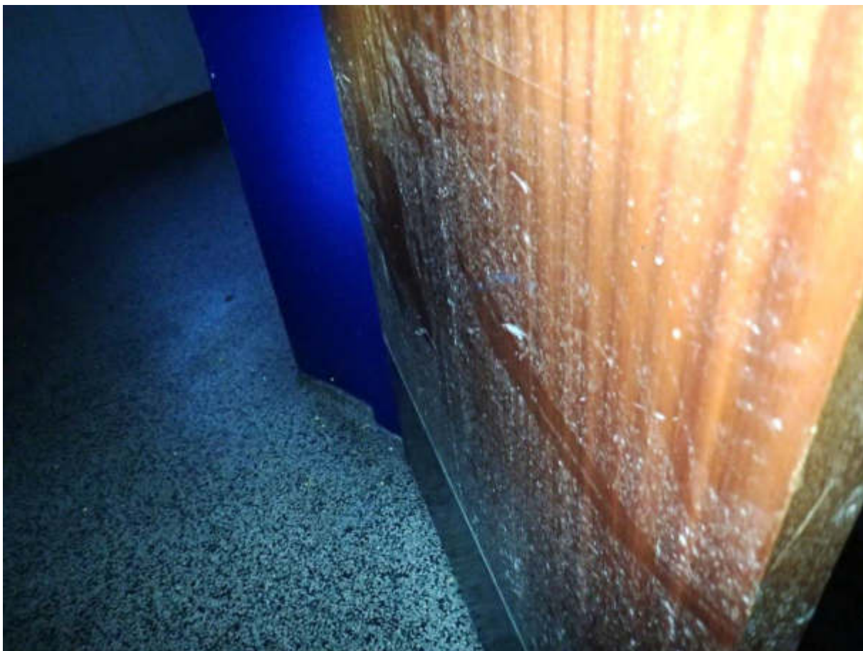
Figur 33 Dør mod kælderen. Synlige forekomster af skimmelsvampevækst.
