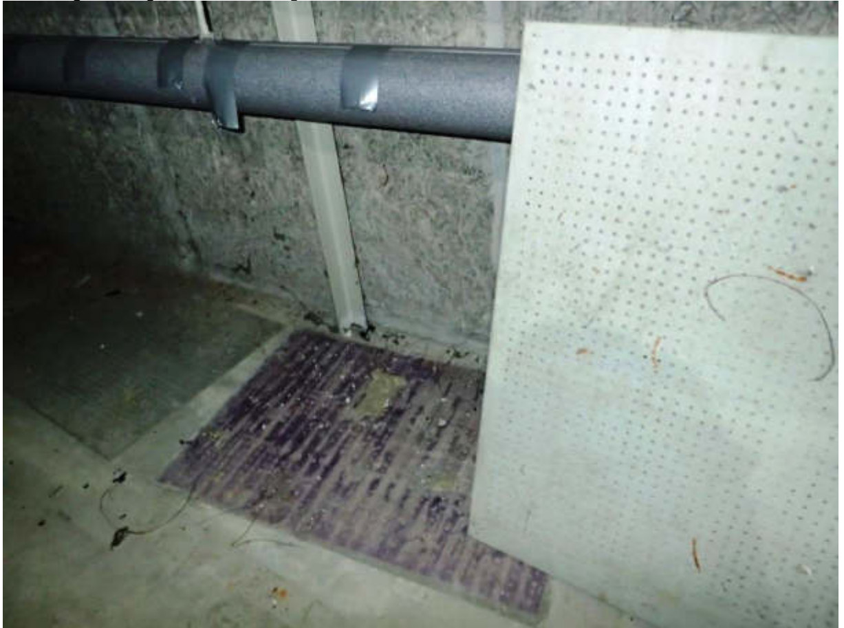
Figur 29 Kælderen. Enkelte (intakte) loftplader blev registreret stående løst på gulvet. Vurderingsmæssigt med indhold af asbest. Herunder BBR-oversigtsfoto.
