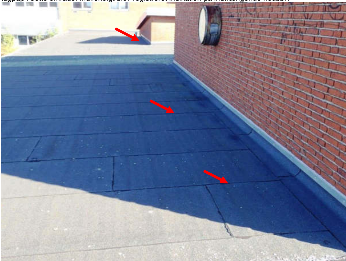
Figur 4 Områder i tagflader med tvivlsom ventilering og med risiko for u hensigtsmæssig skimmelsvampevækst (røde pile).
