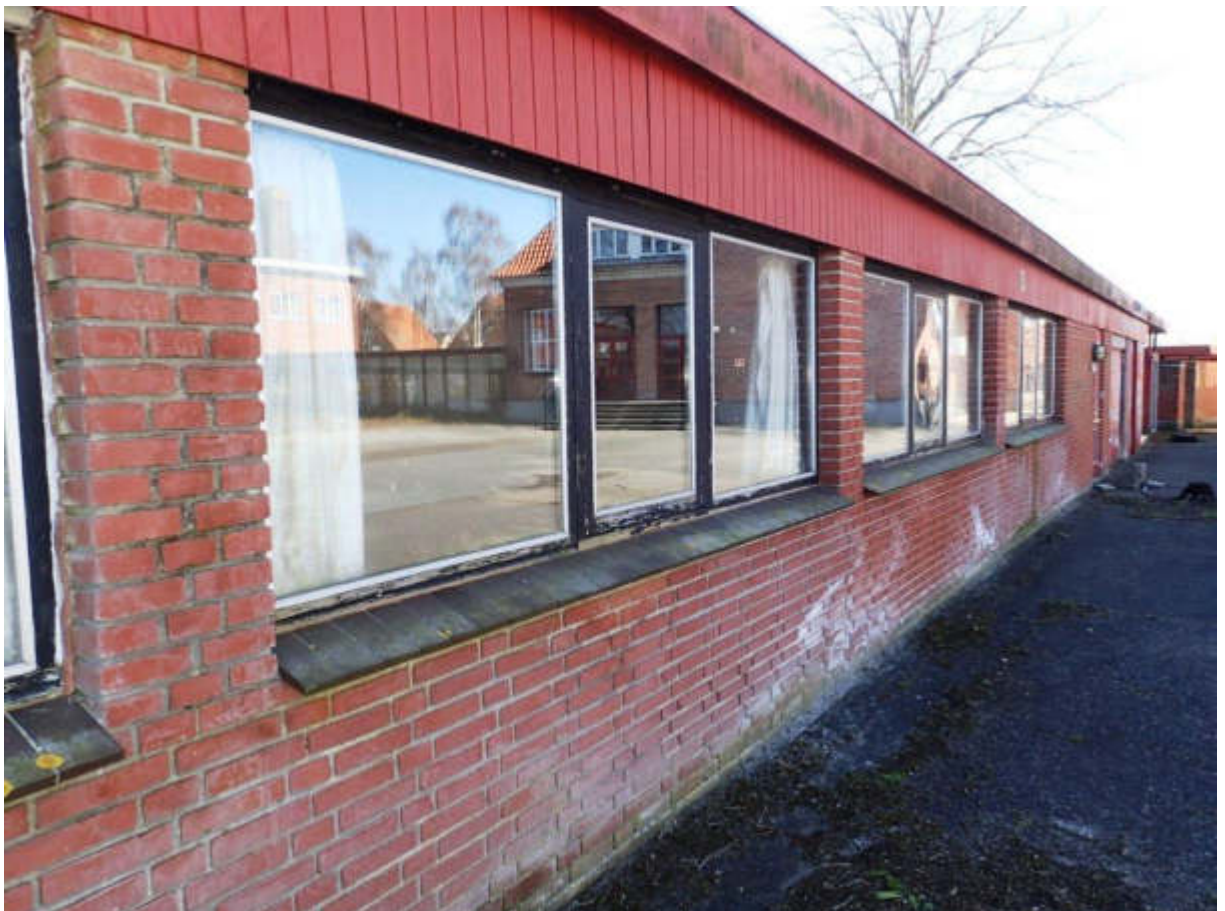
Figur 10 Facade mod nord /skolegården. Fugtskjolder flere steder på murværk.
