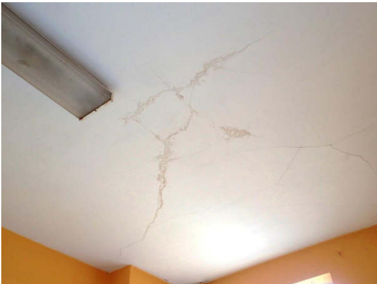
Figur 49 Lokale ved gymnastiksal. Skjolder på loftet indikerer indtrængende nedbør.
