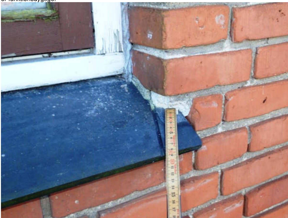
Figur 82 Facade mod nord. Enkelte steder manglede mørtelfuger, her ved sålbænk.
