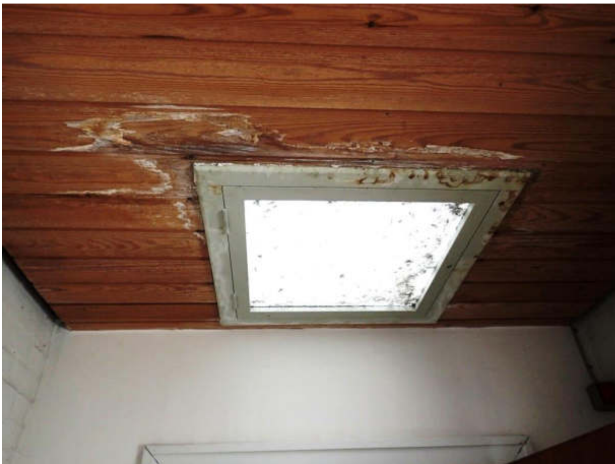
Figur 21 Gangen. Synlig skimmelsvampevækst og skjolder på loftet indikerer utæthed i taget.
