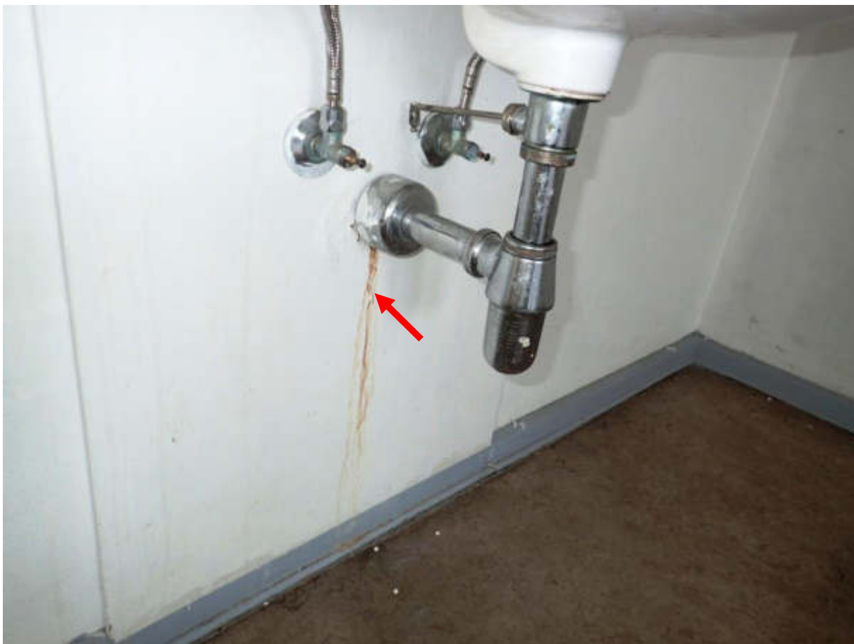
Figur 133 Håndvask i klasselokale med indikation på utæt afløbsinstallation (rød pil).
