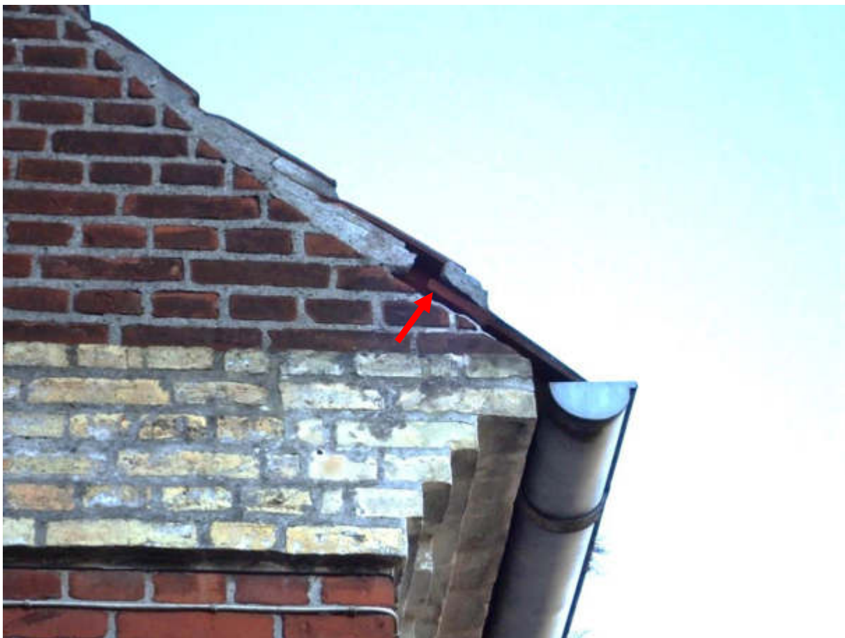
Figur 11 Facade mod nord. Forskelling mangler ved hjørne (rød pil).
