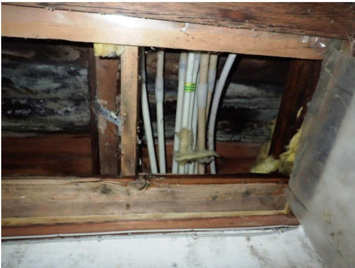
Figur 23 Toiletrum. Skadet loft- og tagkonstruktion med opfugtede konstruktioner samt massive synlige forekomster af skimmelsvampevækst.
