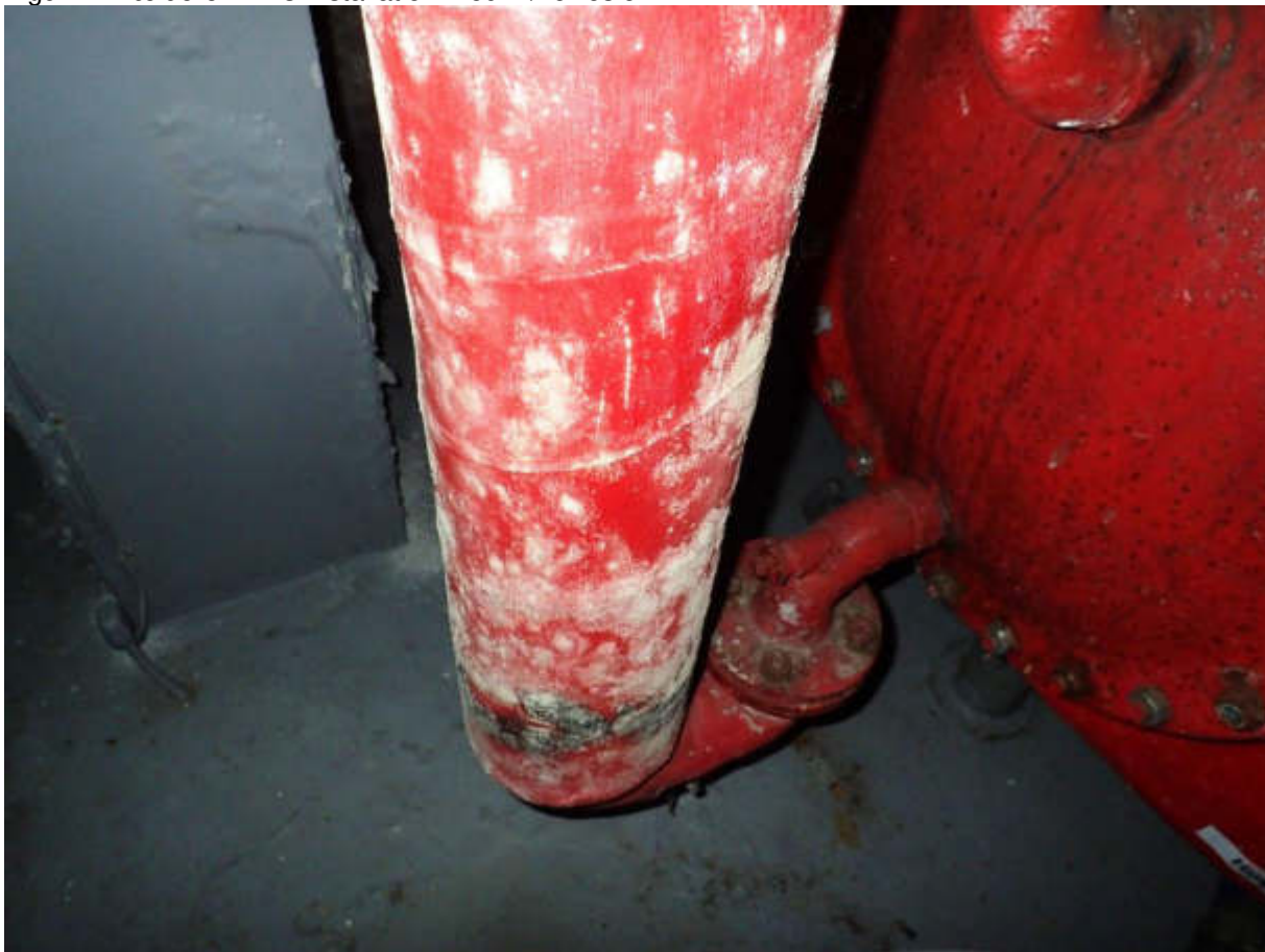
Figur 48 Kælderen. Synlige forekomster af, hvad der vurderes at være massiv skimmelsvampevækst på tekniske installationer.
