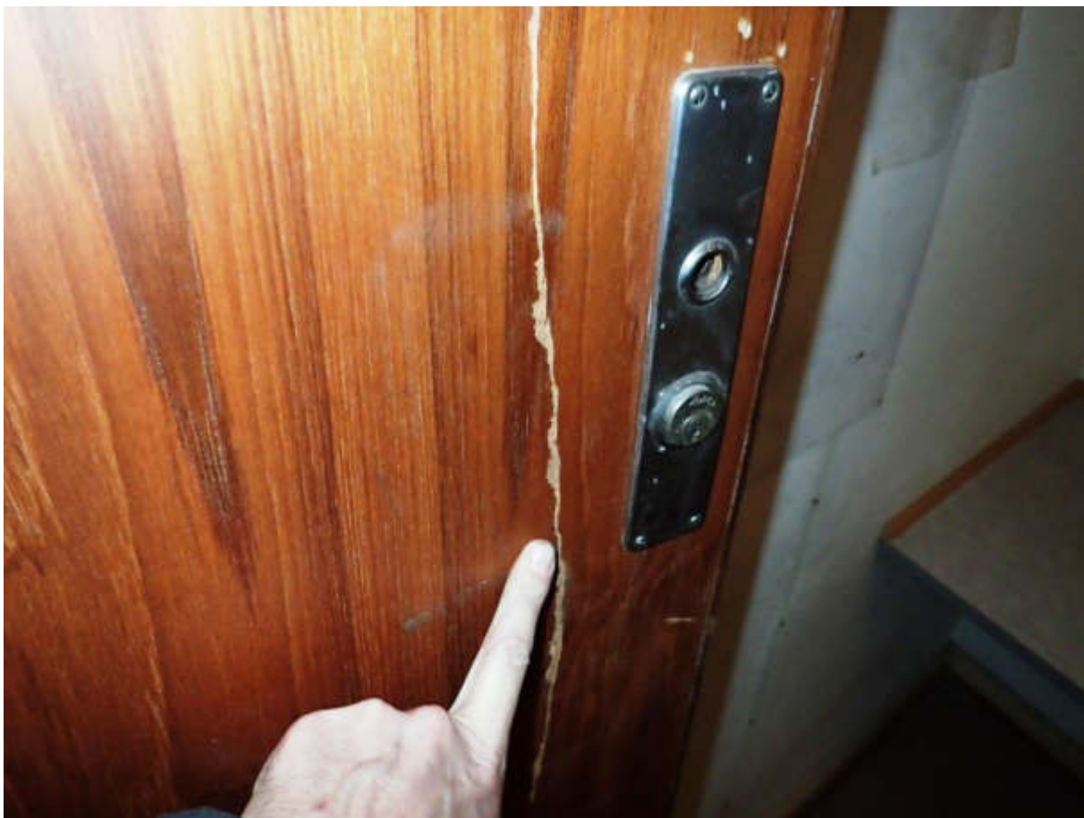
Figur 29 Mellembygning med kontorer. Dør med skade og manglende greb.
