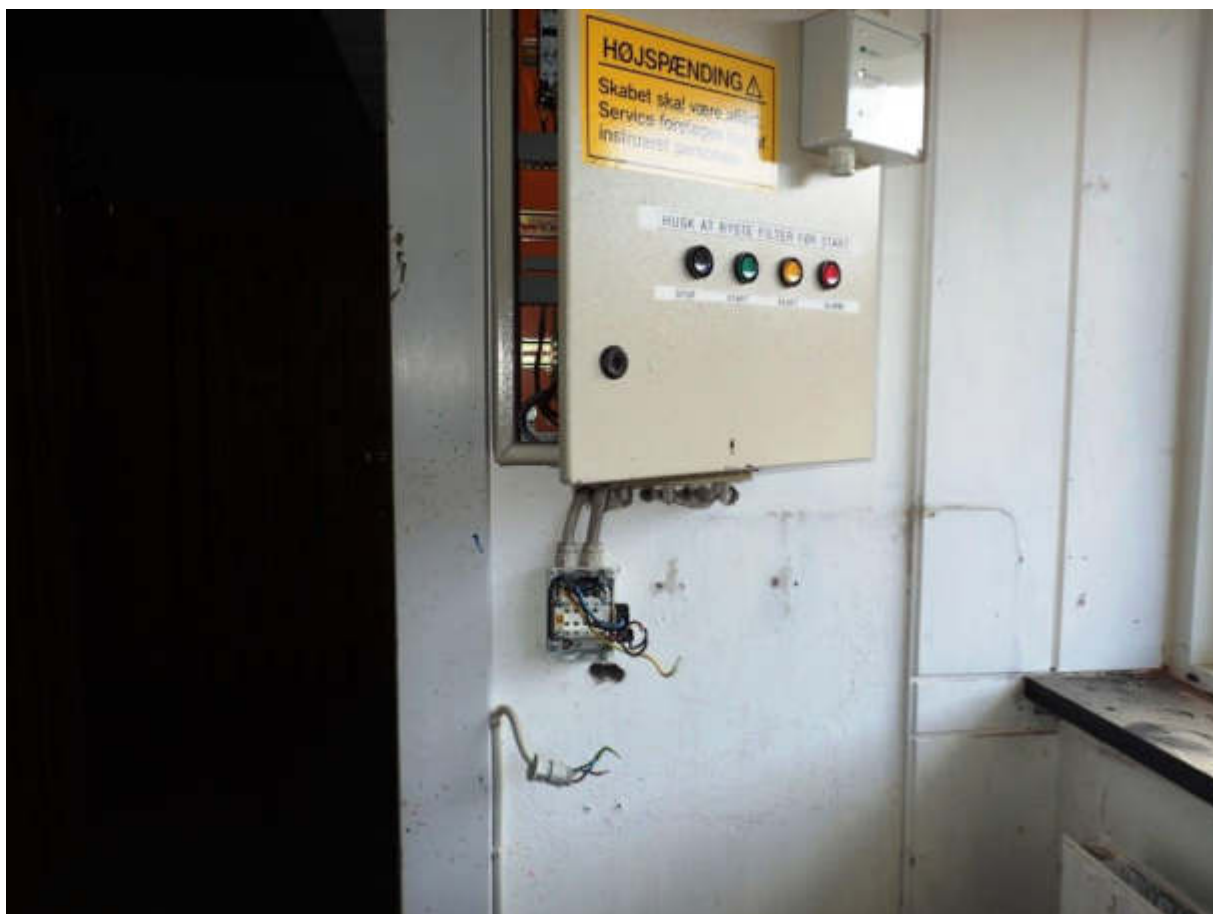
Figur 115 Sløjdlokalet. Åben og løsthængende elinstallation med berøringsfare.
