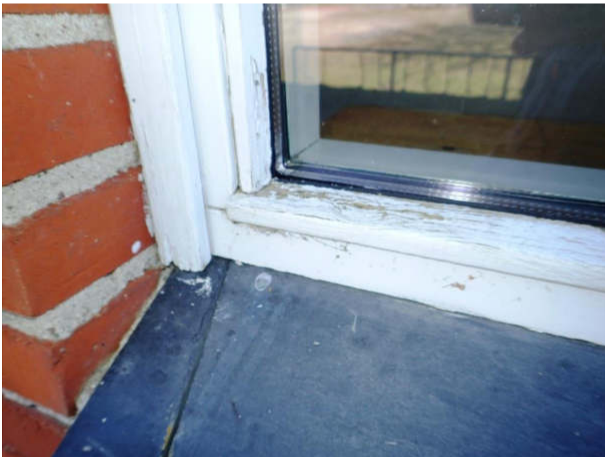
Figur 91 Facade mod nord. Vindue vurderingsmæssigt fra 1985 med ringe vedligehold.
