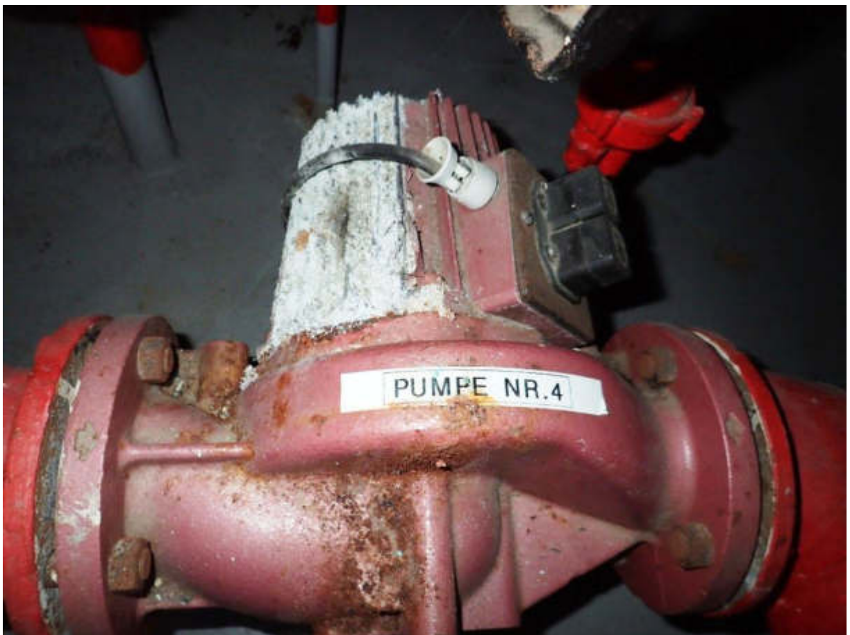
Figur 46 Kælderen. Vvs-installation med ir og korrosion.
