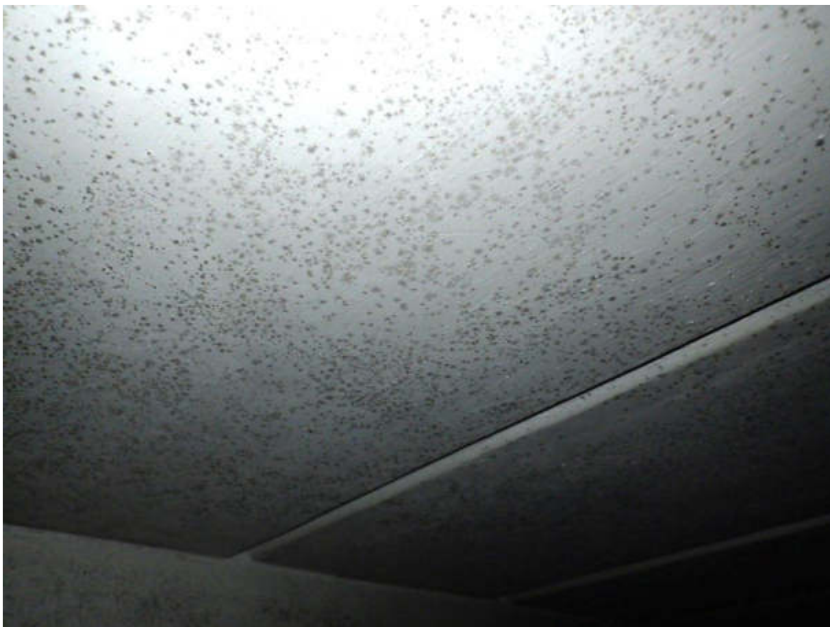
Figur 51 Kælderen. Synlige forekomster af skimmelsvampevækst på loftet.
