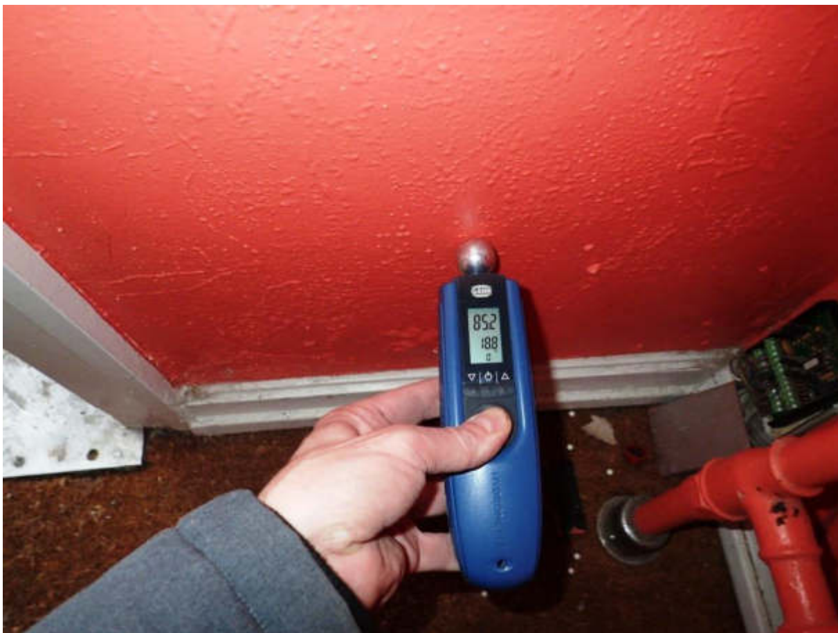
Figur 39 Stueetagen mod øst. Forhøjede fugtniveauer registreret i bygningen randzone (ca. 85 ud af 100 digits -vådt).
