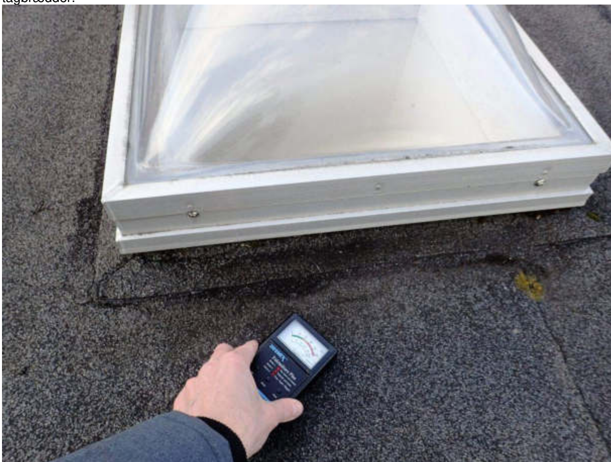
Figur 10 Tagfladen. Høje fugtniveauer registreret flere steder i tagfladen, her ved ovenlyskuppel.
