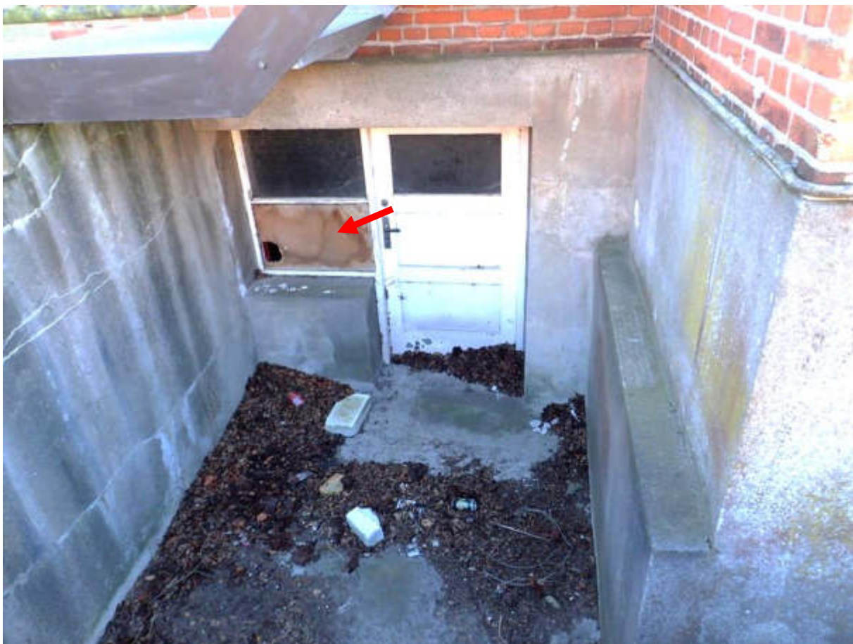
Figur 25 Udvendig kældertrappe med blade mv. Vindue afdækket med plade (rød pil).
