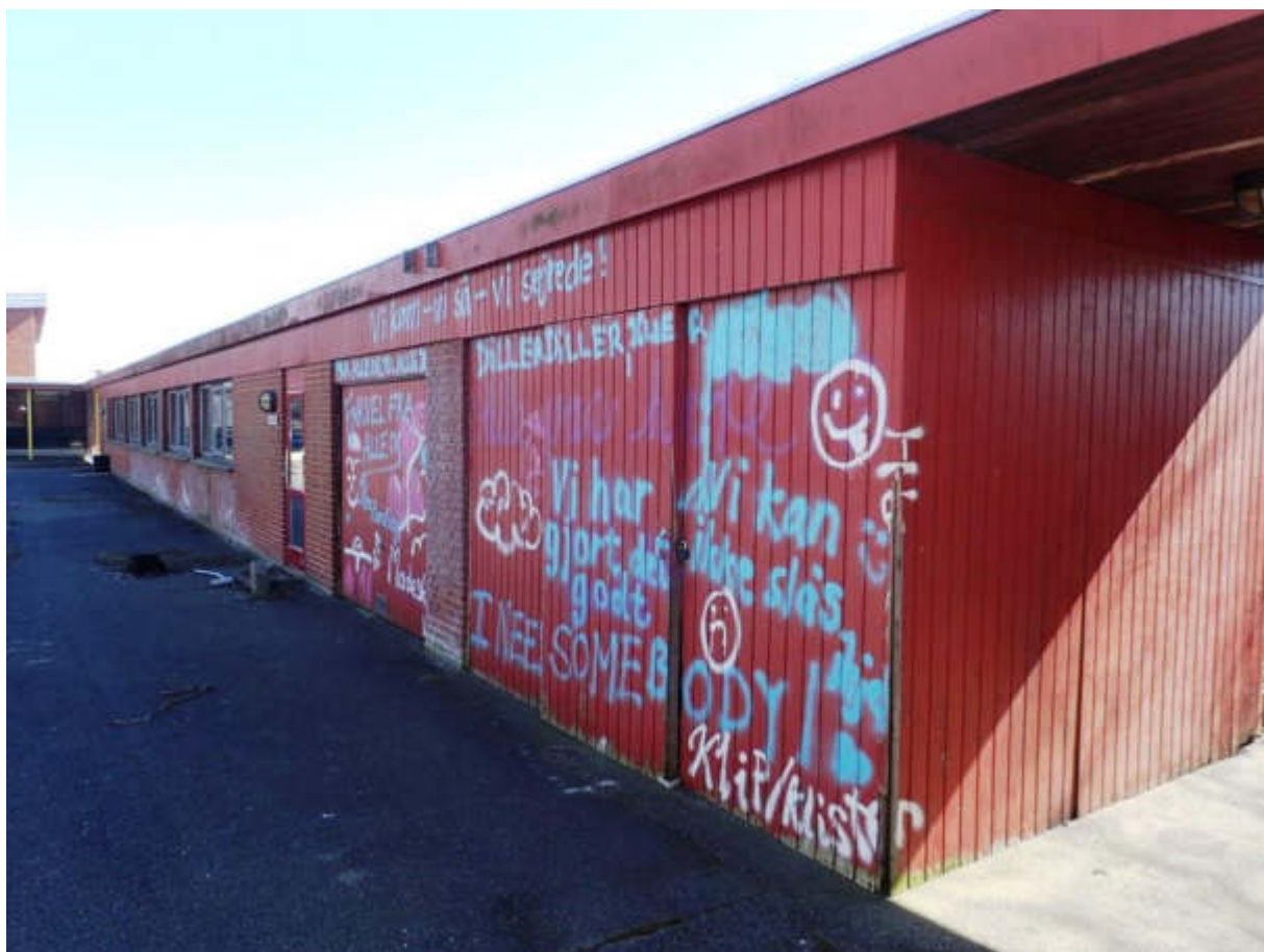
Figur 15 Facade mod nord. Graffiti på træværk samt træplader med begyndende nedbrud.
