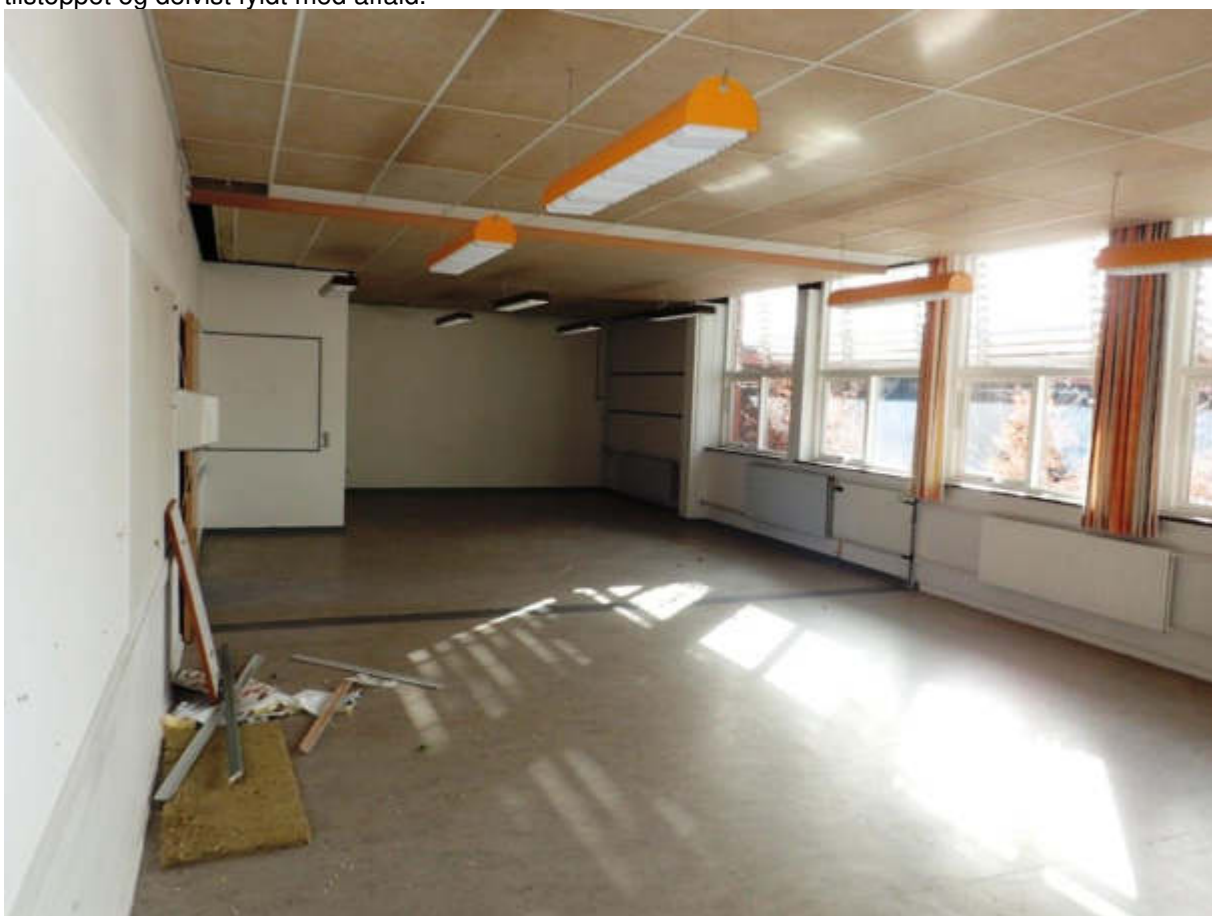
Figur 106 Klasseværelse 14. Løse loftplader af ældre dato.
