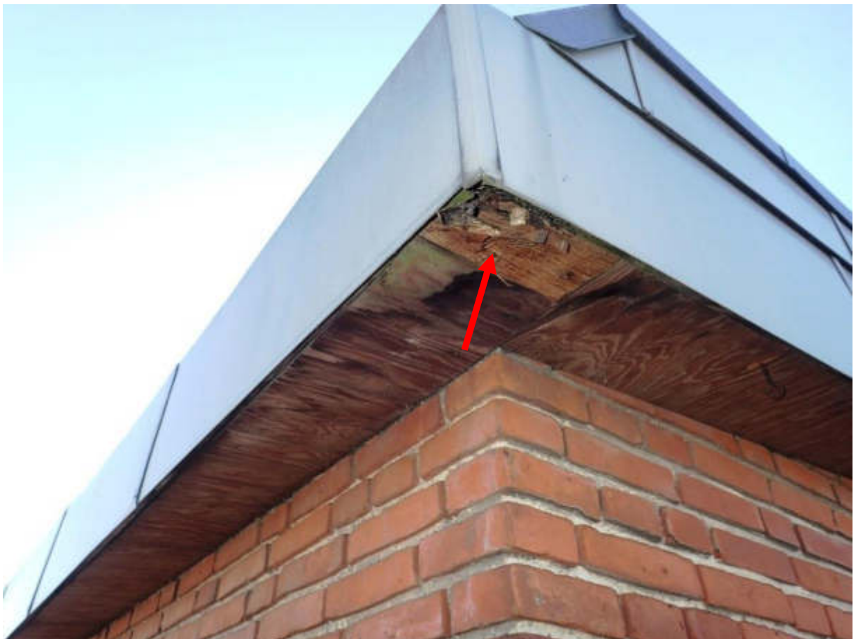
Figur 2 Bygningshjørne mod nordvest. Råd i udhæng indikerer utæthed i indbygget tagrende (rød pil).
