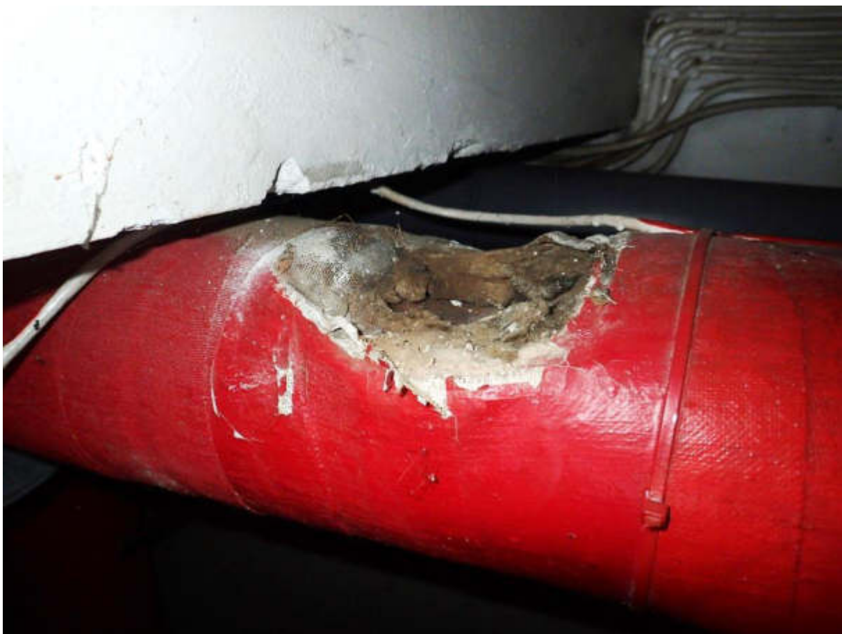
Figur 40 Kælderen. Skadet rørisolering.
