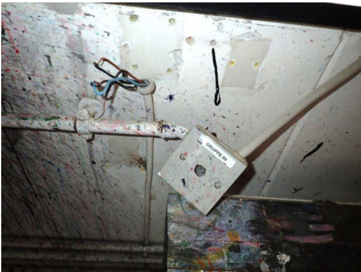
Figur 114 Sløjdlokalet. Løsthængende elinstallation med løse ledninger og berøringsfare.
