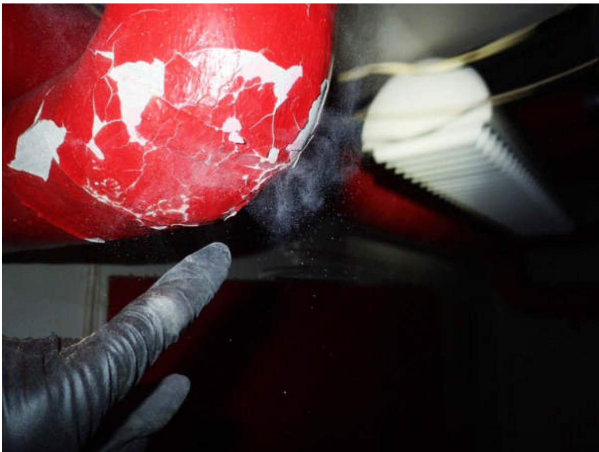
Figur 39 Kælderen. Rørbøjning med trykket /skadet rørisolering, antageligt med indhold af asbest.
