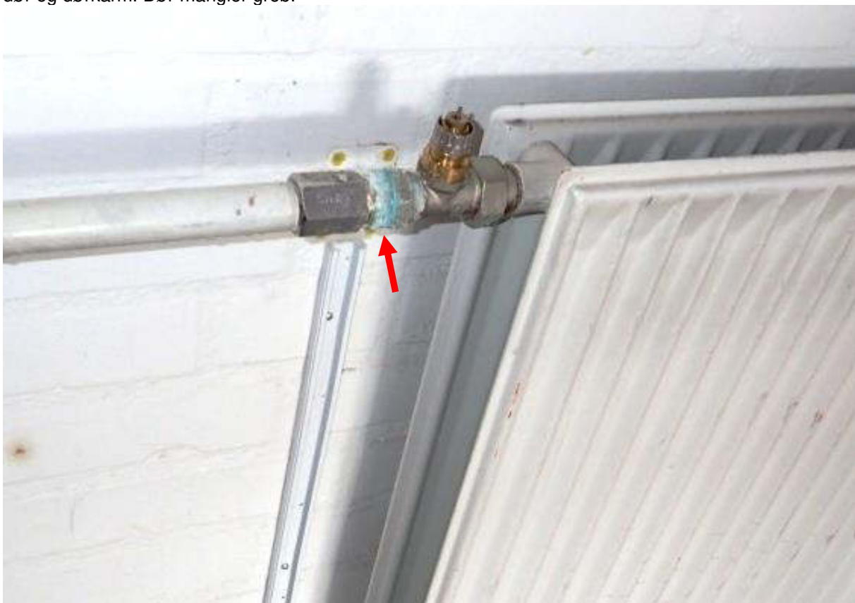
Figur 142 1. sal. Termostatstyring demonteret. Bemærk ir ved rørsamling (rød pil).
