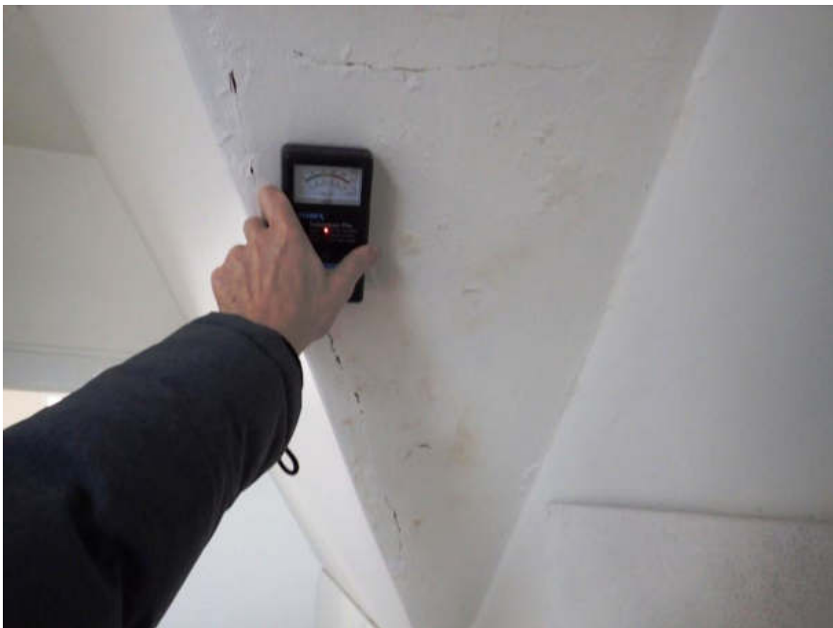
Figur 61 1.sal. Fugtskjolder og forhøjede fugtniveauer under skotrende indikerer utæthed i skotrende.
