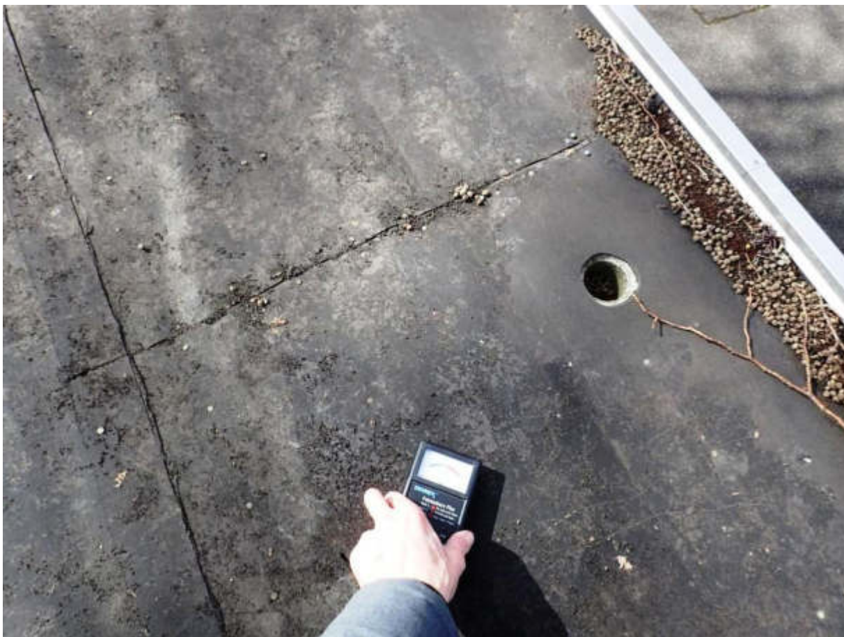
Figur 7 Tagfladen. Indvendigt nedløb. Forhøjede fugtniveauer registreret.
