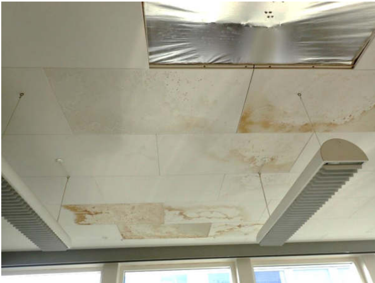
Figur 33 Undervisningslokale mod øst. Skjolder adskillige steder på loftet indikerer utætheder i taget.
