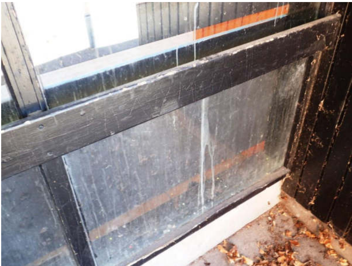
Figur 11 Facade mod vest /skolegården. Vinduespartier med et lags rude. Partier vurderes overvejende at være intakte om end med mindre skrammer o.l.
