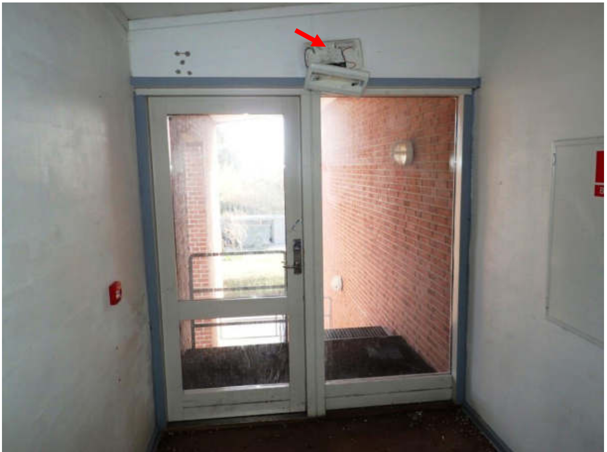
Figur 131 Gangen på 1.sal. Flugtvejsskilt og flugtvejsbelysning skadet (rød pil).
