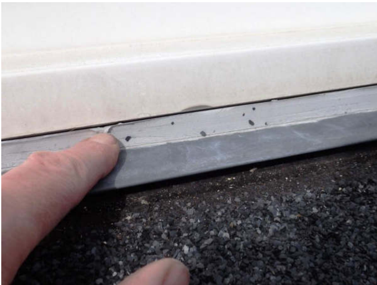
Figur 5 Facade mod syd. Vinduesfuger med ringe /tvivlsom vedhæftning.
