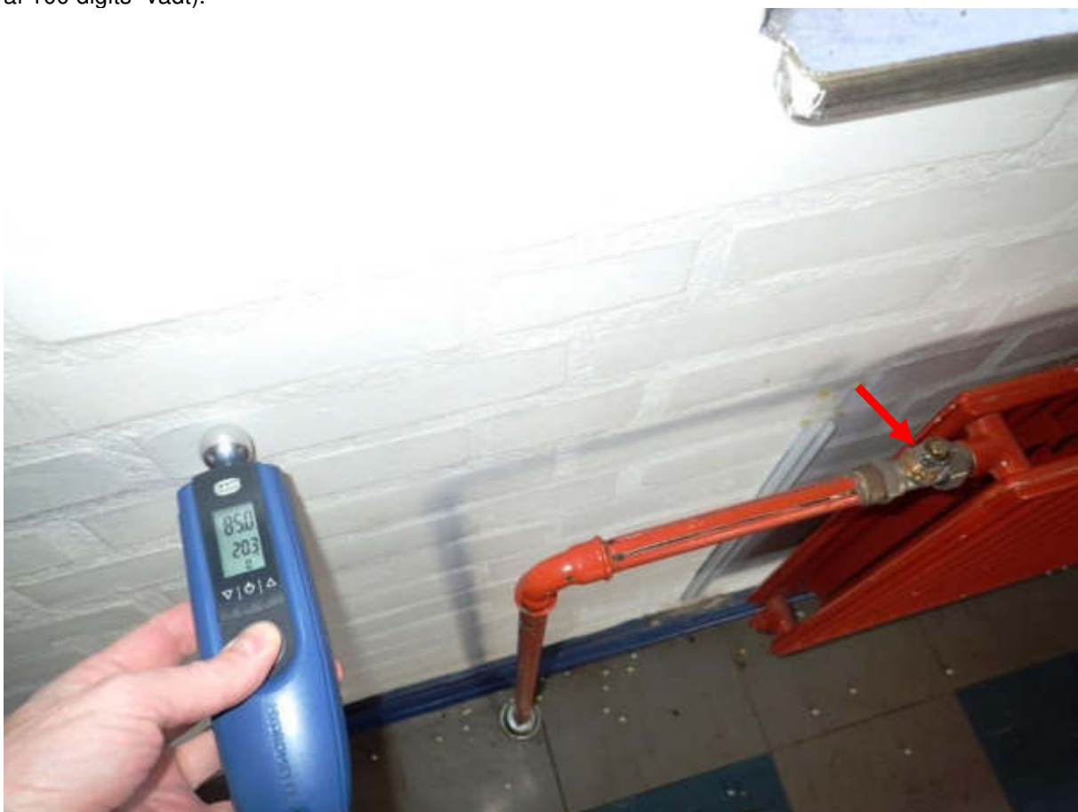
Figur 96 Gangen i stueplan. Forhøjede fugtniveauer registreret adskillige steder i ydervæg (ca. 85 ud af 100 digits -vådt). Bemærk termostat mangler på flere radiatorer (rød pil).
