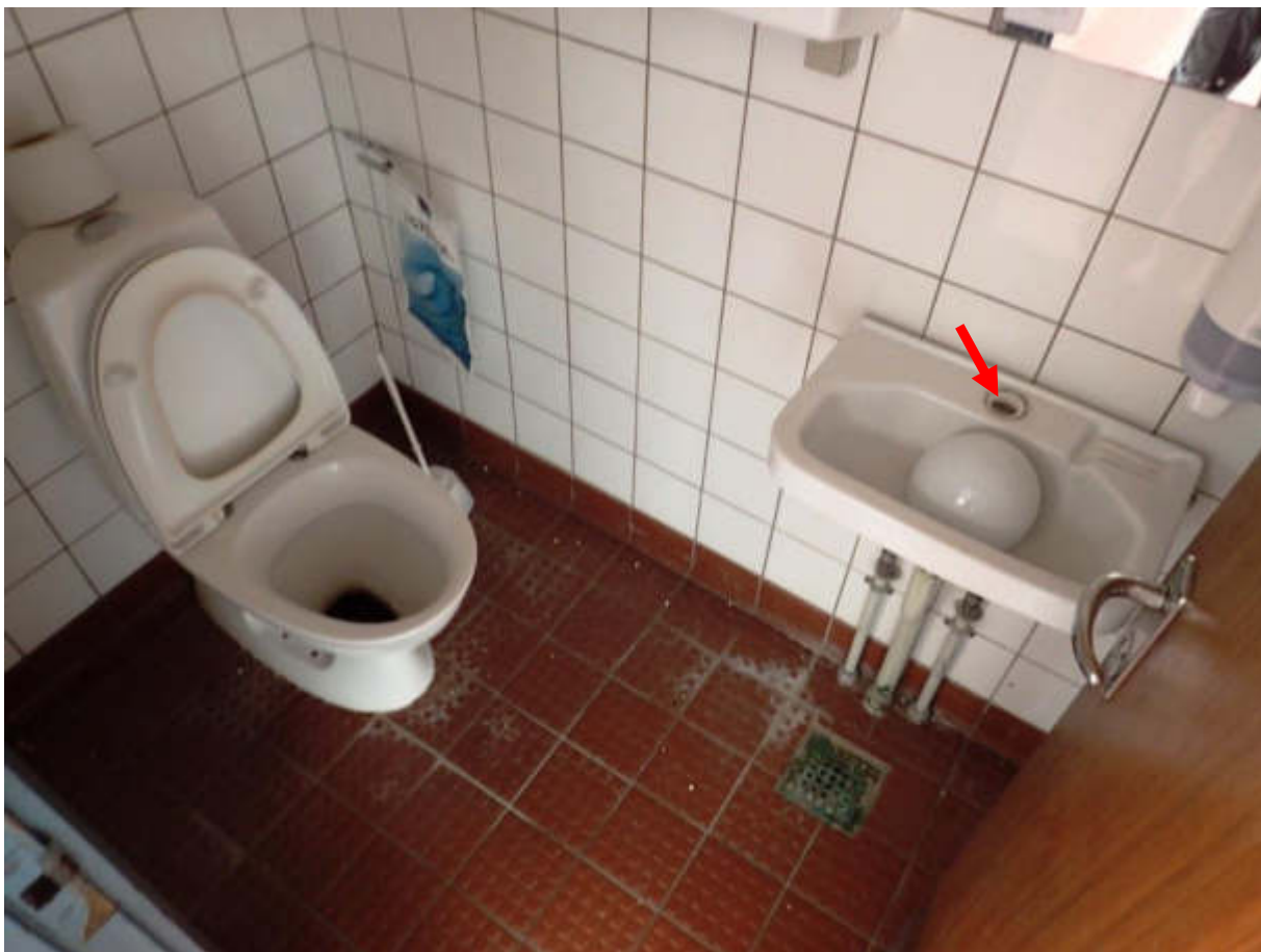
Figur 27 Toilet. Bemærk vandhane mangler (rød pil).
