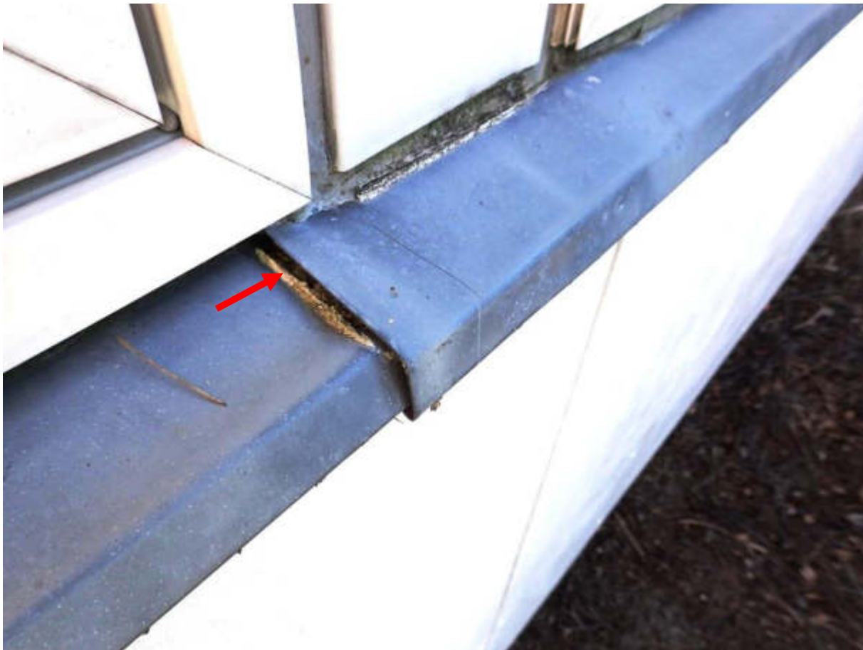
Figur 3 Mellemlbygning med kontorer. Facade mod vest. Sålbenk med åbninger og risiko for indtrængende nedbør (rød pil).
