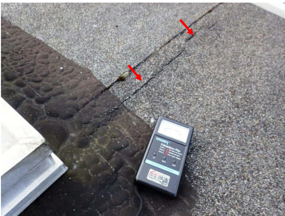
Figur 12 Tagfladen. Revnet tagpap (røde pile). Høje fugtniveauer registreret i tagfladen.
