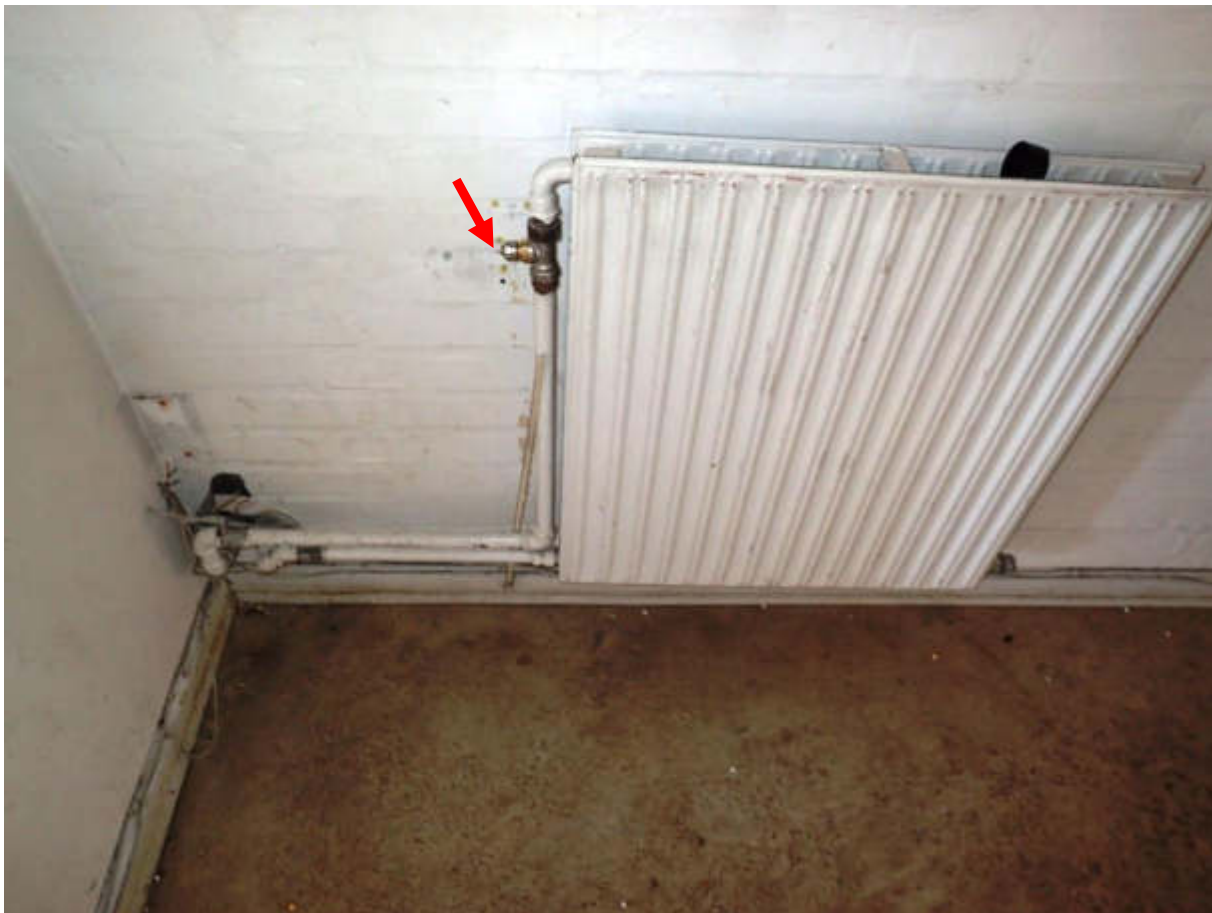
Figur 19 Radiator med manglende termostat (rød pil).
