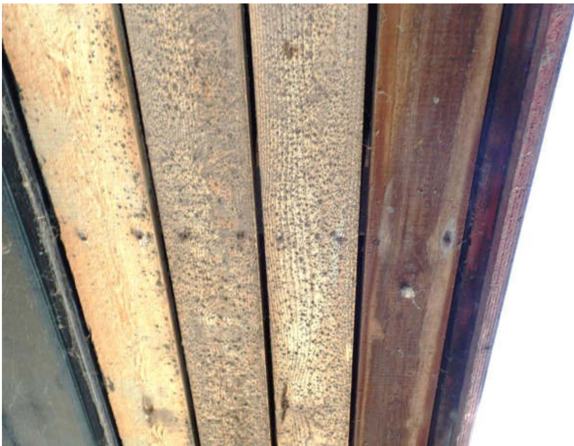
Figur 9 Udhæng mod øst. Synlig skimmelsvamp registreret på underbrædder.
