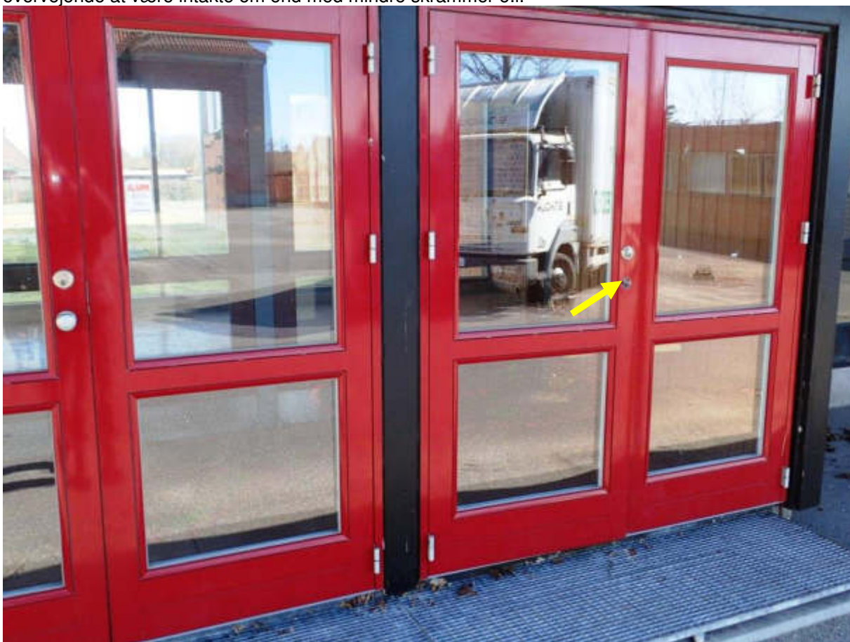
Figur 12 Facade mod vest /skolegården. Dørpartier af nyere dato. Dørmanglede greb og stod åben (gul pil).
