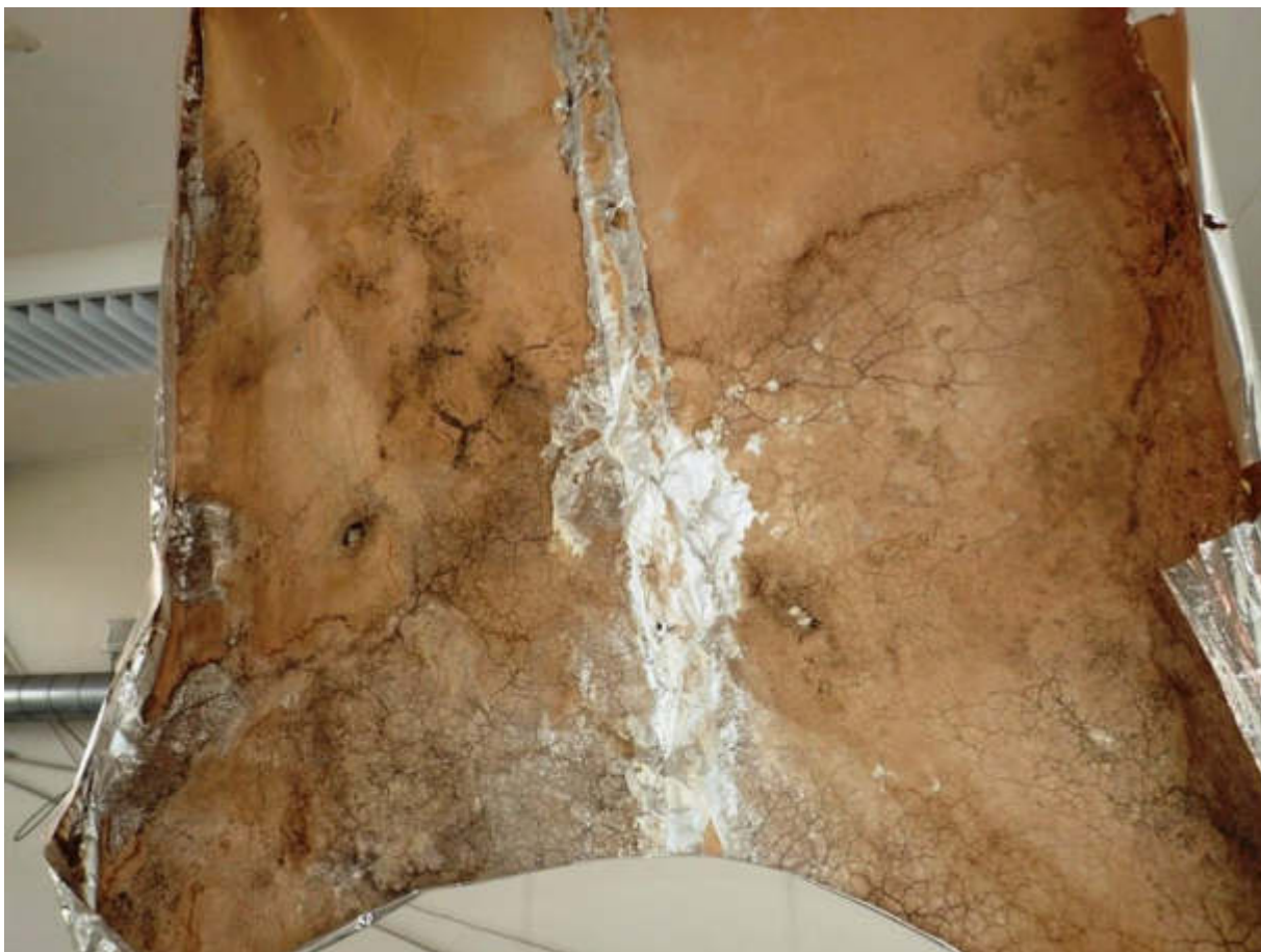
Figur 31 Undervisningslokalet mod øst. Væsentlige fugt og svampeskader registreret, her på nedhængende loftmembran.
