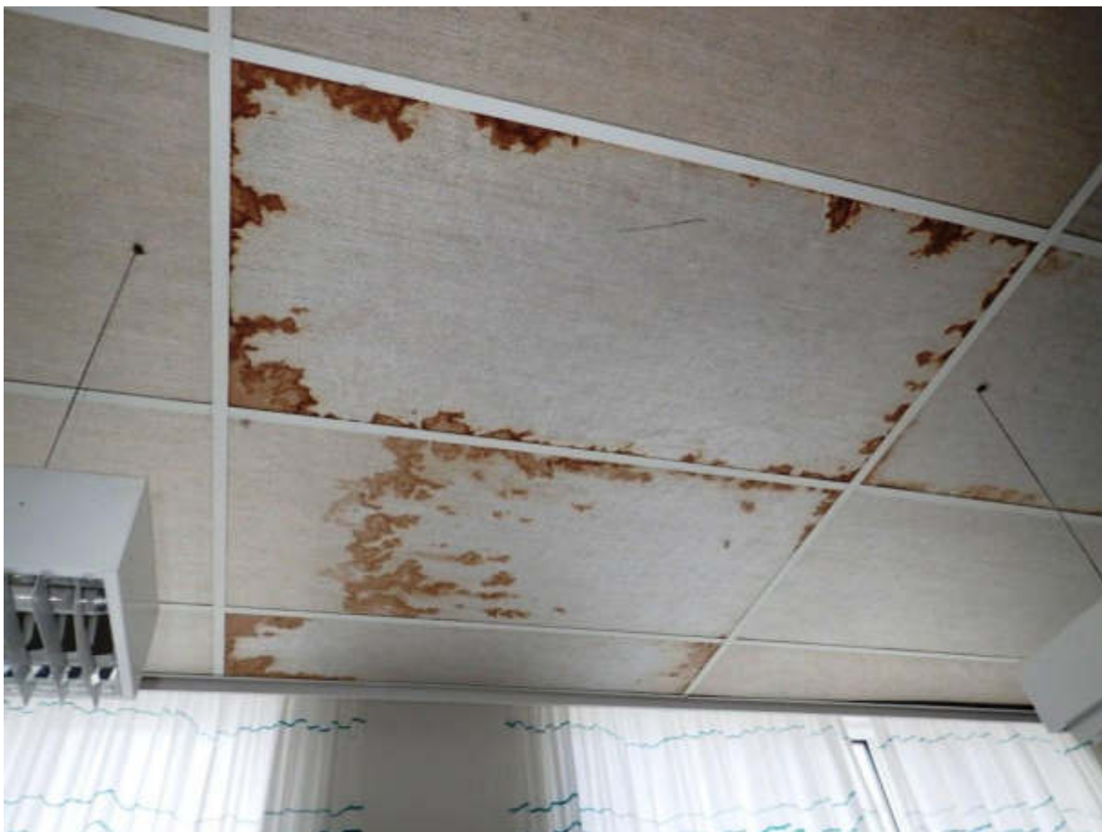
Figur 37 Klasseværelse i stueetagen. Skjolder på loftplader indikerer tidligere utæthed i installation.
