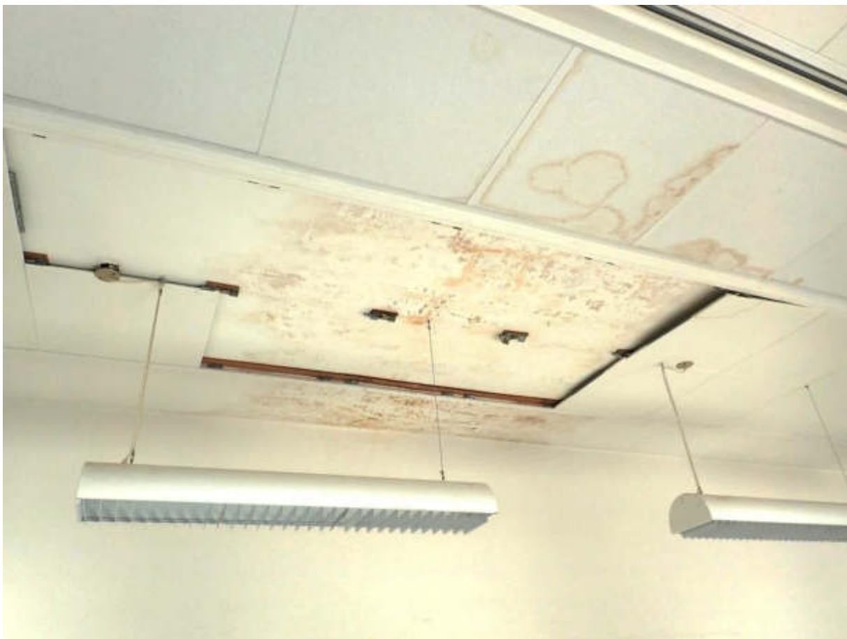
Figur 25 Undervisningslokale mod syd. Synlig skimmelsvampevækst og skjolder på loftet indikerer utætheder i taget.
