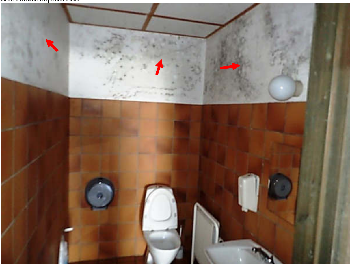
Figur 38 Toilet. Opfugtede konstruktioner med massive synlige forekomster af skimmelsvampevækst. (røde pile).
