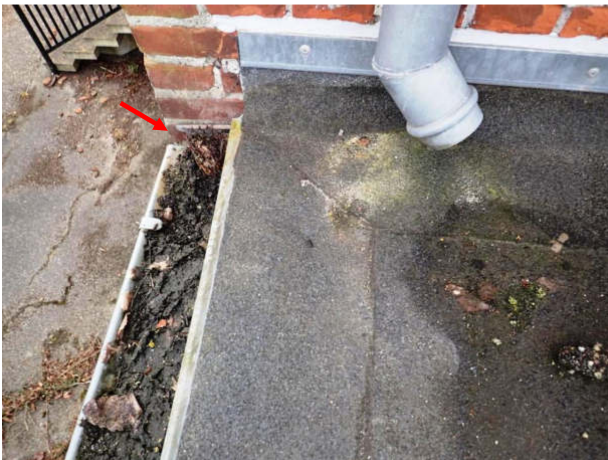
Figur 10 Tagflade på mellemlbygning med kontorer. Tagrende fyldt /stoppet. Murværk opfugtet hvor nedbør løber over (rød pil).
