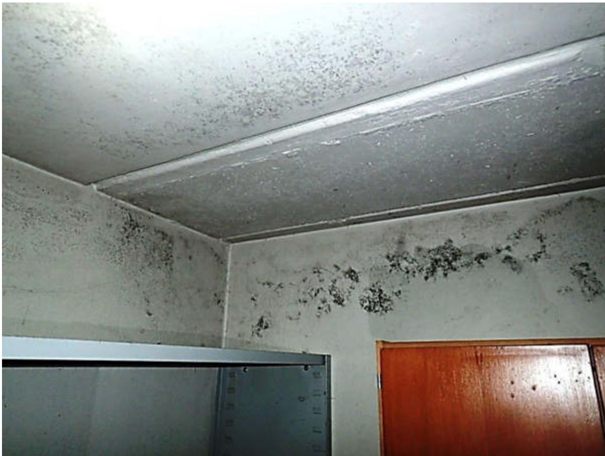
Figur 49 Kælderen. Synlige og massive forekomster af skimmelsvampevækst på vægge og loftet.
