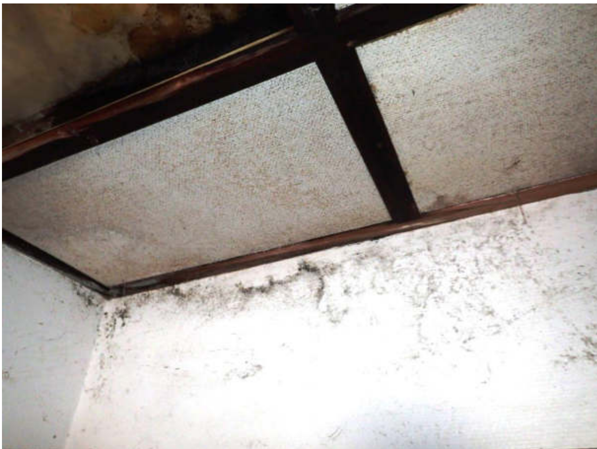
Figur 21 Skadet loft- og tagkonstruktion med opfugtede konstruktioner samt massive synlige forekomster af skimmelsvampevækst.
