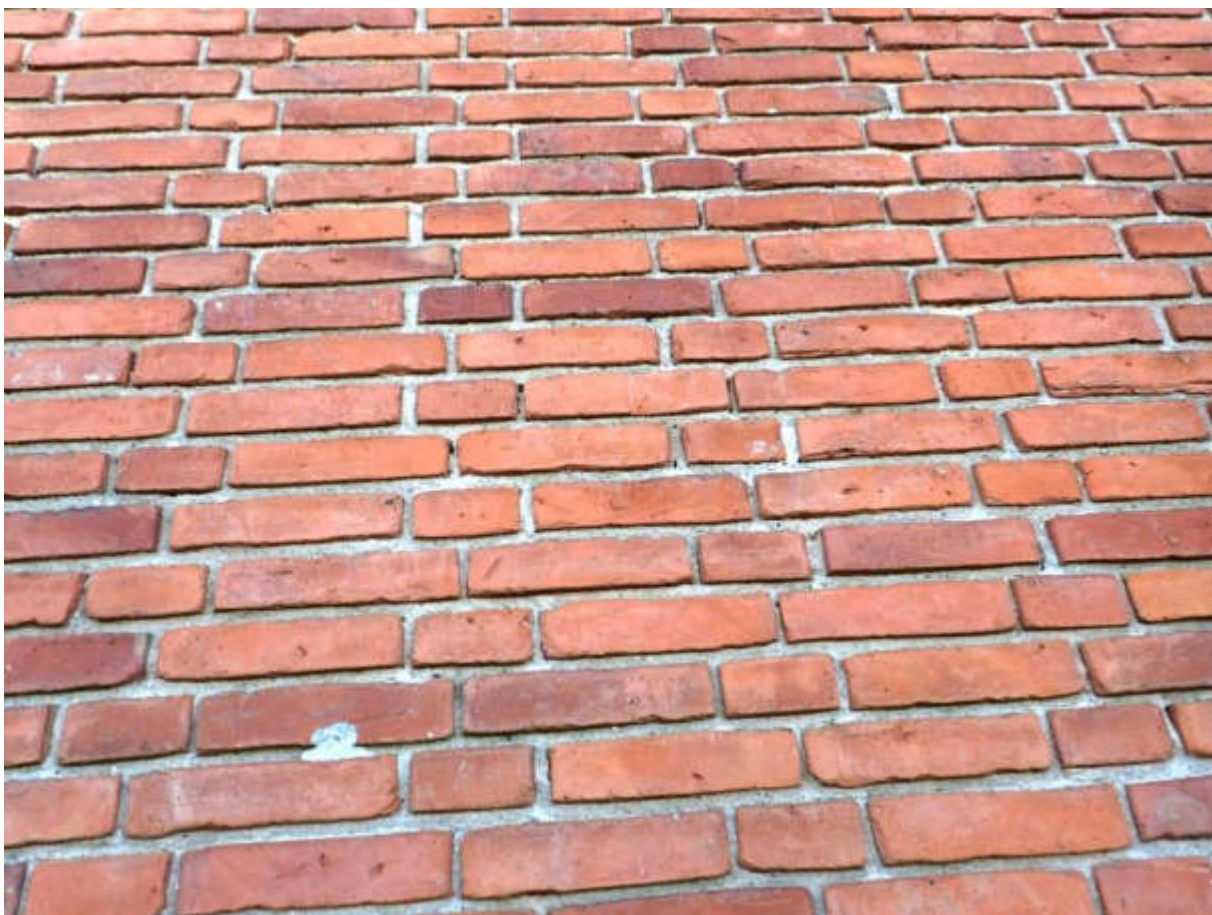
Figur 74 Facade mod nord. Murværk med manglende mørtelfuger /huller i studsfuger.
