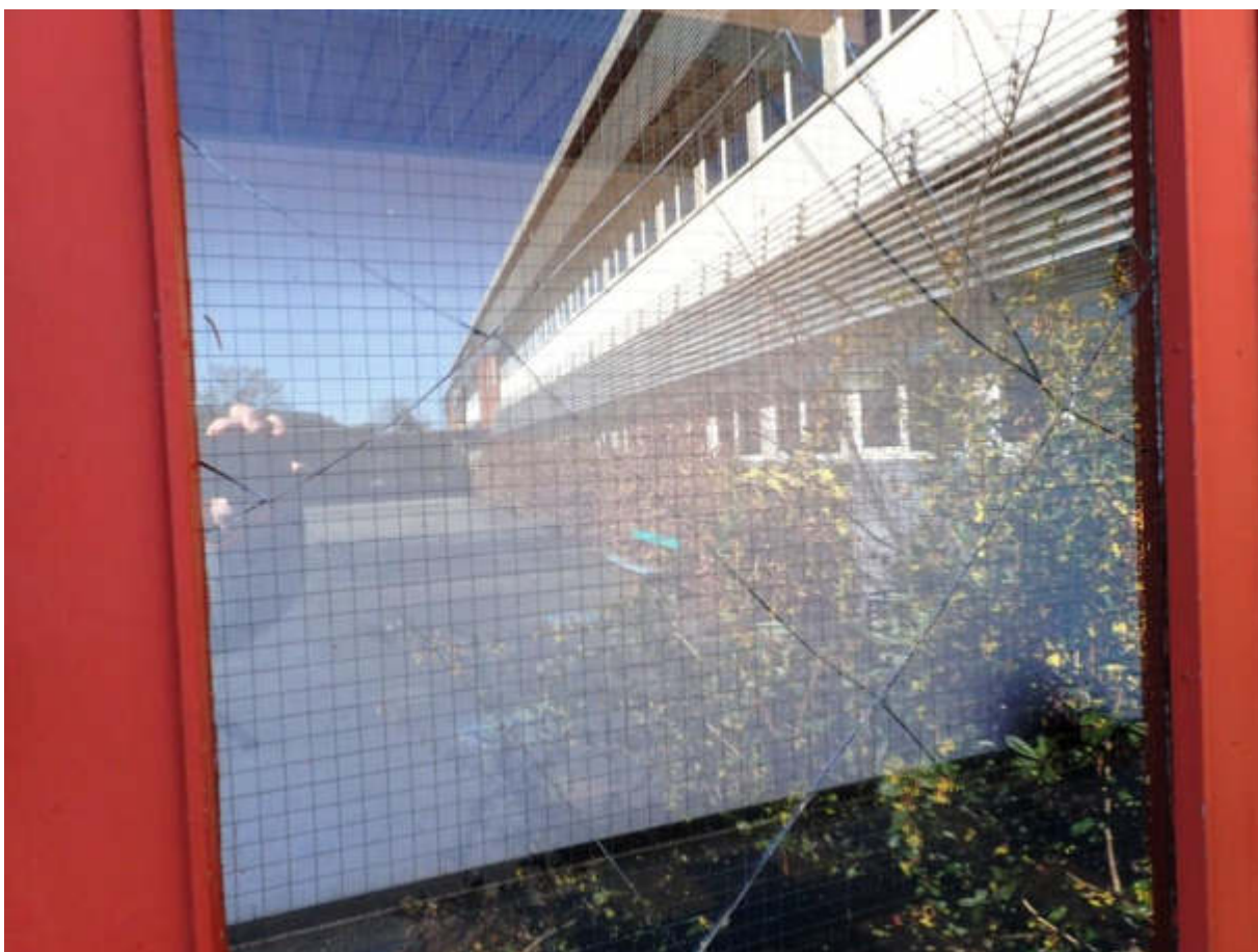
Figur 12 Mellembygning med kontorer. Facade mod øst. Smadret rude.
