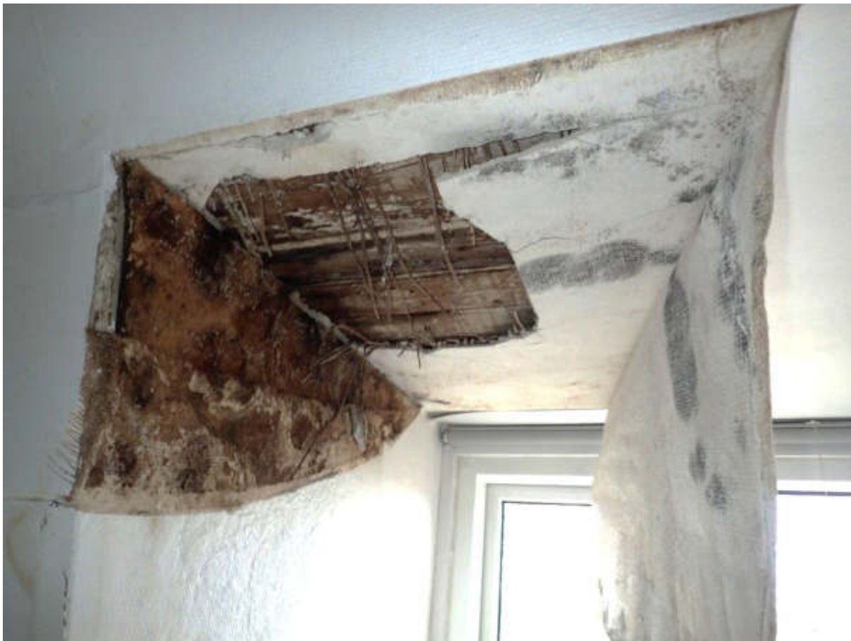
Figur 57 1.sal. Klasseværelse mod øst. Kvist med skade og massive synlige forekomster af skimmelsvampevækst.
