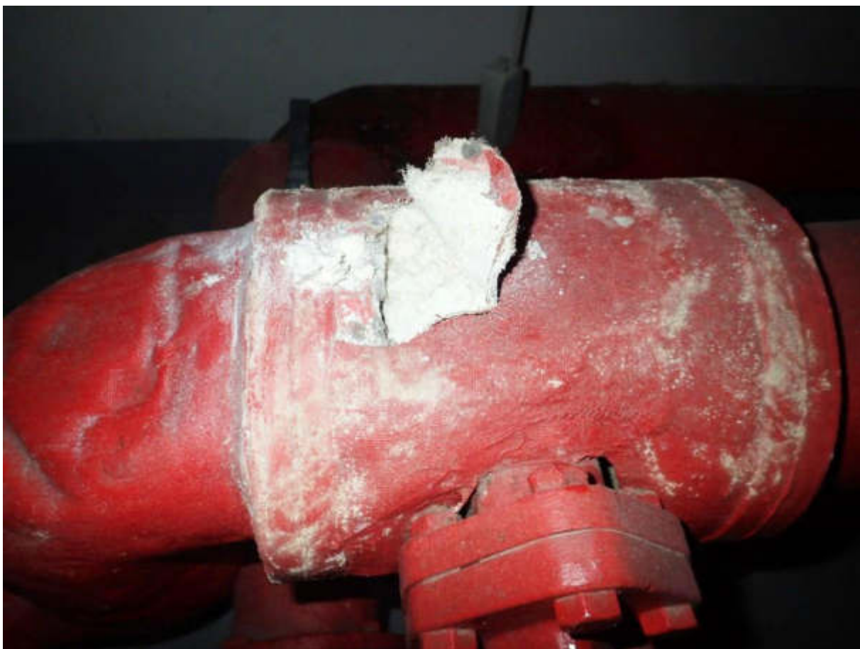
Figur 42 Kælderen. Rørinstallation med skadet rørisolering.
