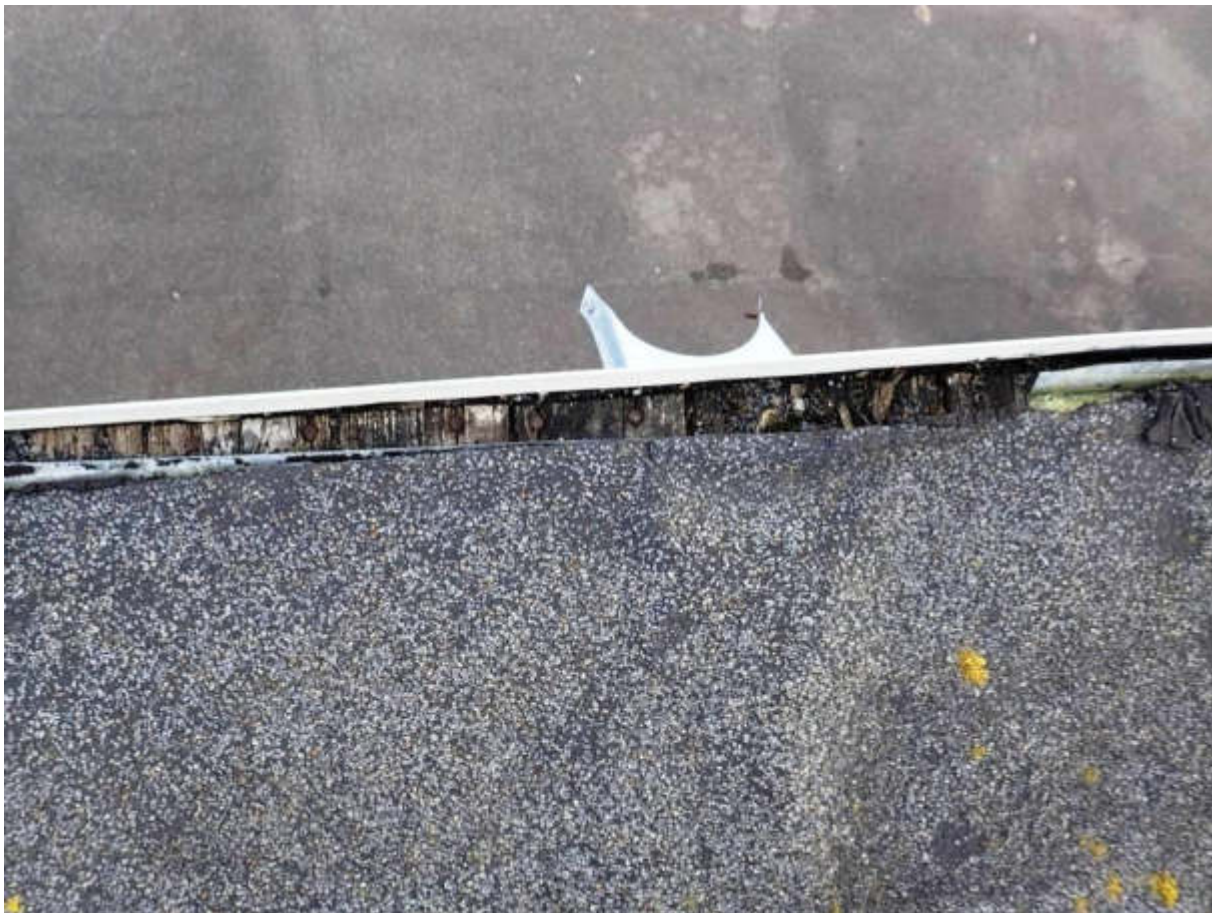
Figur 7 Tagfladen. Flosset og udtjent tagpap. Tagbrædder påvirket af hyppig fugt og med nedbrud.
