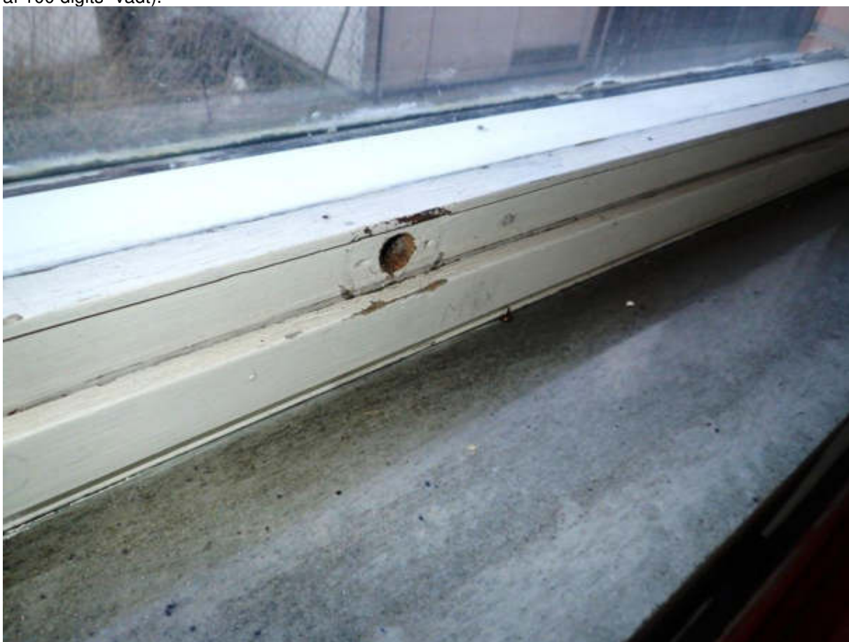
Figur 98 Gangen i stueplan. Flere steder manglede greb på vinduer. Bemærk vinduer af ældre dato med koblede rammer.
