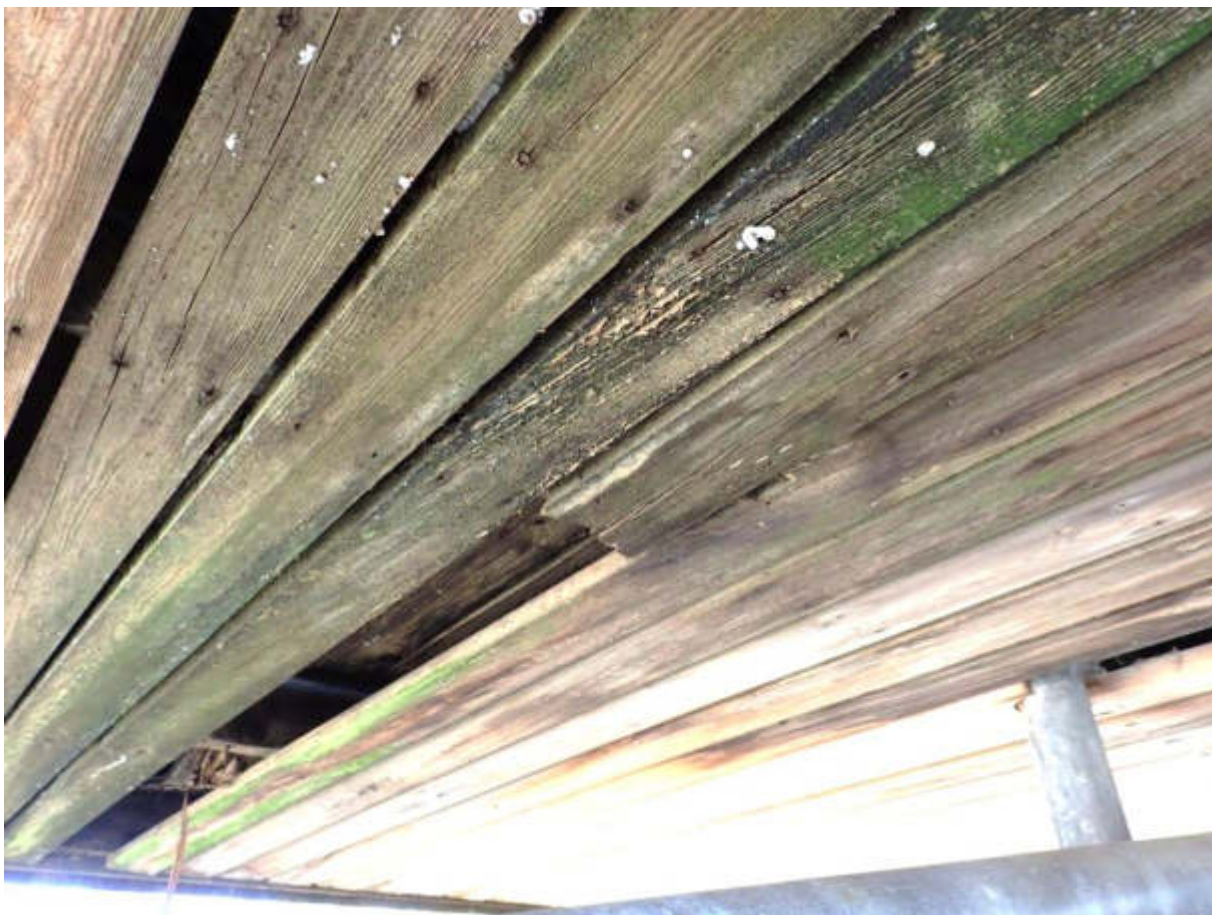
Figur 27 Cykeloverdækninger mod syd med skader og forfald. Indikationer på utæthed i tag.
