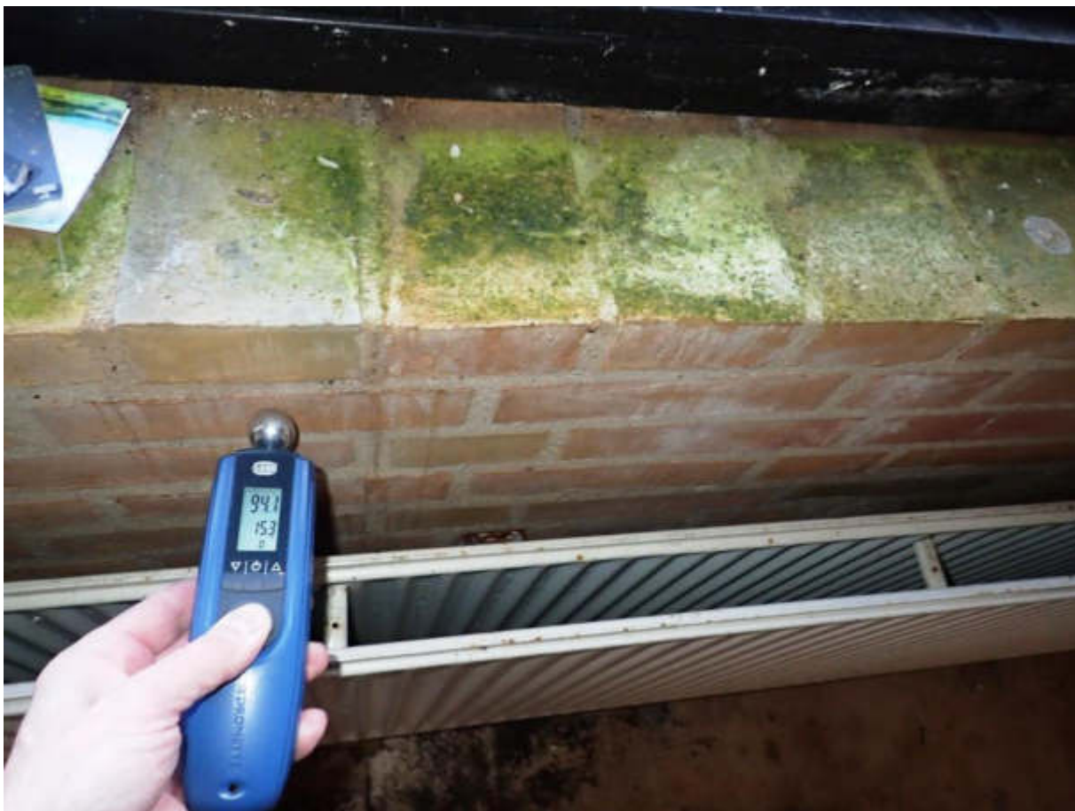
Figur 29 Opfugtede ydervægge med alger (ca. 94 ud af 100 digits -vådt).
