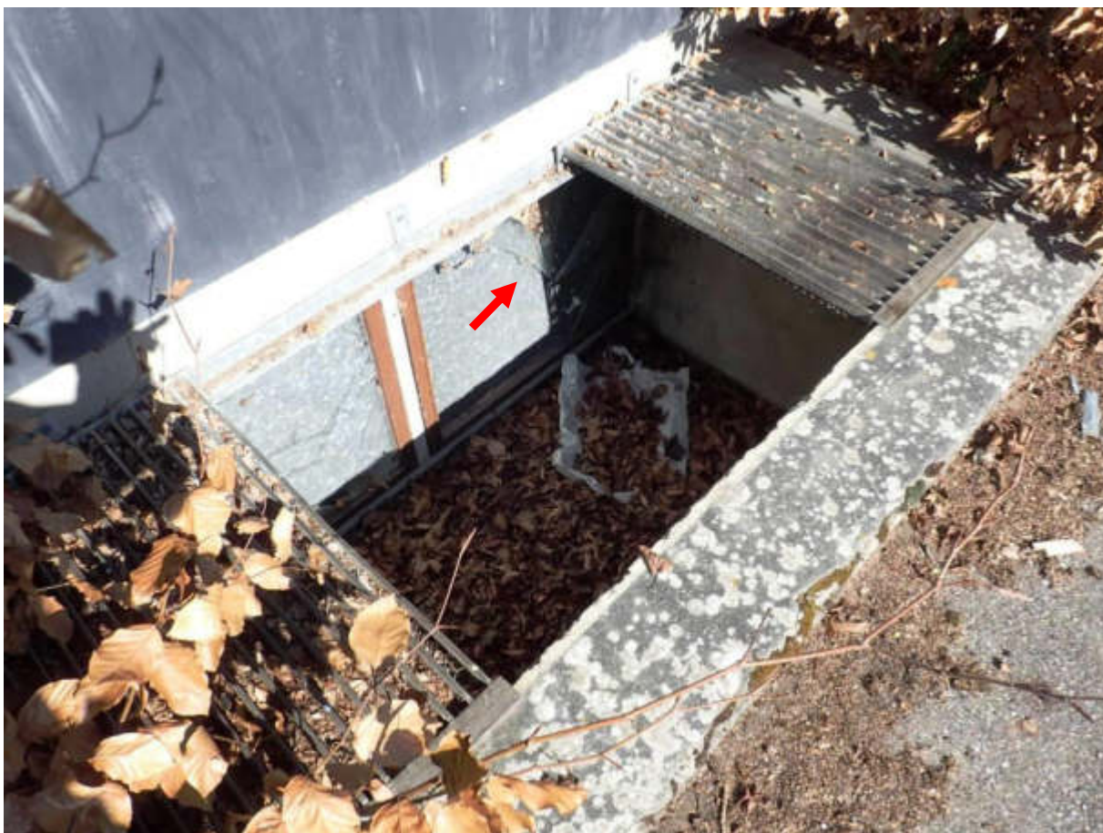
Figur 84 Facade mod syd /skolegården. Rist til lyskasse manglede enkelte steder. Kældervindue med smadret rude (rød pil).
