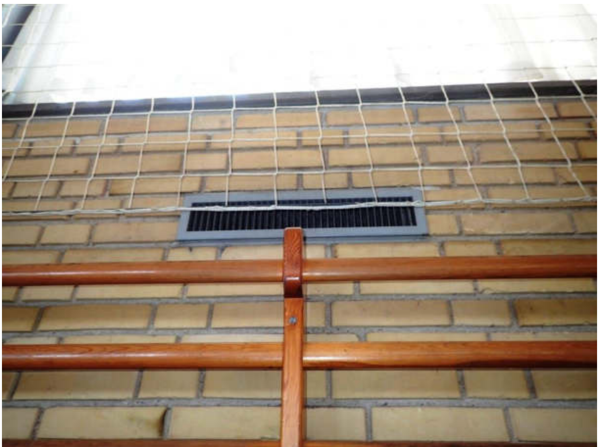
Figur 30 Gymnastiksalen. I vægge blev registreret adskillige ventilationsriste. Jfr. eksisterende tegninger er kanaler isoleret med 3 cm kork. Risiko for skjult skimmelsvampevækst.
