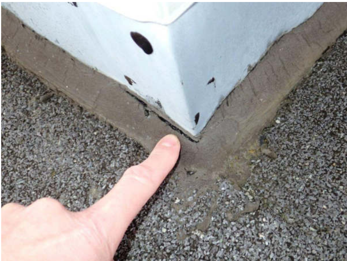
Figur 69 Taget. Nogle steder blev registreret revner i samlinger ved taghætter o.l. Risiko for indtrængende nedbør.
