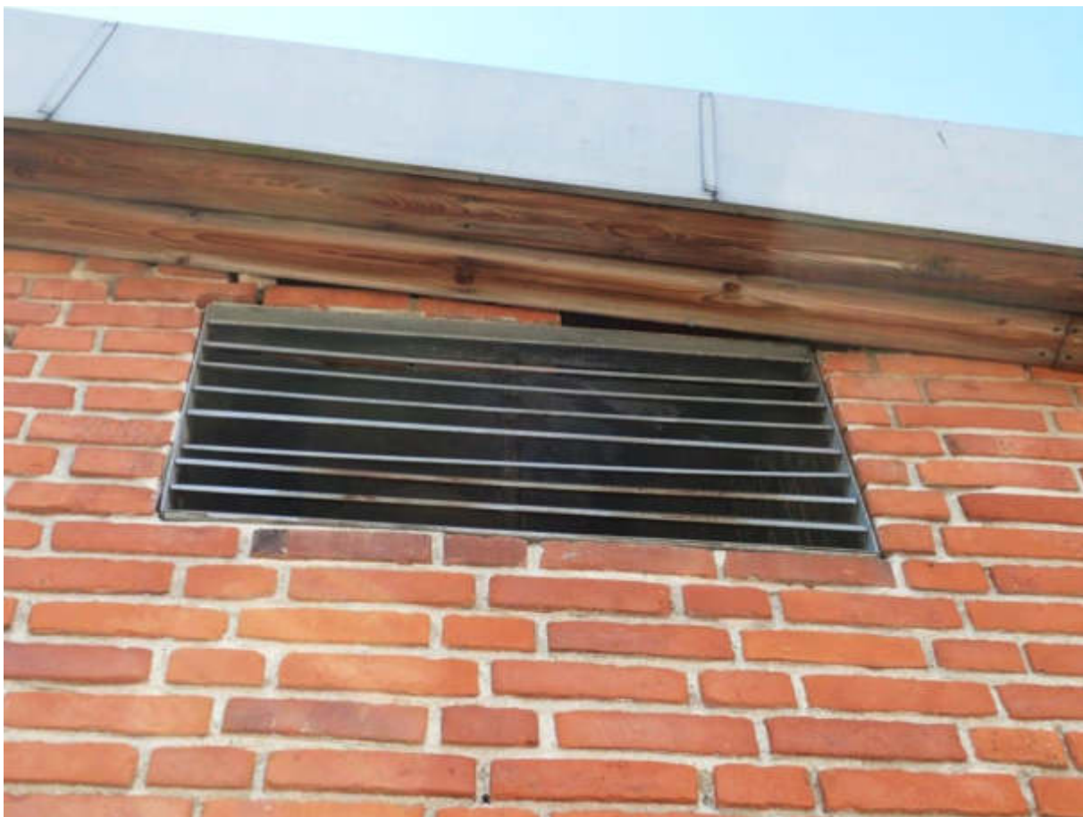
Figur 17 Ydervæg mod øst. Rist i murværk med tvivlsom tæthed nedbør.
