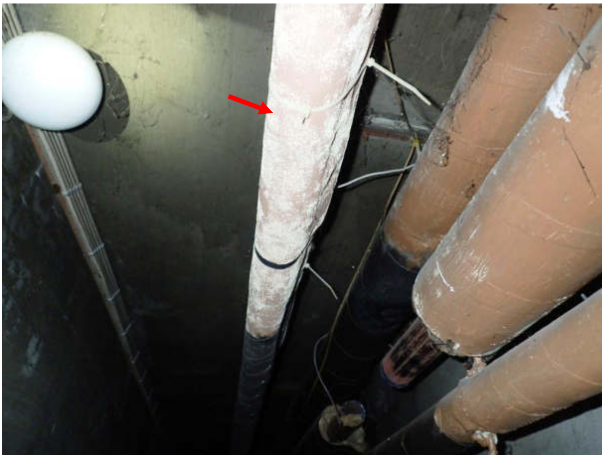
Figur 53 Kælderen. Synlige forekomster af, hvad der vurderes at være massiv skimmelsvampevækst på tekniske installationer (rød pil).
