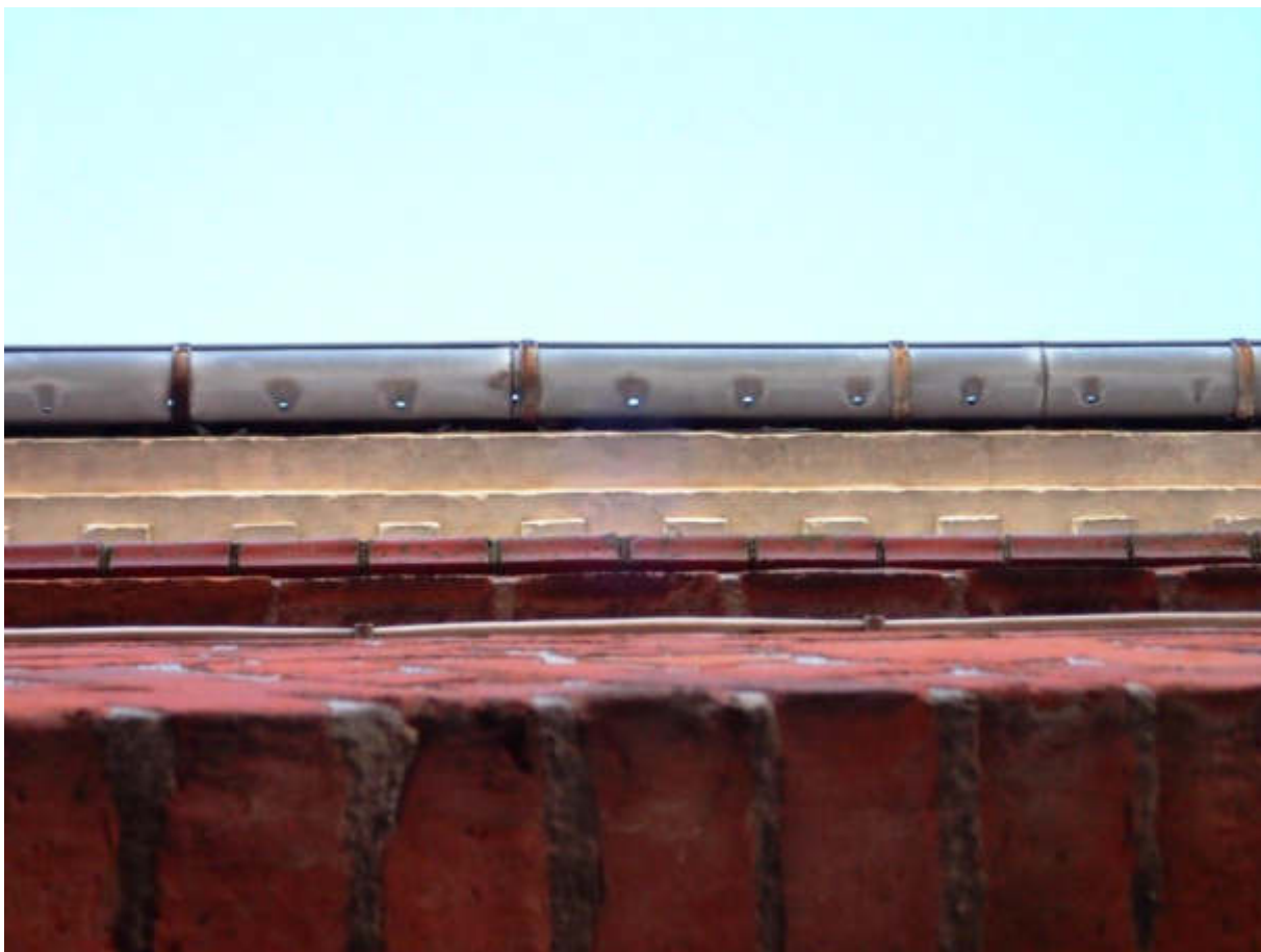
Figur 3 Facade mod nord. Tyndslidte tagrender med huller.
