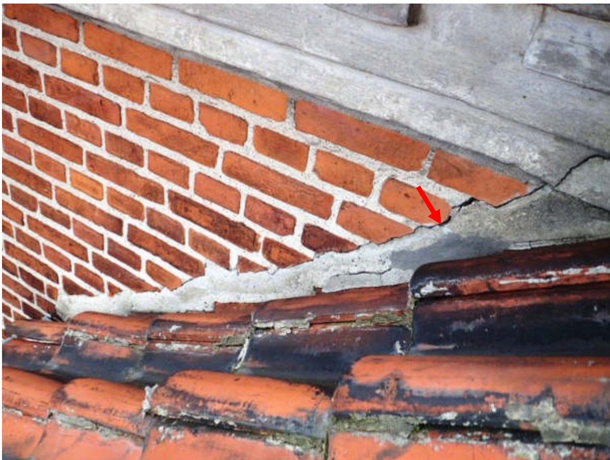
Figur 9 Tagflade mod syd. Revner i samling mellem tagdækning og murværk (rød pil).
