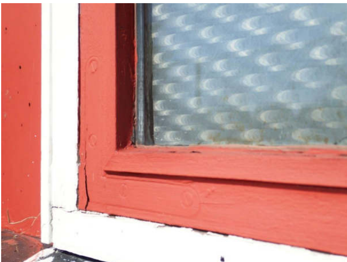
Figur 20 Facade mod syd. Vinduer af træ af ældre dato og almindelig termoruder.
