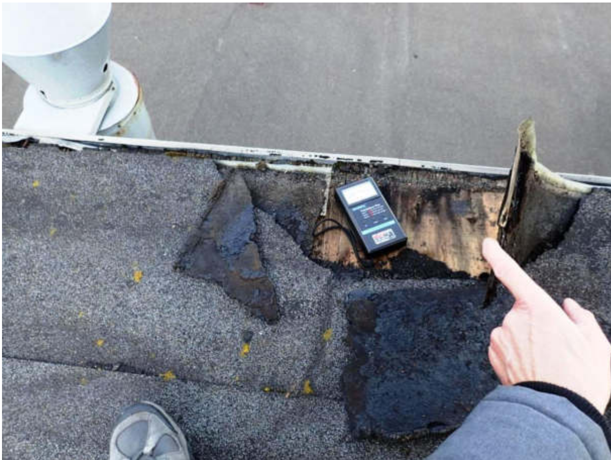
Figur 9 Tagfladen. Mørt og udtjent tagpap. Her ved sternkant mod øst. Bemærk opfugtede tagbrædder.
