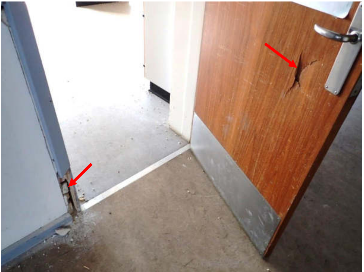
Figur 137 Dør mod skolekøkkenet med skader (røde pile).
