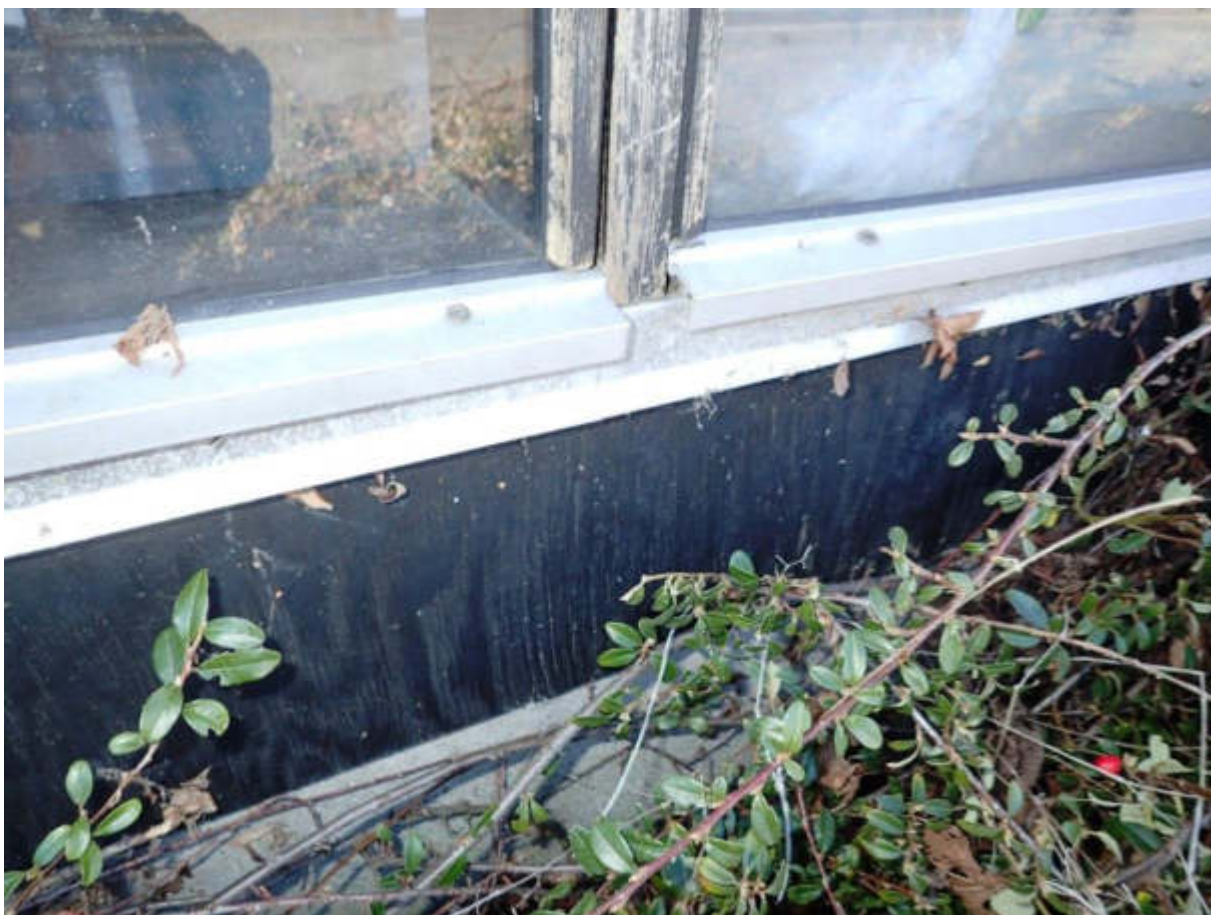
Figur 8 Mellemlbygning med kontorer. Facade mod øst. Vinduespartier med et lags ruder og træværk med ringe vedligehold.
