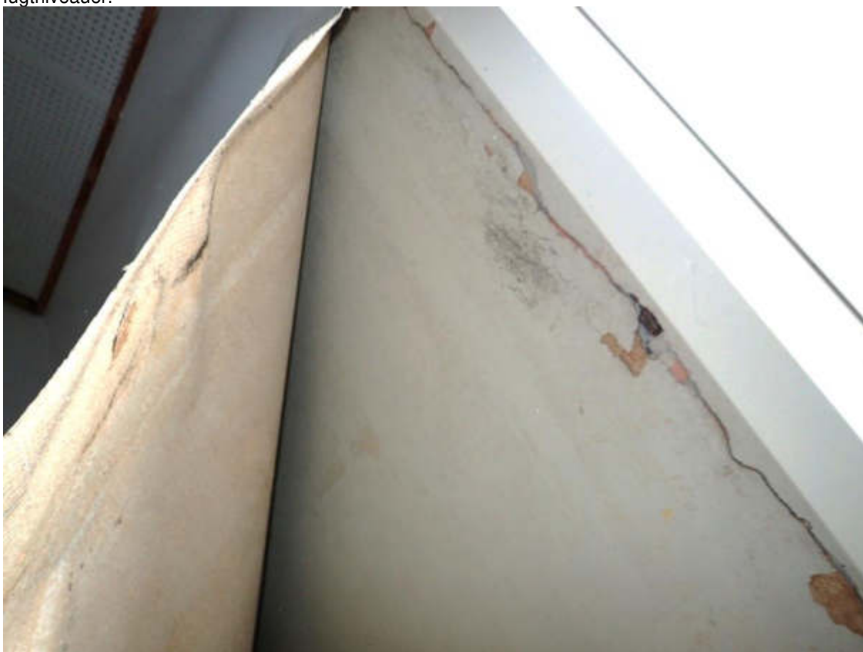
Figur 60 1.sal. Klasseværelse mod øst. Løst vægbeklædning med plamager af hvad der vurderes at være skimmelsvampevækst.
