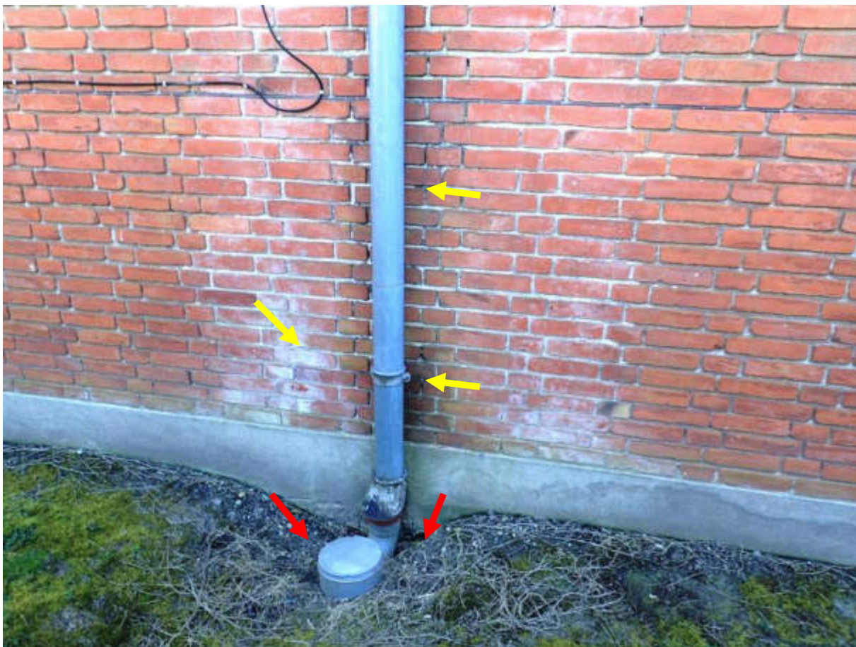
Figur 79 Facade mod nord. Nedløbsbrønd af plast. Bemærk sætning i terræn (røde pile) samt skjolder og skader på murværk (gule pile).
