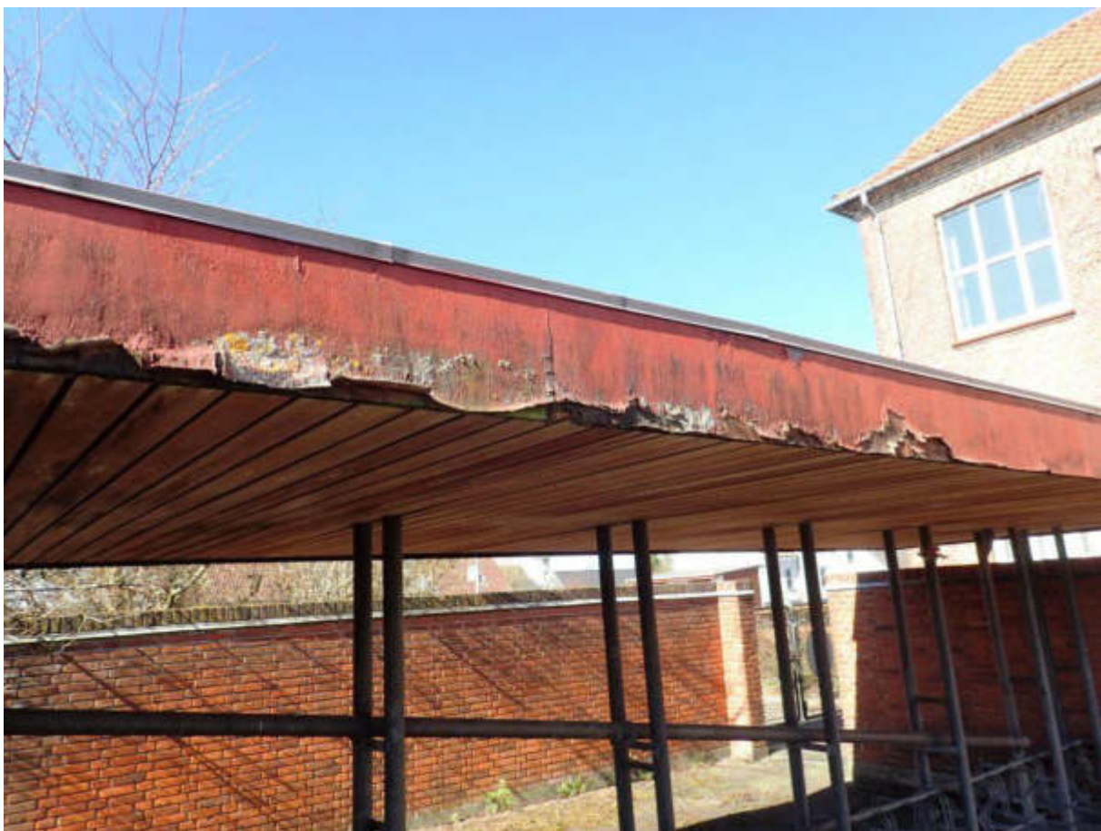
Figur 26 Cykeloverdækninger mod syd med skader og forfald.
