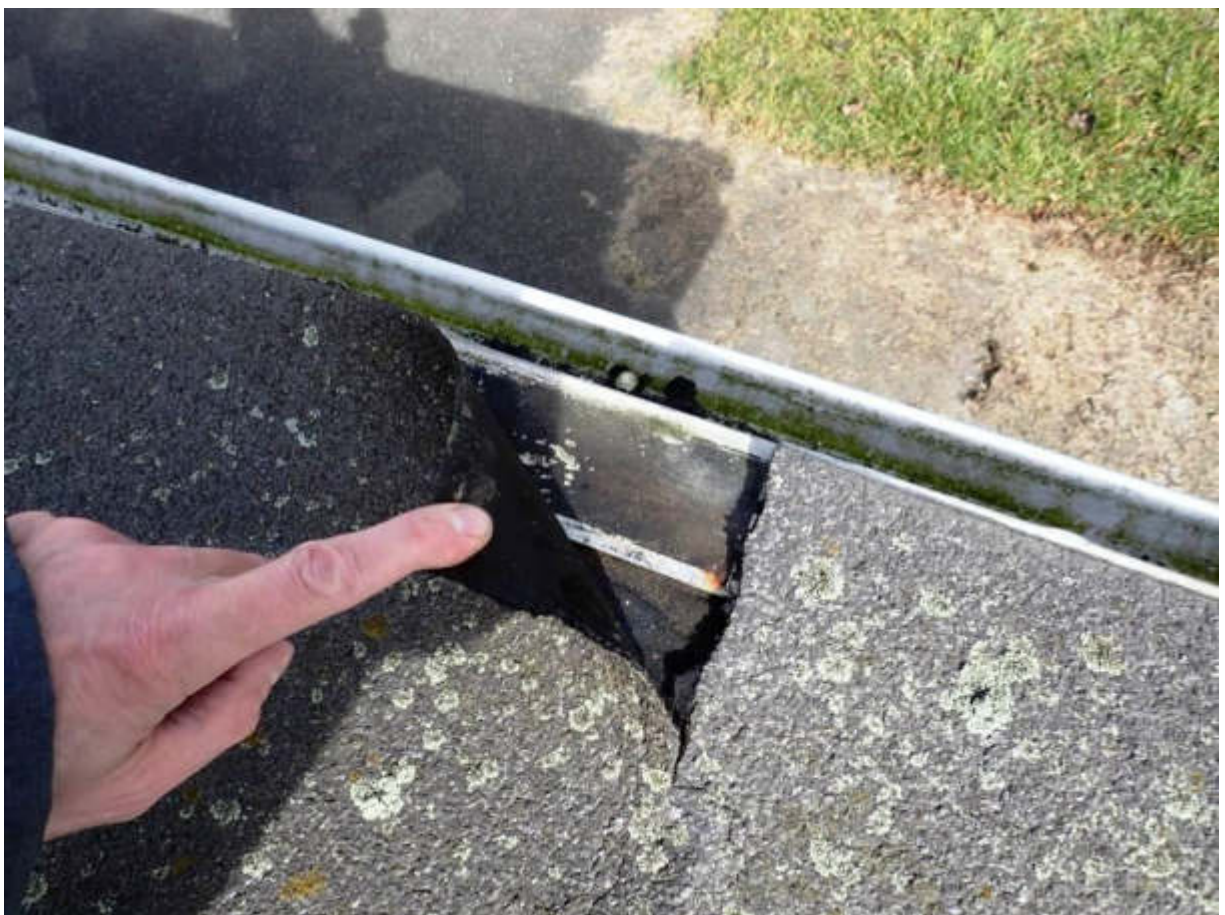
Figur 8 Tagflade over udhusbygning mod øst. Løst tagpap.
