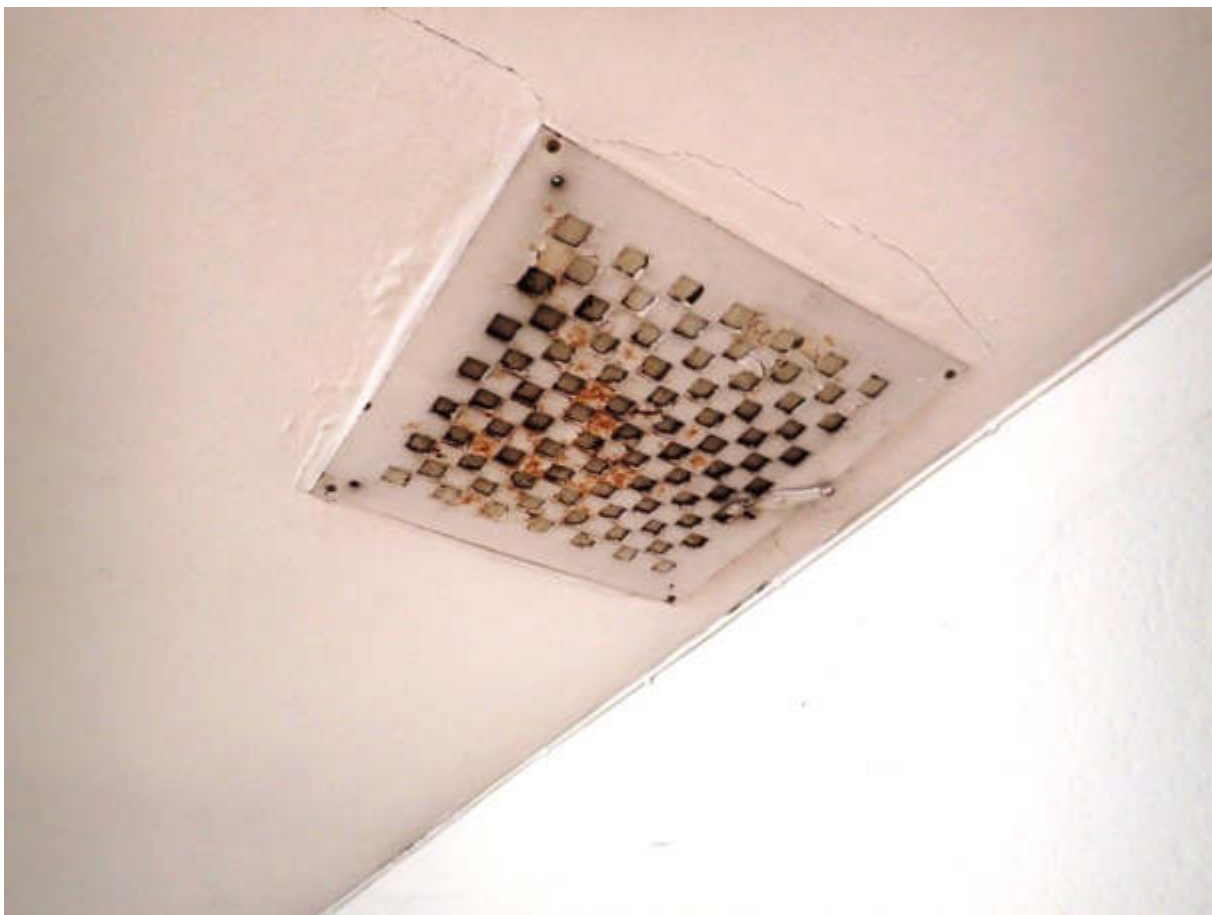
Figur 27 Mellembygning med kontorer. Riste i loftet af ældre dato med revner og korrosion samt tvivlsom funktion.
