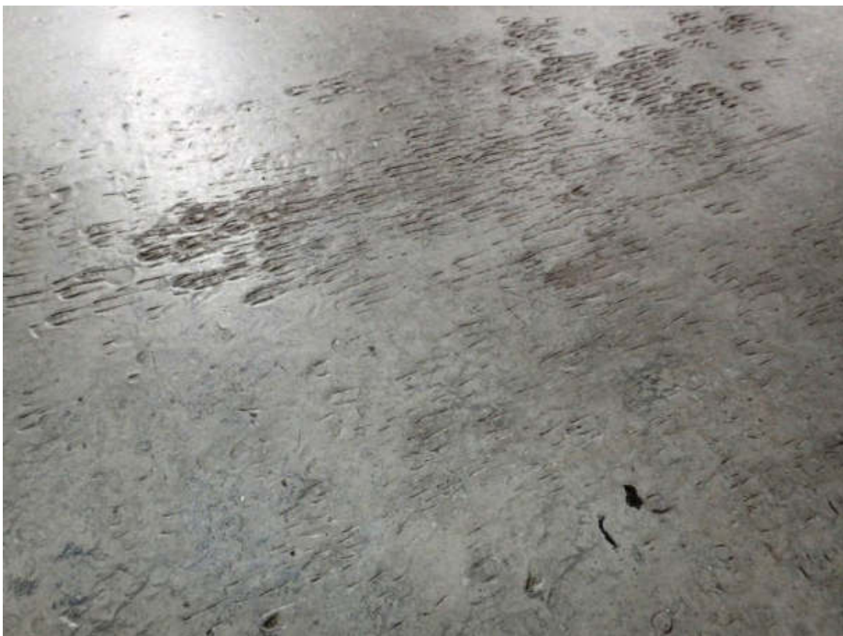
Figur 34 Gulvbelægninger med slitage og skader.
